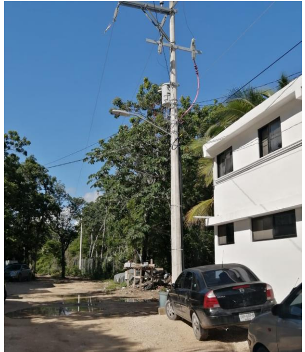
Cambio de luminaria led en la Col. Veleta
