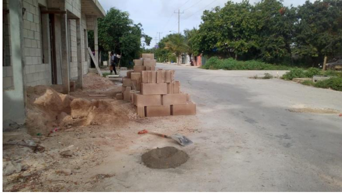
FOTO 1: Sanción por hacer caso omiso a notificaciones anteriores, donde se le solicita retirar material de construcción sobre la vía pública. Ubicado en la c. 27/ 12 y 14 mz 479, col. Tumbenka.
