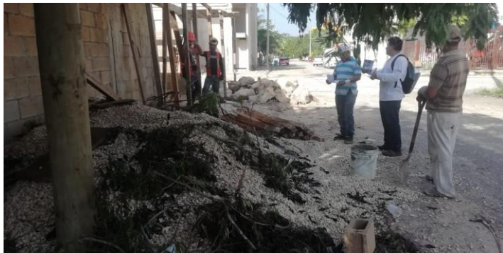
FOTO 3: Sanción por hacer caso omiso a notificaciones anteriores, donde se le solicita retirar material de construcción sobre la vía pública. Ubicado en la 23/12 y 16 mz 467 Tumbenka.
