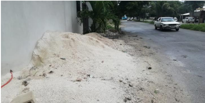
FOTO 1: Sanción por hacer caso omiso a notificaciones anteriores, donde se le solicita retirar material de construcción sobre la vía pública. Ubicado en la av. 2/c. 26 y 24, col. tumbenka
