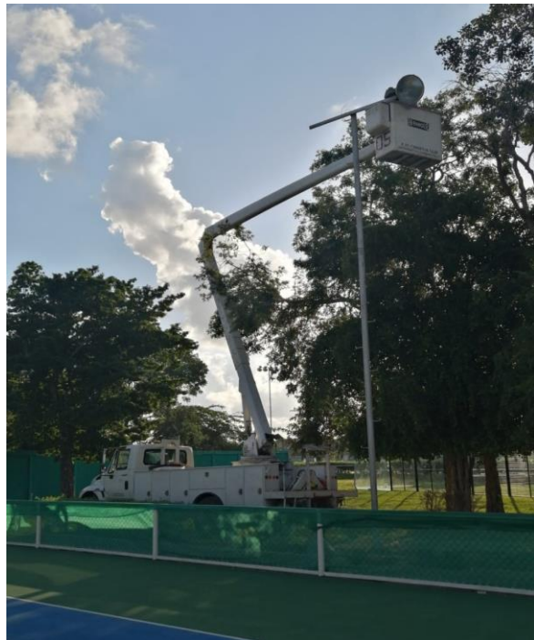
Rehabilitación de luminaria en la Unidad Deportiva
