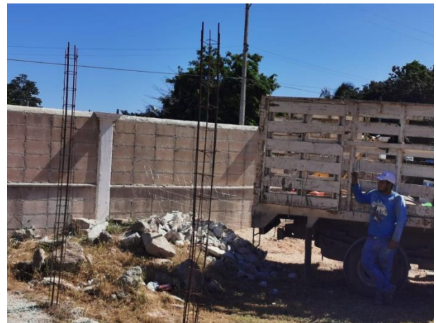
Escombros de la iglesia católica
