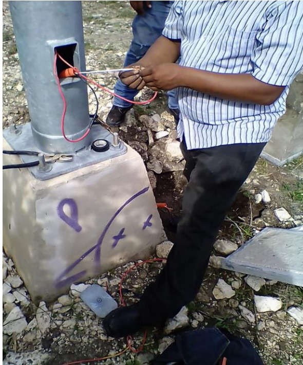
Corrección de corto circuito en el sector de la Av. Coba- Ciclovía
