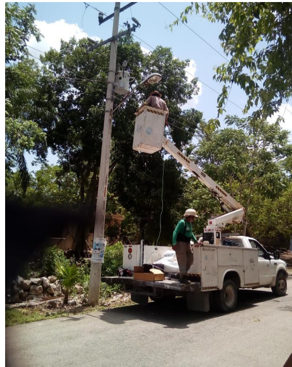
Rehabilitación de luminarias en la Comunidad de Chan Chen Palmar
