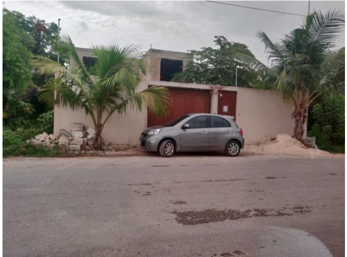
FOTO 2: Material de construcción tipo escombro y polvo sobre la vía pública, Av. la selva/zazil-ha y cocodrilo.
