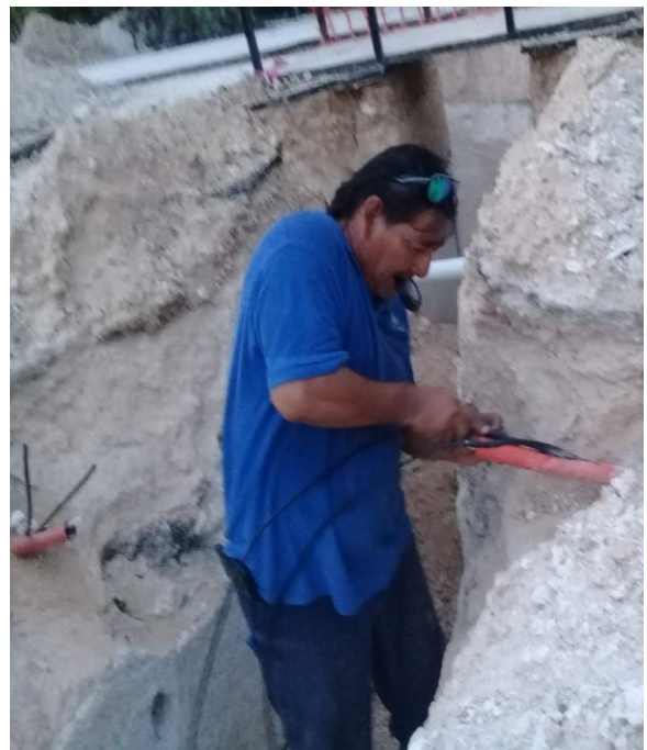
Empalme de líneas en la Colonia Xul -Ka
