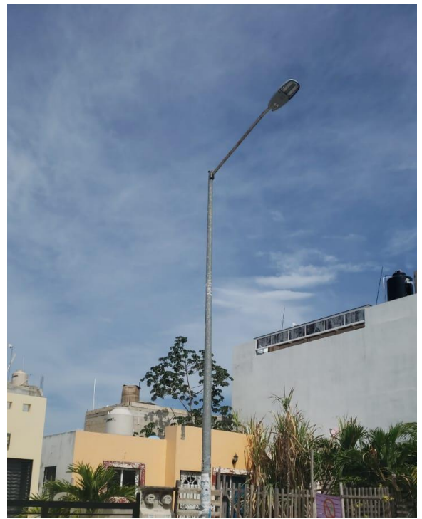
Cambio de luminaria led en el Fraccionamiento Guerra de Castas
