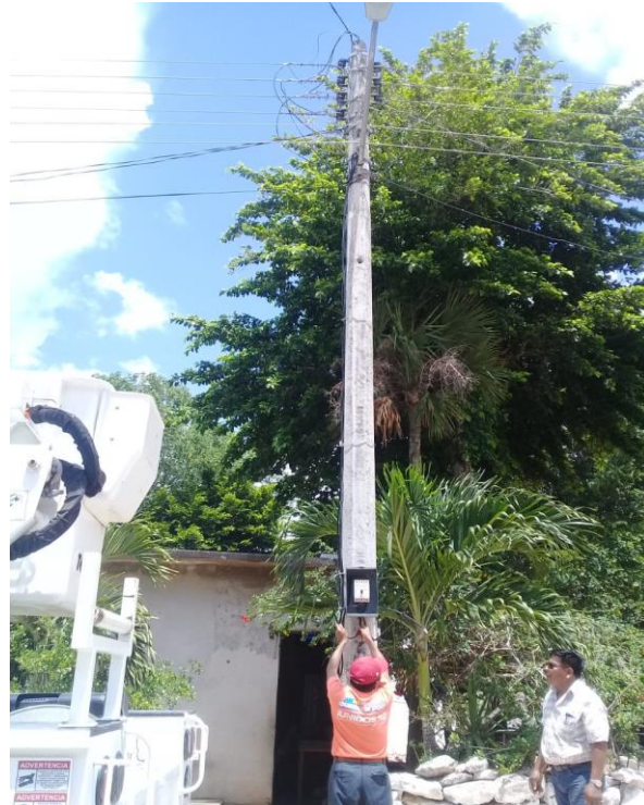
Instalación de interruptor para evento en la Comunidad de Chanchen 1
