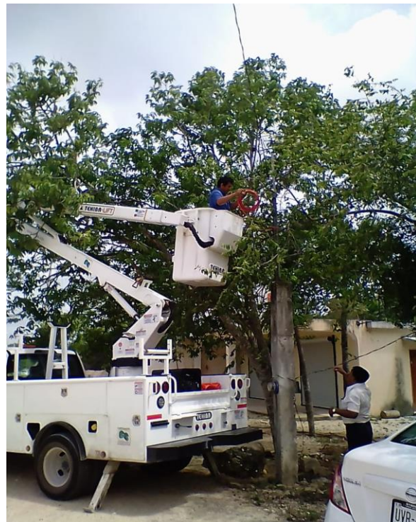
Conexión de bajante para módulo médico en la Comunidad de Macario Gómez
