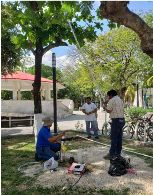
Instalación de sistema hidráulico de bomba sumergible en el parque 2 aguas de la colonia
