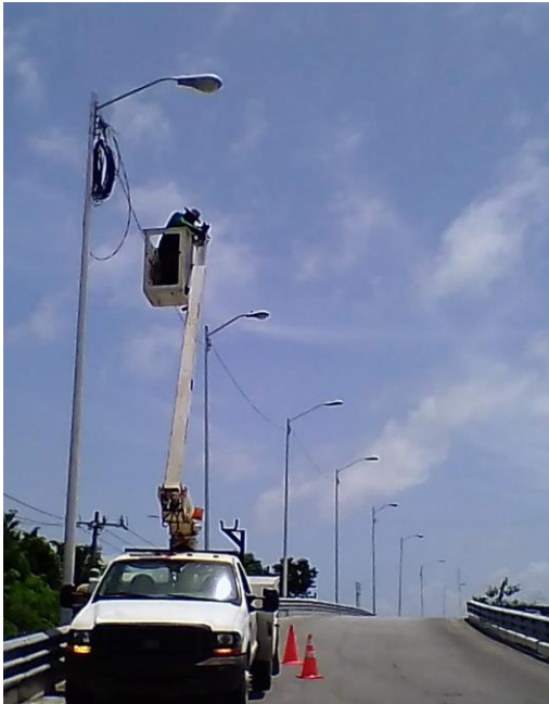
Tensión de líneas en el puente vial de la Comunidad de Chemuvil
