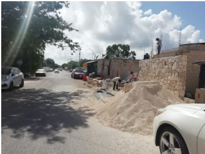
FOTO 3: sanción Por hacer caso omiso a notificaciones anteriores donde se le solicita retirar material de construcción tipo polvo y grava en la vía pública. c. 25/12 y 14 col. tumbenka
