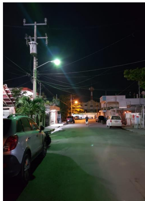
Rehabilitación de lámpara en la colonia Huracanes
