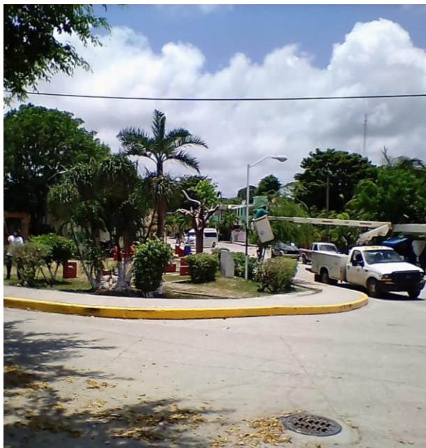
Instalación de reflector y poda de árboles en el parque del andador de la Comunidad de Chemuyil
