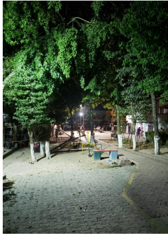
Instalación de reflector en el parque del andador de la Comunidad de Chemuyil
