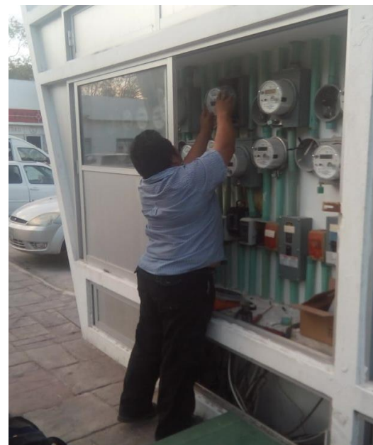
Se colocó interruptor de 2 x 25 amp. En apoyo a la Dirección de Desarrollo Urbano ubicado en la Av. Okot con Av. Coba
