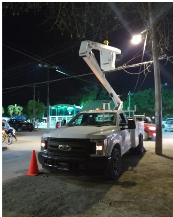
Se instaló un reflector de 1000 watts en la Cancha Maya.
