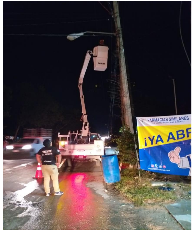
Se rehabilitó 1 lámpara en la colonia Ejido
