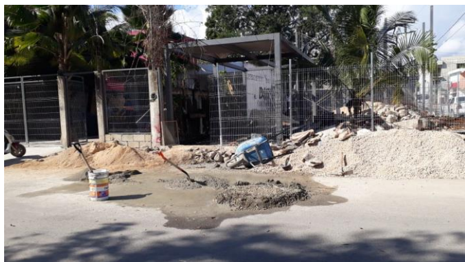
FOTO 7: notificación para retirar material de construcción que obstruye la vía pública, ubicado en calle asteroides entre av. satélite y géminis sur.
