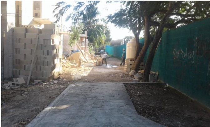
FOTO 1: sanción por ser sorprendido de manera flagrante en preparación y depósito de material de construcción tipo mezcla, polvo block en la vía pública, en la calle sagitario y 2 oriente.
