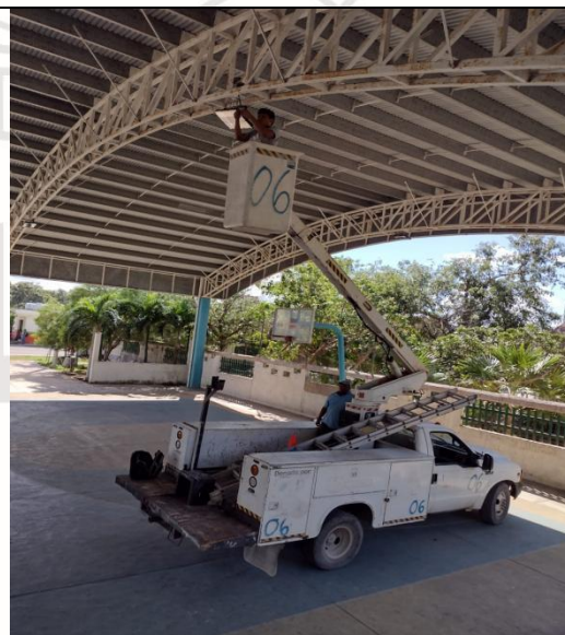
Se retiró las luminarias del domo del fraccionamiento Tumben Kah
