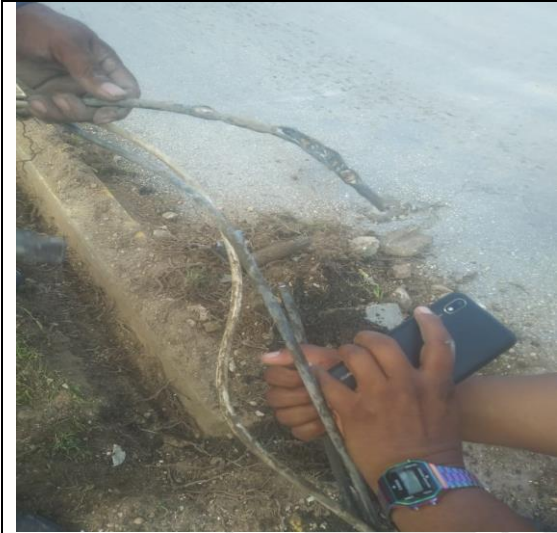
Se realizó reparación de corto circuito en líneas subterráneas en la avenida Tulum por calle Jupiter
