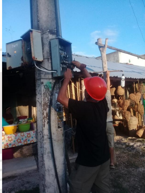
Se verifico y se dió mantenimiento a la base de medidor de la calle sol entre Osiris. Activando el sector de la calle Asteroide y Av Satélite
