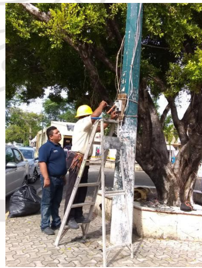
Se cambió centro de carga Q,2 en la calle Mercurio y Acuario, cancha Maya que dando en buen funcionamiento.
