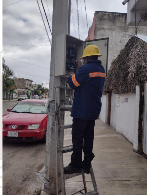
Se verifico sector apagado cambiándole filamento y canilla al transformador colonia Maya Pax calle Tunkul, entre Alfa y Omega Nte
