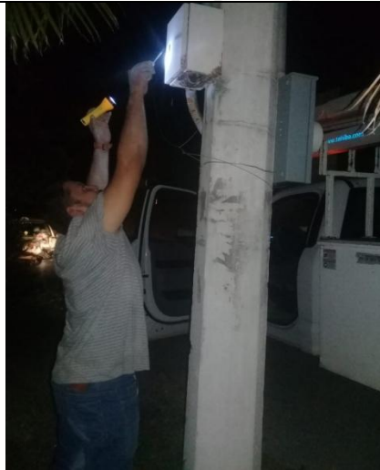
Sector apagado en colonia Ejido calle Cocodrilo y Chum Yam Che reseteo de interruptor
