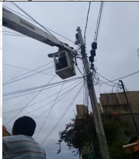
Se desconectó 2 Luminarias tipo sol de 1000 watts
