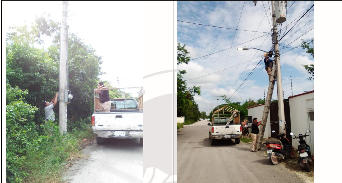
Se revisa sector apagado de alumbrado. Se detecta línea aérea sulfatada y se reconecta para activar sector. Calle Chanchen entre calle Zazil ha y calle Cocodrilo. Col Ejido
