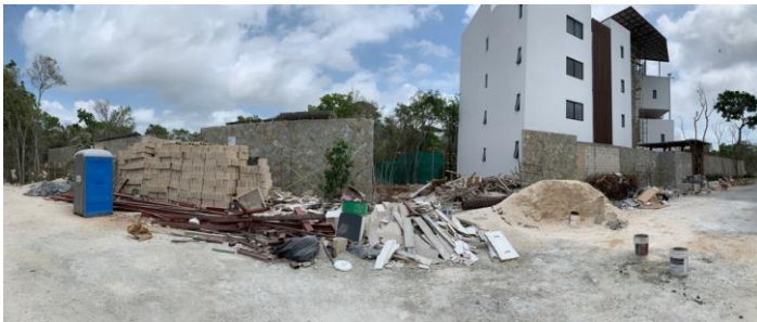
FOTO 7: Sanción por haber caso omiso a notificaciones anteriores, donde se le solicita retirar material de construcción,; c. 14 sur / c. 7 pte y 9 pte, col. Veleta edificio yaxlum.
