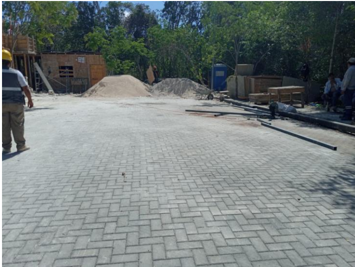
FOTO 1: Sanción por haber caso omiso a notificaciones anteriores, donde se le solicita retirar material de construcción sobre la vía pública: c. ixinche/kabah aldea zama
