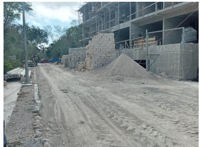
FOTO 5: Sanción por haber caso omiso a notificaciones anteriores, donde se le solicita retirar material de construcción,: c. 15 / 22 y 20 sur mz 07 lt 2 solemn
