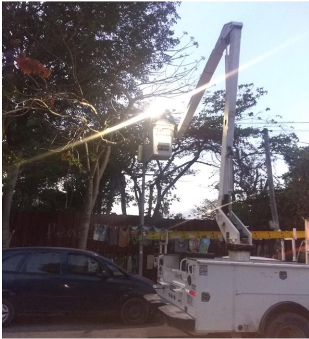
Rehabilitación de luminaria en la Calle Andrómeda esquina con Centauro Sur, Col. Centro
