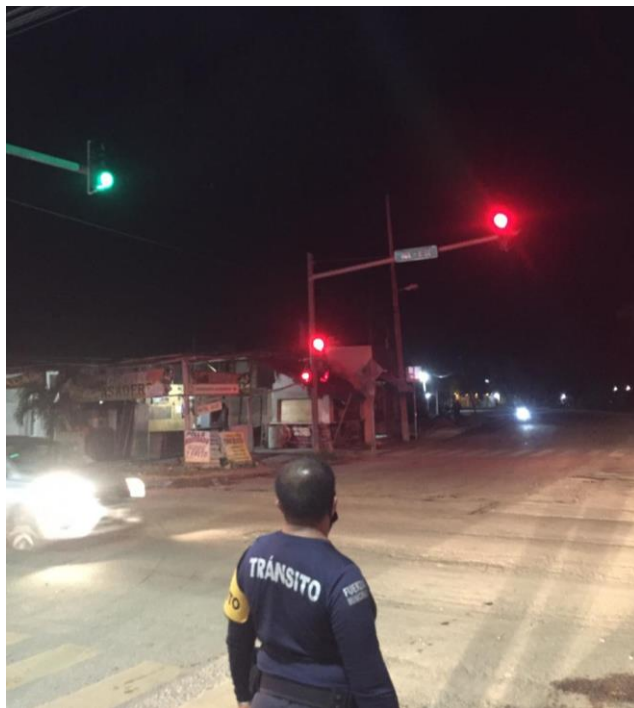
Conexión de semáforo que estaba apagado en la C. Ook-Kot, Col. Mayapax
