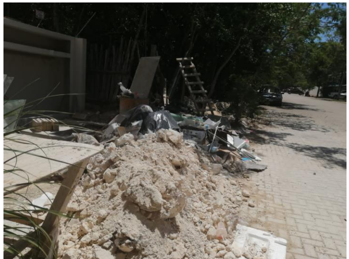
FOTO 3: Sanción por haber caso omiso a notificaciones anteriores, donde se le solicita retirar material de construcción, c. kinich ahau/c. kabah, mz 02, lt 06, Aldea Zama.
