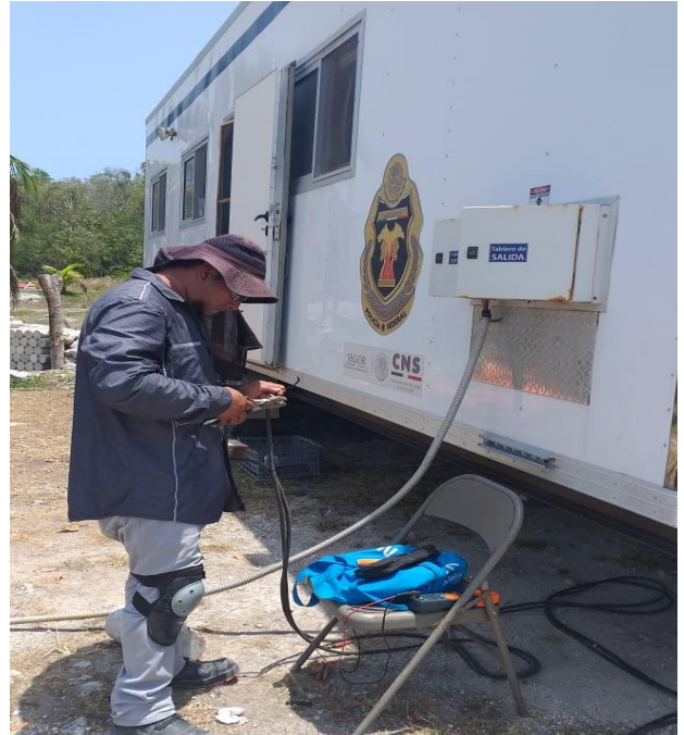
Conexión de líneas a los dormitorios en la base de la Guardia Nacional.
