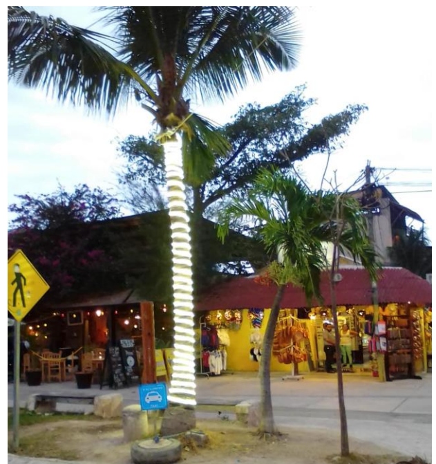
Conexión de bajante a 110V y colocación de manguera tipo leds en una palmera de coco de la Colonia Centro.
