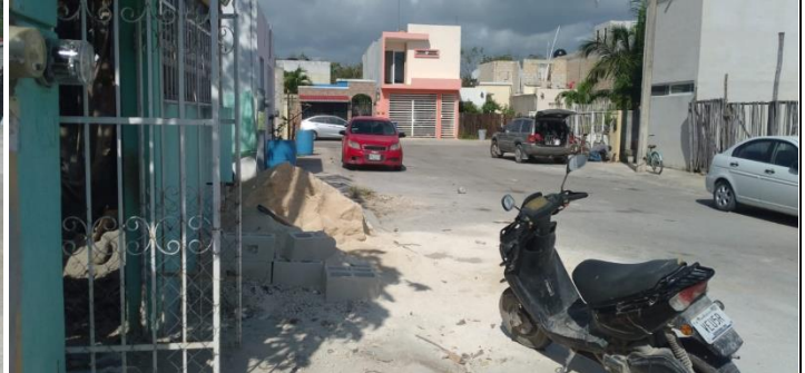
FOTO 6: Sanción por haber caso omiso a notificaciones anteriores, donde se le solicita retirar material de construcción,; c. 8 entre av. Tulum a un costado de la carretera federal a carrillo pto.
