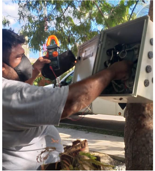
Instalación de multicontacto en la col. Guerra de Castas para la Caravana Ciudadana
