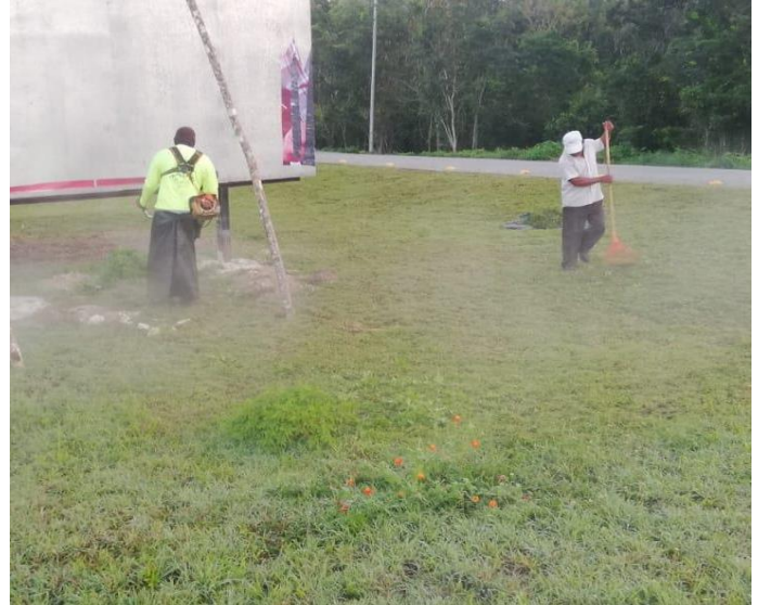
FOTO 02.- Poda y limpieza realizado en las áreas verdes de la glorieta hacia el poblado de coba
