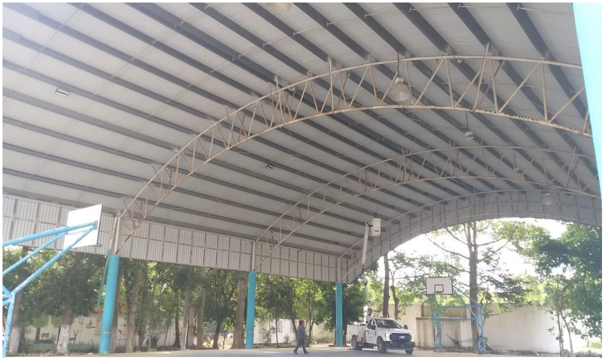
Cambio de reflector en el domo de la Comunidad de Chemuyil
