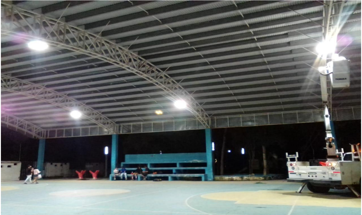
Cambio de reflector en el domo de la Colonia Tumben Kaa
