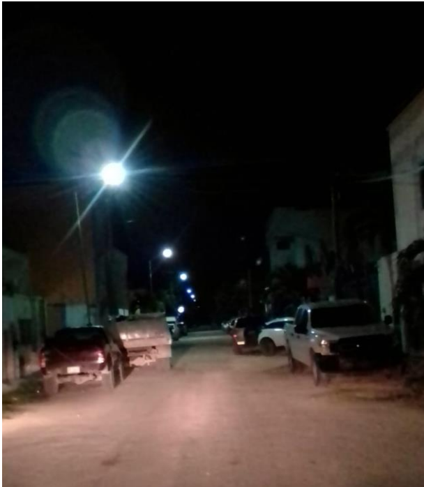
Rehabilitación de luminarias en la Colonia Tumben Ka
