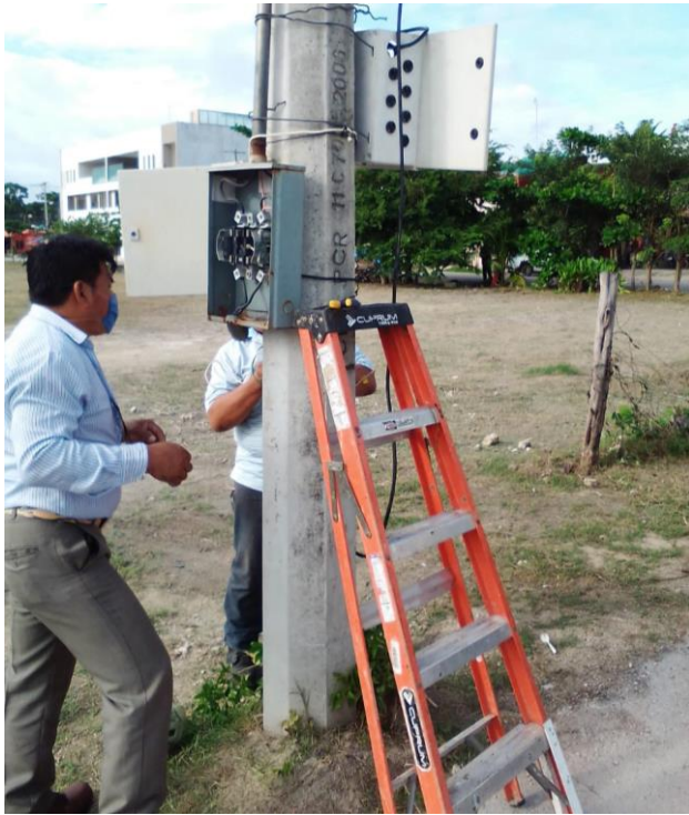
Instalación multicontacto en la colonia ejido para evento Caravana Ciudadana
