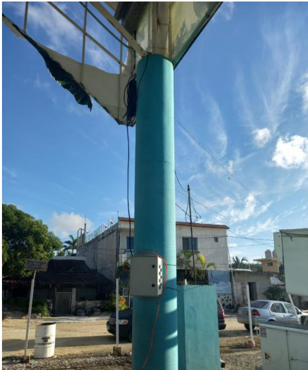
Instalación multicontacto en la Comunidad de Akumal para evento Caravana Ciudadana
