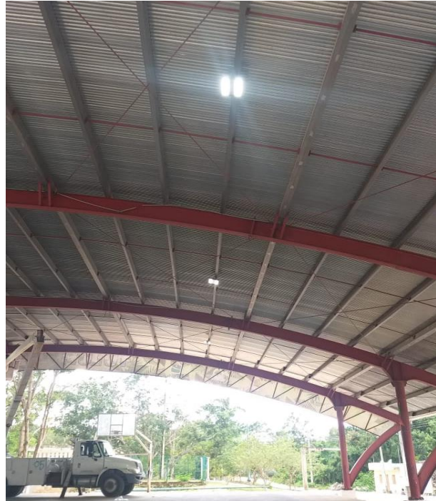
Cambio de reflector en el domo de la Comunidad de Francisco Uh May
