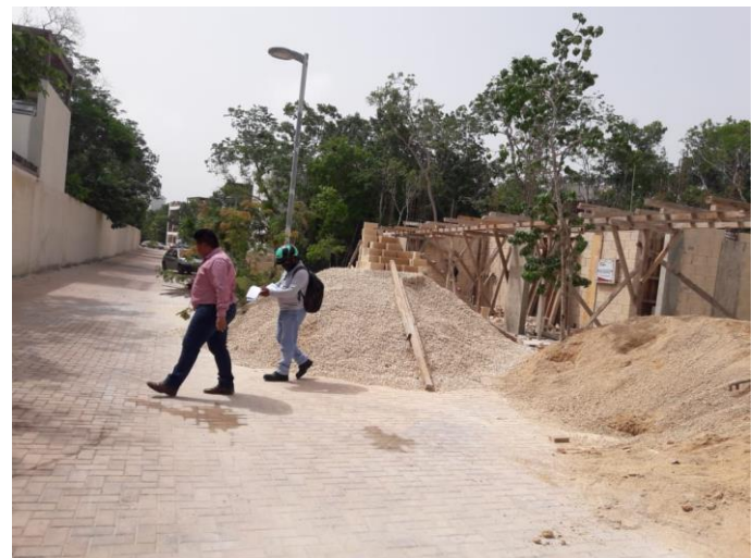
FOTO 4: Sanción por hacer caso omiso a notificaciones anteriores, donde se le solicita retirar material de construcción, Ubicado: c. privada/av. lxchel y av. itzamna, aldea zama.
