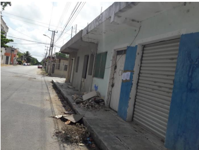
FOTO 3: Sanción por hacer caso omiso a notificaciones anteriores, donde se le solicita retirar material de construcción, Ubicado: c. géminis/ asteroides y av. satélite.
