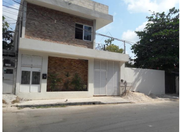
FOTO 2: Sanción por hacer caso omiso a notificaciones anteriores, donde se le solicita retirar material de construcción, Ubicado c. mercurio ote/av. satélite.
