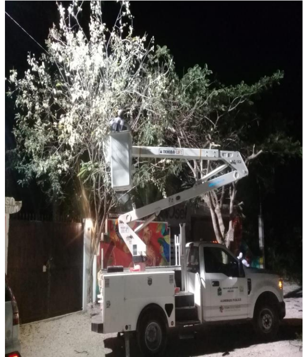
Reubicación de luminaria tipo sol en el filtro policiaco de la salida a Carrillo Puerto
