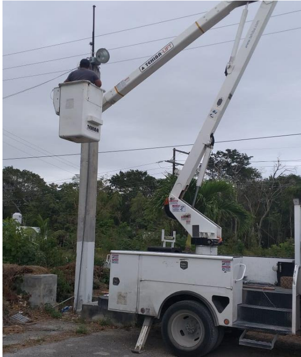
Rehabilitación de luminaria tipo sol en el filtro policiaco de la salida a Playa del Carmen
