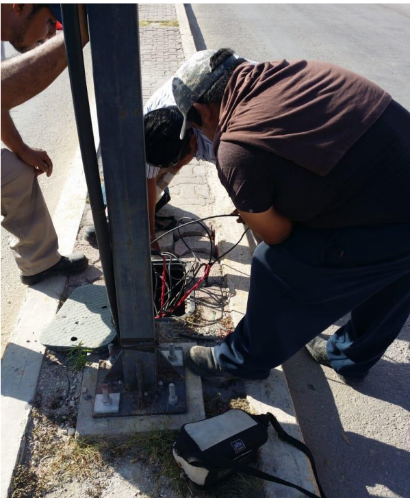
Corrección de corto circuito en la Colonia Centro
