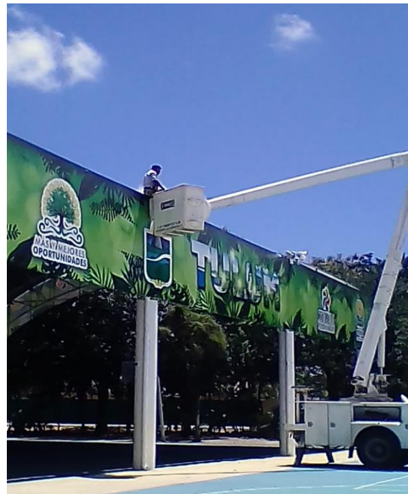
Revisión de corto circuito en el domo doble de la Unidad Deportiva
