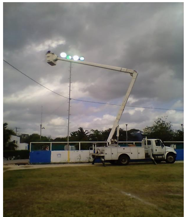
Rehabilitación de reflectores de 1000 watts en la Unidad Deportiva de la Colonia Luna
