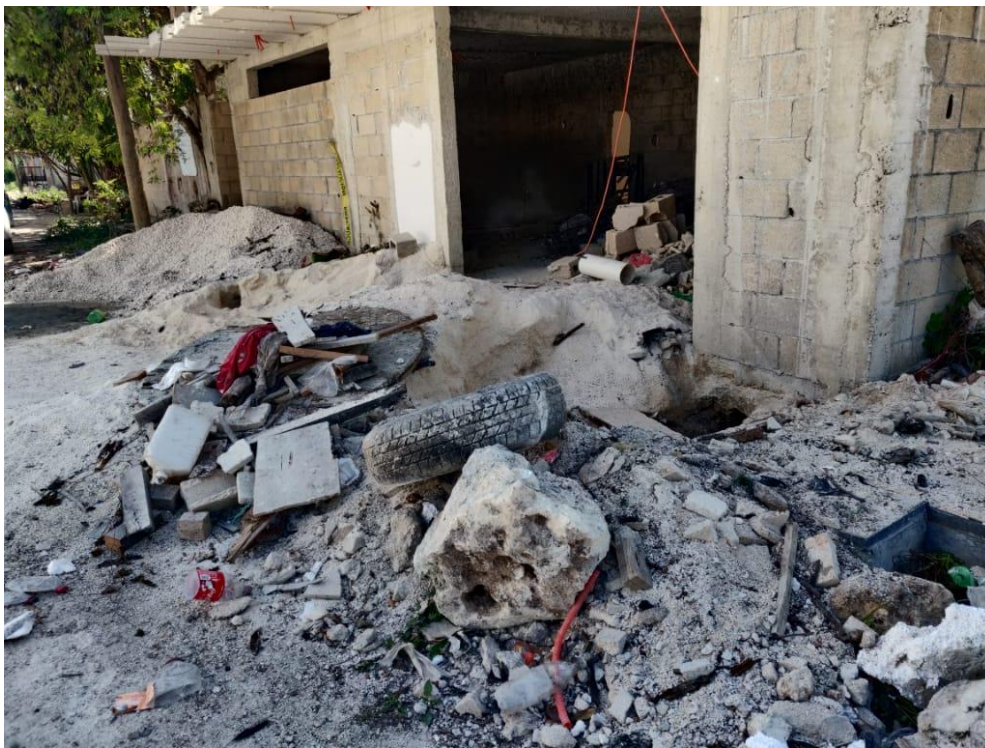
FOTO 3: Sanción por hacer caso omiso a notificaciones anteriores, donde se le solicita retirar material de construcción, Ubicado en c. 23/12 y 16 mz 467, It 001,
