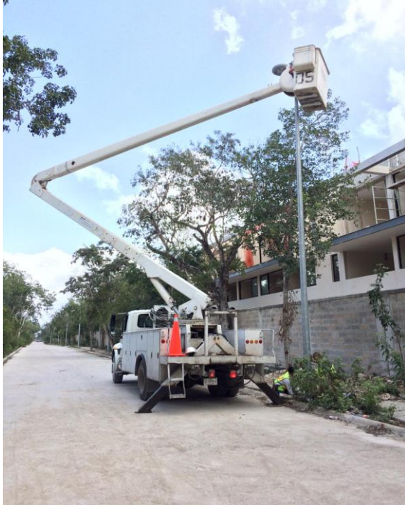
Cableado de Postes en el Fraccionamiento Aldea Zama
