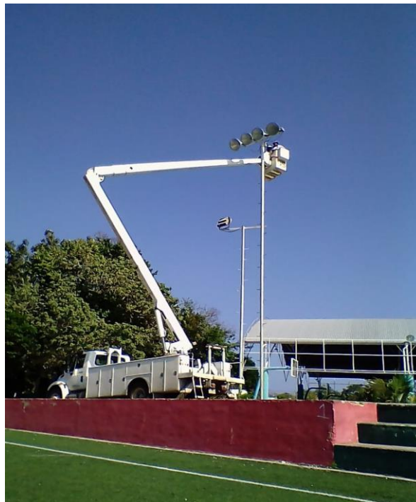
Rehabilitación de luminaria en la Unidad Deportiva
