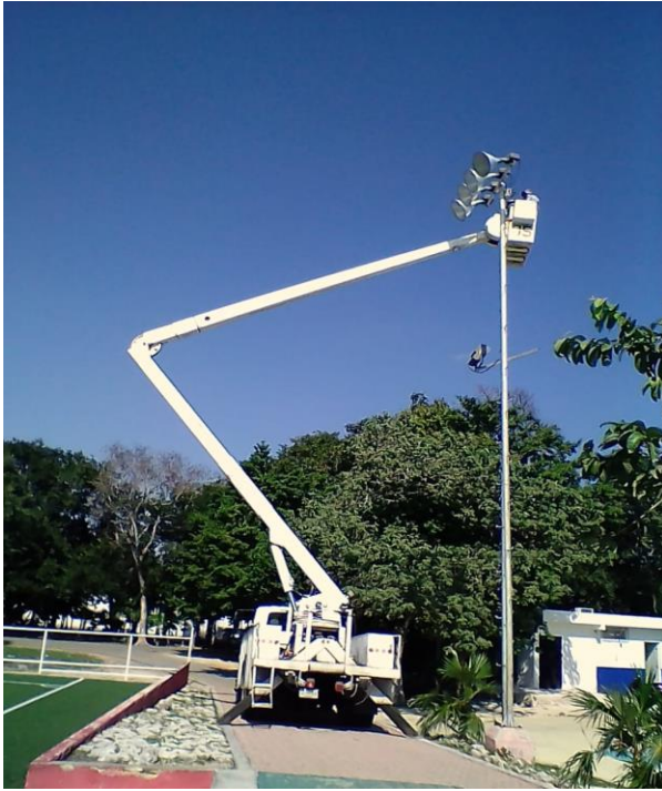
Rehabilitación de luminaria en la Unidad Deportiva
