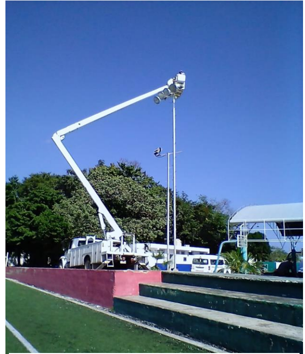
Rehabilitación de luminaria en la Unidad Deportiva
