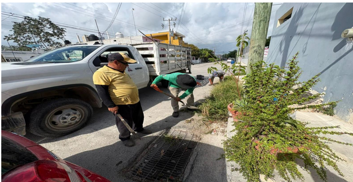
Limpieza de rejillas. Calle huracán Mitch entre calle huracán Beulah; fraccionamiento huracanes.
