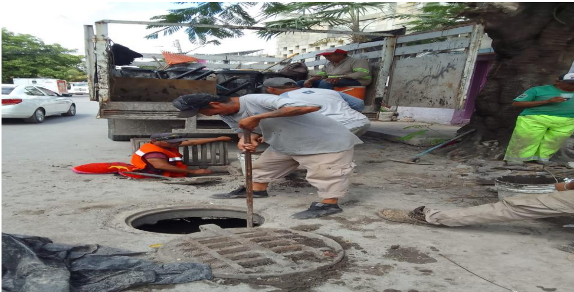
Limpieza de pozos. Calle luna poniente entre calle leo sur y calle aries sur; colonia luna.
