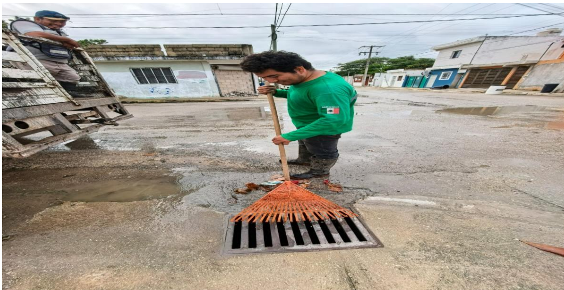
Limpeza de rejillas. Calle le'xiu entre calle ori3n norte; colonia mayapax.
