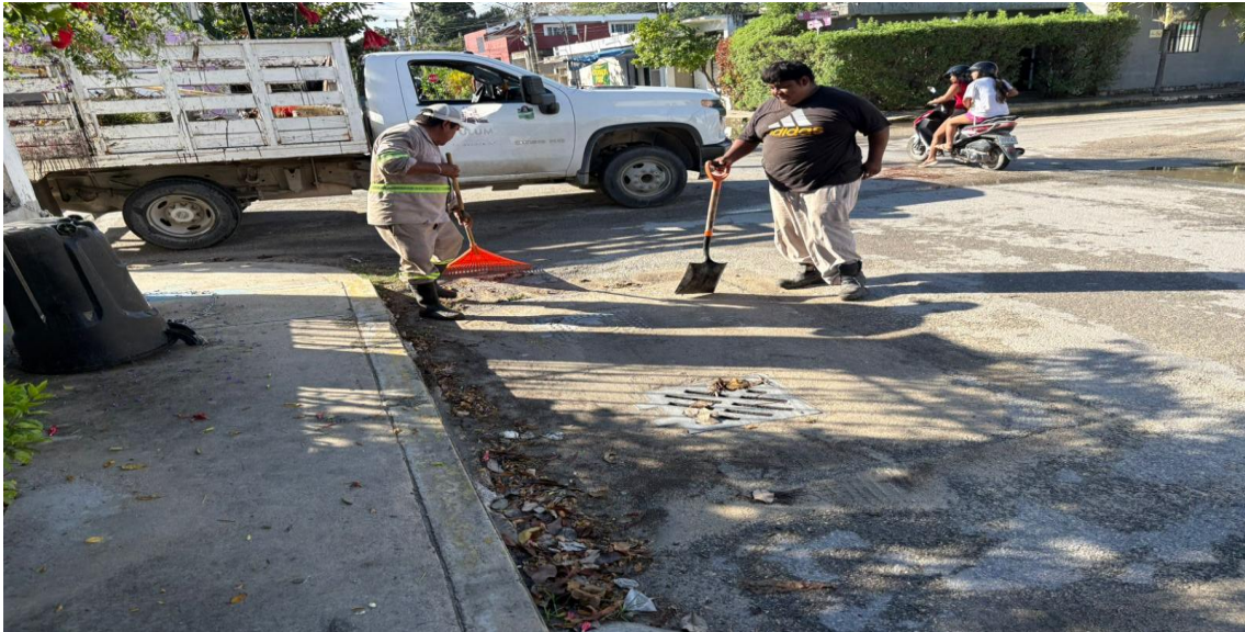
Limpieza de rejillas. Calle asteroides oriente entre calle beta sur; colonia centro.
