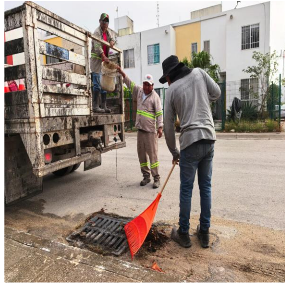
Limpeza de rejillas. Boulevard palmas Tulum entre calle palma astil; fraccionamiento las palmas.
