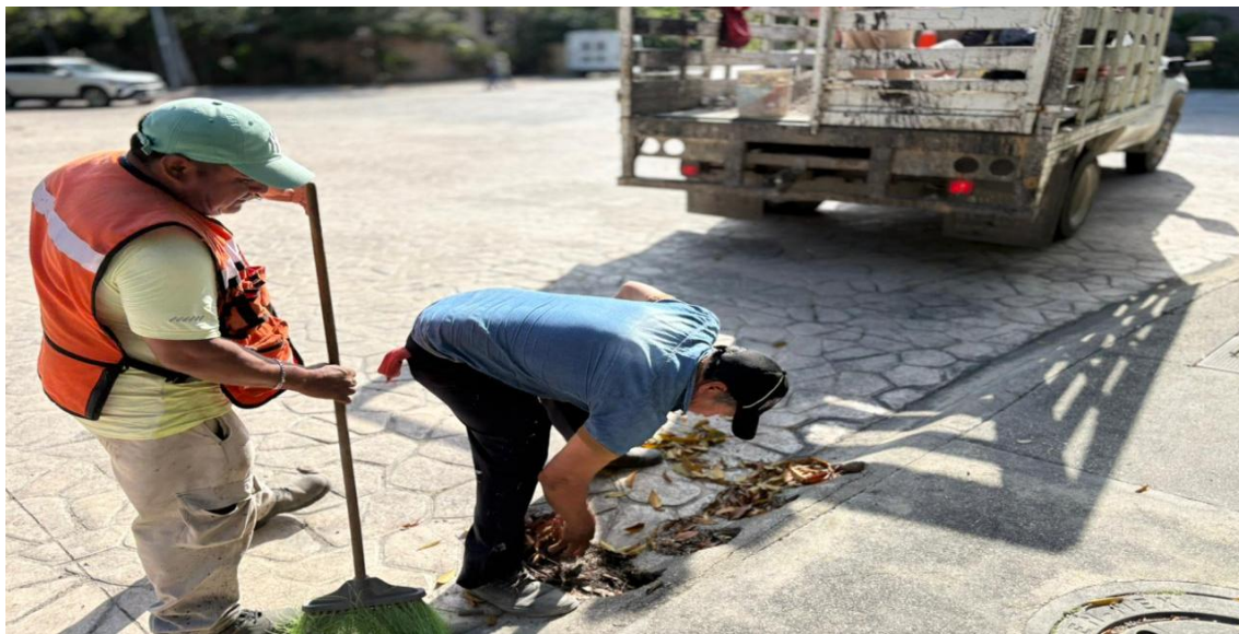
Limpieza de rejillas. Av. aldea zama entre calle nak-be; fraccionamiento aldea zama.
