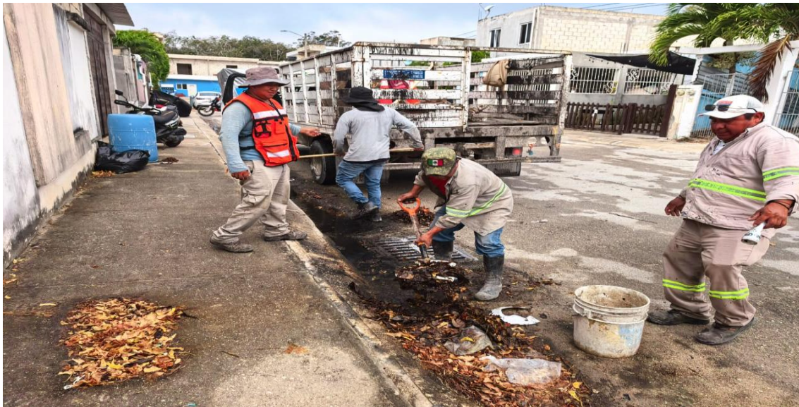
Limpeza de rejillas. Calle palma chat entre boulevard palmas Tulum; fraccionamiento las palmas.
