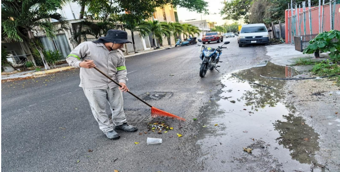
Limpieza de rejillas. Calle sagitario poniente entre calle géminis norte; fraccionamiento mayapax.
