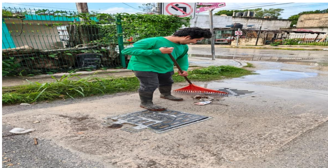
Limpieza de rejillas. Calle sagitario oriente entre calle acuario norte; colonia centro.
