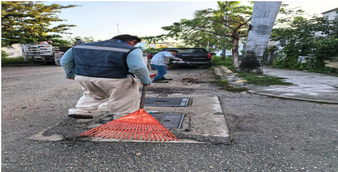
Limpieza de rejillas. Calle 2 poniente entre calle géminis; fraccionamiento guerra de castas.
