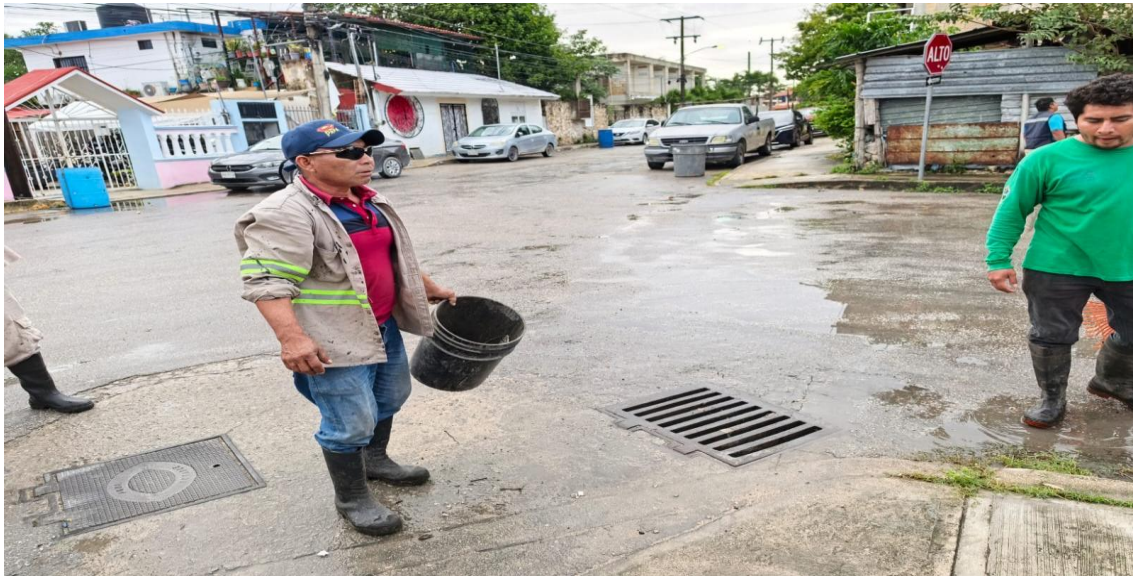
Limpeza de rejillas. Calle luna norte entre calle polar poniente; colonia luna.
