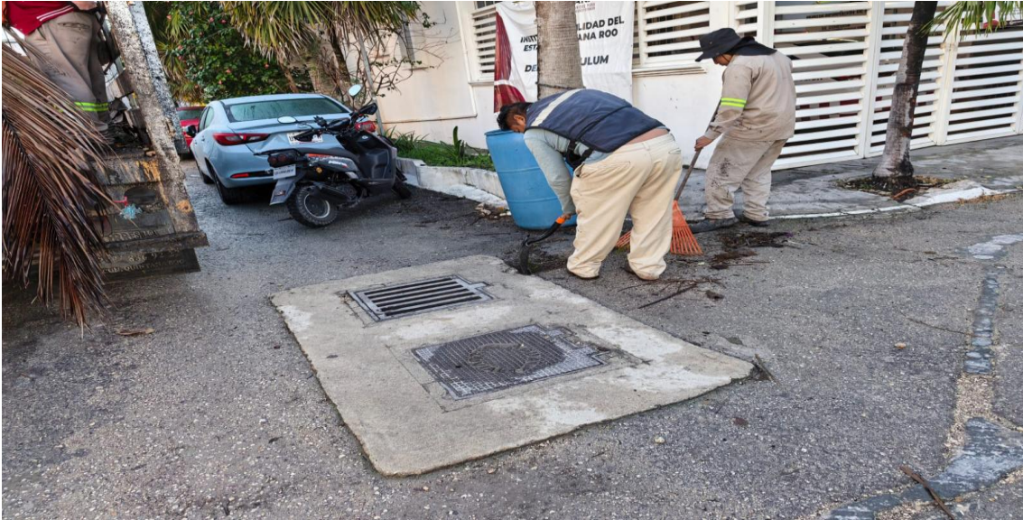
Limpeza de rejillas. Calle 2 poniente entre andador tepich; fraccionamiento guerra de castas.
