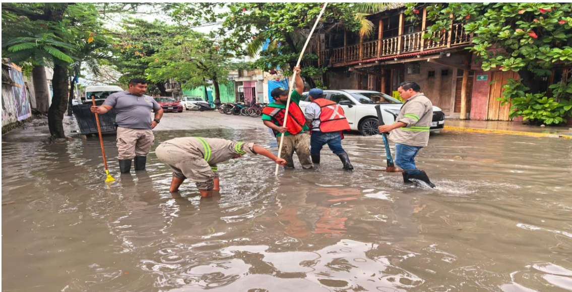
Limpieza de pozos. Calle andrómeda oriente entre calle orión sur; colonia centro.
