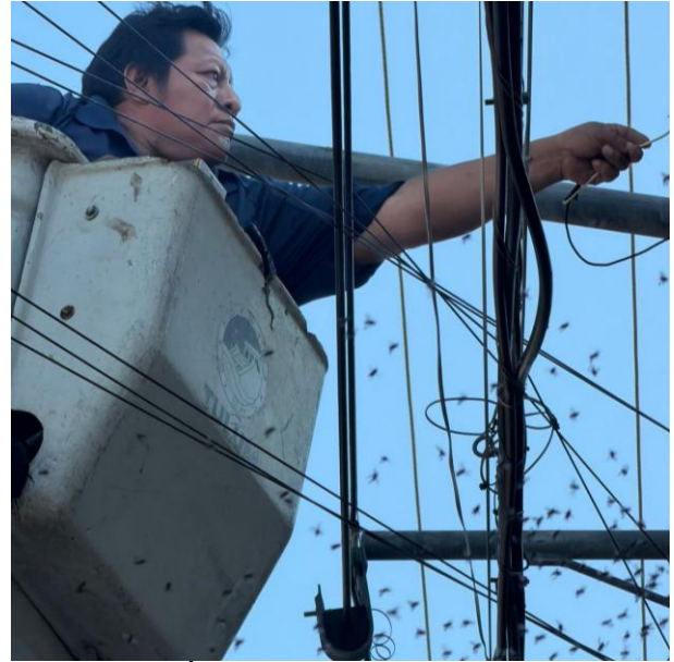
REPARACIÓN DE LUMINARIA APAGADA; C. 11 ENTRE C. 2 OTE A Y C. BUBUL-LEK, FRACC. VILLAS TULUM.
