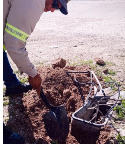
RECONEXIÓN DE LINEAS QUEMADAS Y SULFATADAS; FRACC. XUL-KA.
