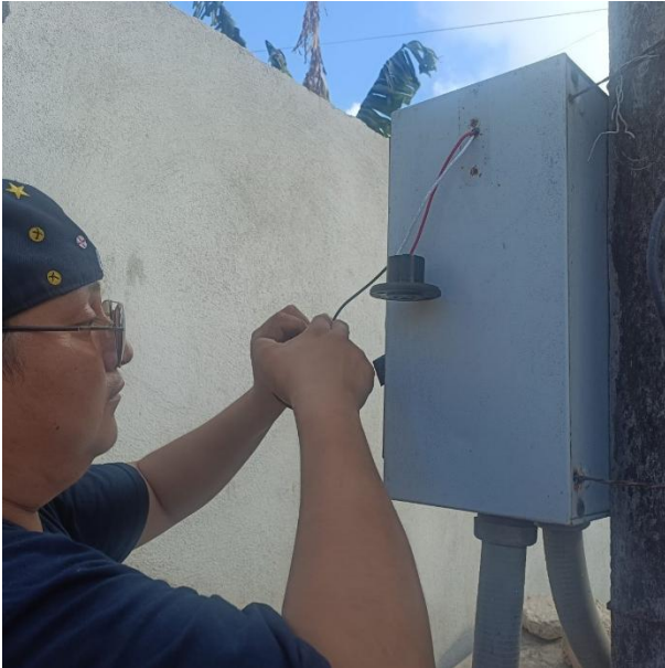
CAMBIO DE BASE DE FOTOCELDA Y FOTOCELDA OBSOLETOS POR NUEVOS PARA HABILITAR SECTOR; C. CHANCHEN ENTRE C. QUETZAL Y C. FAISAN, COL. EJIDO.
