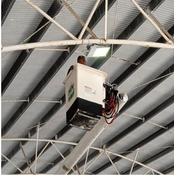
CAMBIO DE LÁMPARAS OBSOLETAS POR FLAT'S NUEVOS; POBLADO AKUMAL.
