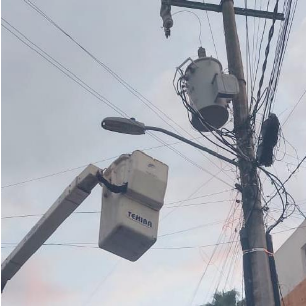
CAMBIO DE FOTOCELDA PARA HABILITAR LUMINARIA; C. CHEMUYIL ENTRE C. XCARET Y C. 30, COL. EJIDO.
