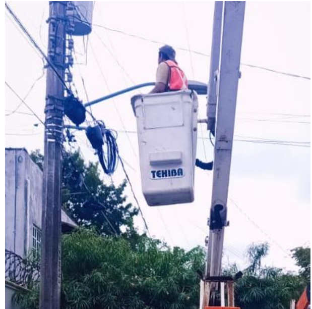
CAMBIO DE BREAK OBSOLETO POR NUEVO; AV. BOCA PAILA ENTRE C. COCODRILO Y C. COCODRILO, COL. EJIDO.
