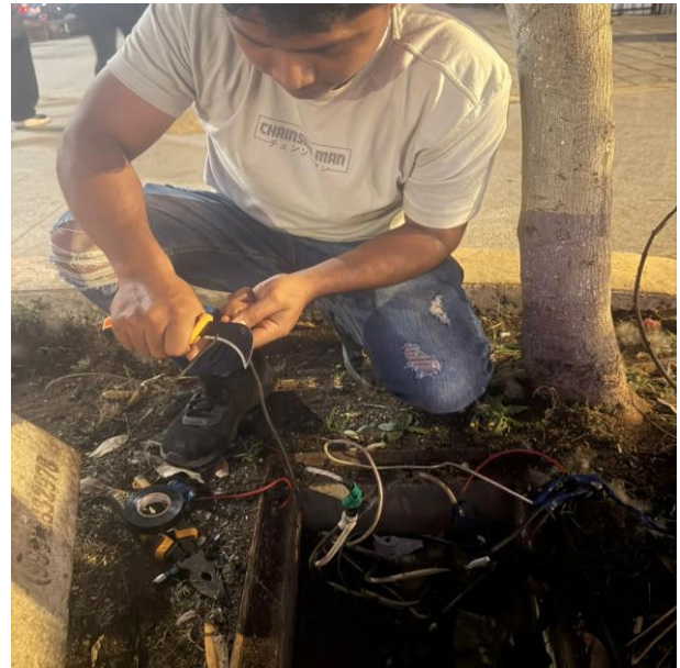
RECONEXIÓN DE LINEAS SUBTERRANEAS PARA HABILITAR LUMINARIAS; AV. OSIRIS SUR ENTRE AV. TULUM Y C. ANDROMEDA, COL. CENTRO.
