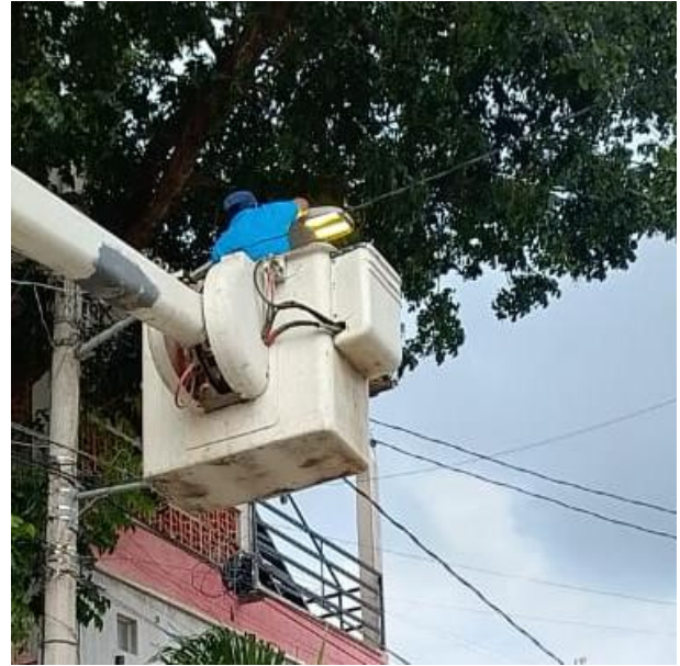
CAMBIO DE FOTOCELDA OBSOLETA POR NUEVA; C. ARIES SUR ENTRE C. SATURNO PTE Y C. LUNA PTE, COL. CENTRO.
