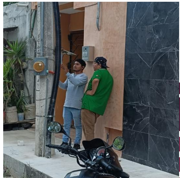
CAMBIO DE BASE DE FOTOCELDA Y FOTOCELDA PARA HABILITAR LUMINARIA; C. MAYA-BALAM ENTRE C. 30 Y C. 32, COL. TUMBEN-KAA.
