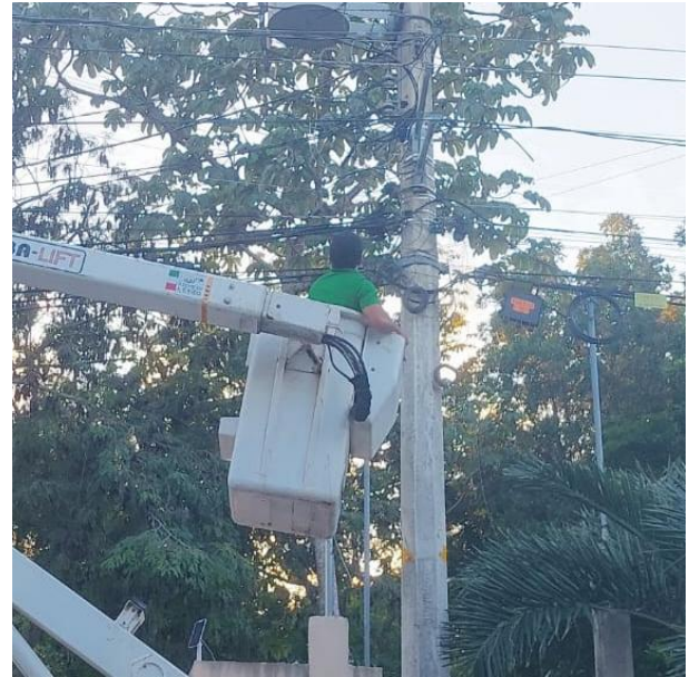
REHABILITACIÓN DE LINEAS SULFATADAS PARA HABILITAR LUMINARIAS; C. PALENQUE ENTRE C. 11 Y C. 13, COL. LA VELETA.
