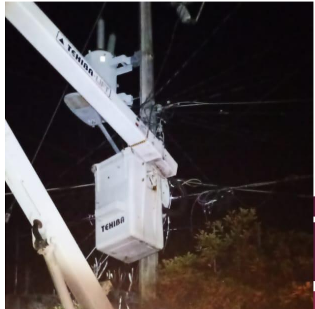
CAMBIO DE FOTOCELDA OBSOLETA POR NUEVA PARA HABILITAR LUMINARIAS; AV. KUKULKAN ENTRE C. GAVILANES Y C. GOLONDRINAS, COL. EJIDO.
