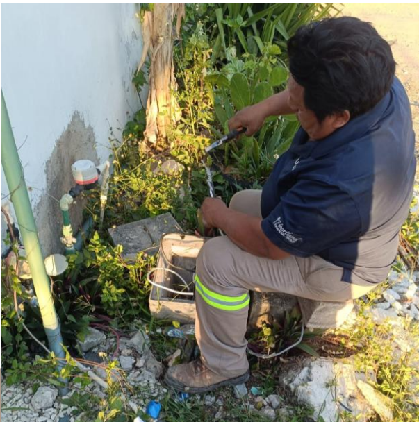
REHABILITACIÓN DE LINEAS SUBTERRANEAS PARA HABILITAR LUMINARIAS; C. 23 ENTRE C. NAVAL Y C. 12, COL. TUMBEN-KAA.
