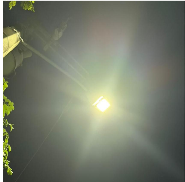
CAMBIO DE FOTOCELDA A SECTOR PARA HABILITARLO; UNIDAD DEPORTIVA.
