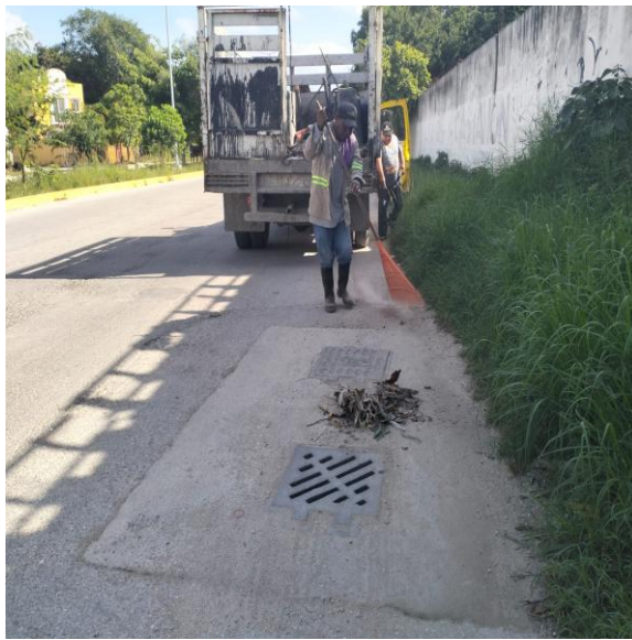
Limpeiza de rejillas. Av. la selva; colonia tumben kaa.
