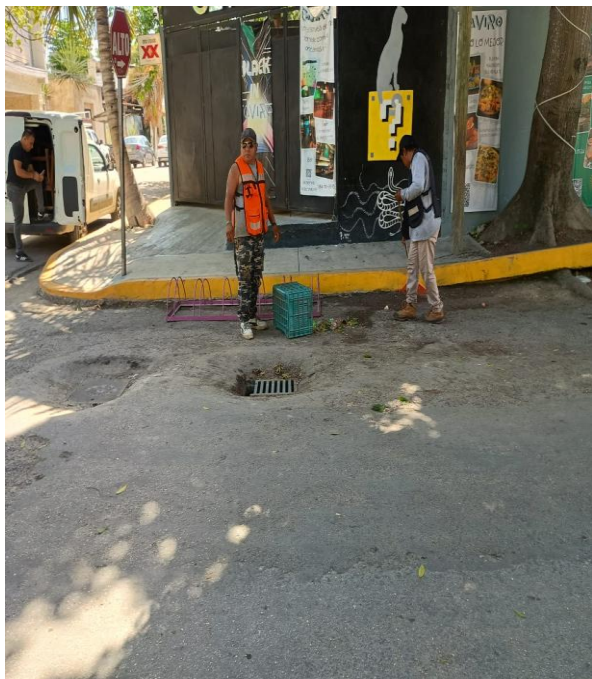
Limpieza de rejillas. Calle andrómada oriente entre calle orión sur; colonia centro.
