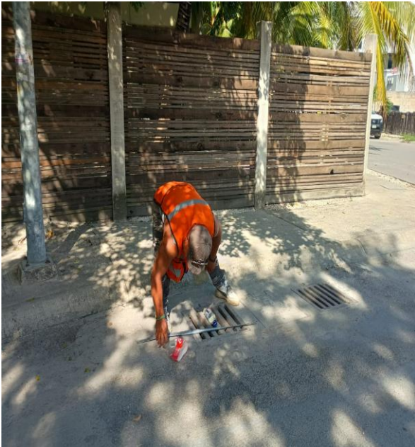
Limpieza de rejillas. Calle escorpión entre calle 4 poniente y calle cecilio chi; fraccionamiento guerra de castas.
