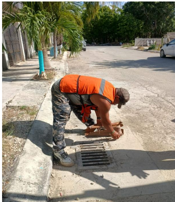
Limpieza de rejillas. Calle jacinto pat entre calle 2 poniente y calle 4 poniente; fraccionamiento guerra de castas.
