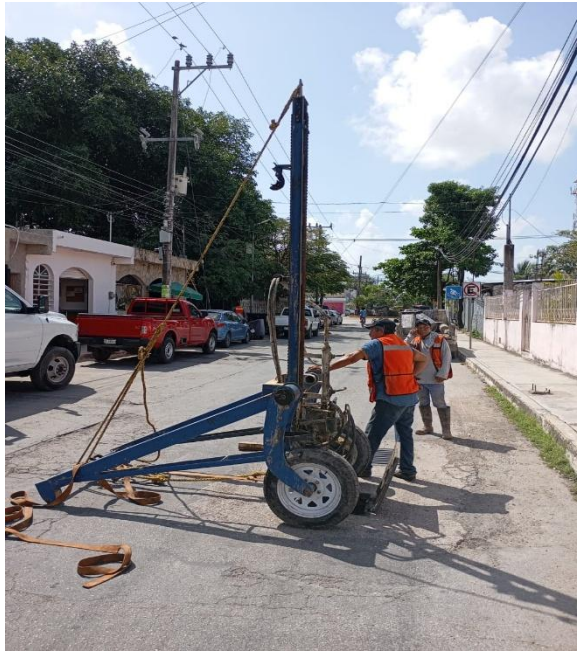
Desazolve. Calle alfa norte entre calle polar oriente; colonia centro.
