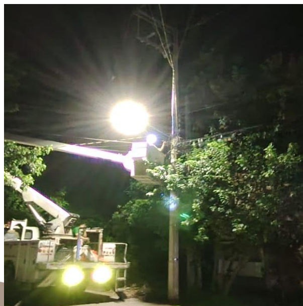
REPARACIÓN DE LUMINARIA APAGADA; C. COCODRILO ENTRE C. SIAN-KAAN, COL. EJIDO NTE.
