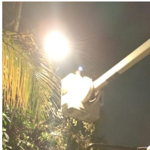
CAMBIO DE FOTOCELDA A LUMINARIA PARA HABILITARLA; C. GAMA OTE ENTRE C. GEMINIS SUR Y C. LIBRA SUR, COL. SAC-BE.
