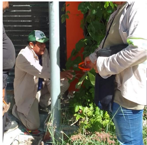
RECONEXIÓN DE LINEAS SULFATADAS A LUMINARIA; C. 25 ENTRE C. 24 Y C. 20, COL. TUMBEN-KAA.
