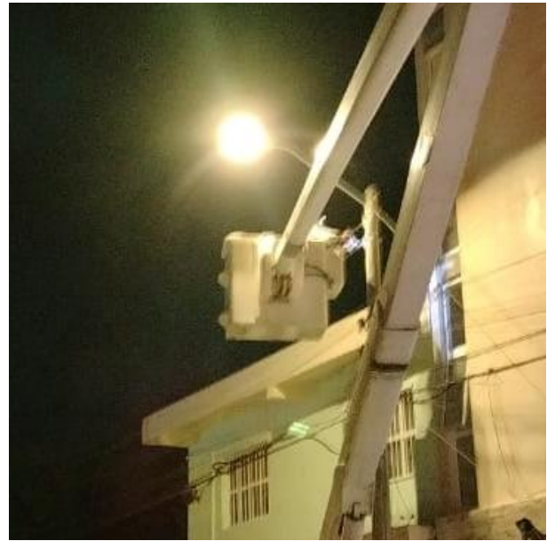
REPARACIÓN DE LUMINARIA APAGADA DE NOCHE; CALLE CENTAURO NTE ENTRE CALLE BUBUL-LEK, COL. MAYA PAX.
