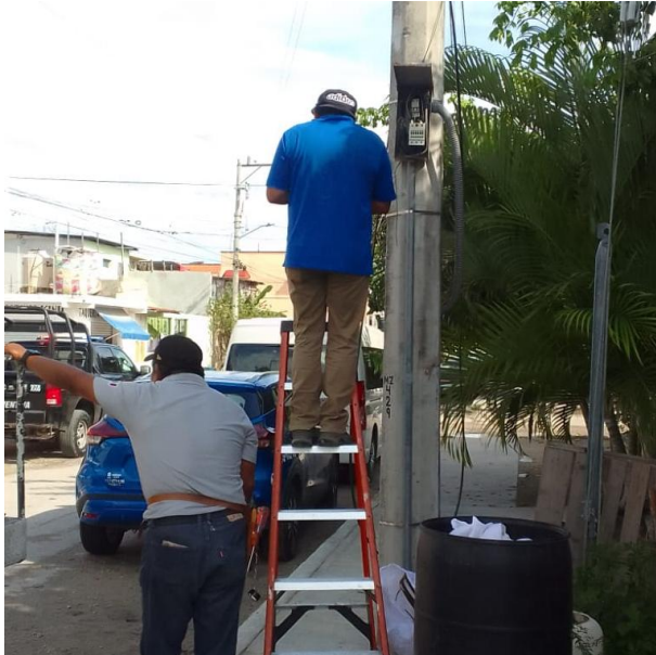
CAMBIO DE CONTACTOR QUEMADO POR NUEVO; CALLE 24 ENTRE CALLE FAISAN, COL. TUMBEN-KAA.
