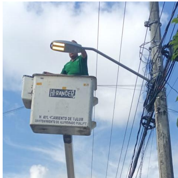
CAMBIO DE FOTOCELDA QUEMADAS POR NUEVAS; COL. EJIDO.
