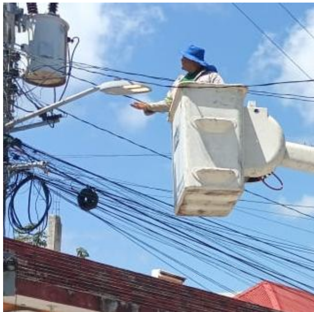
CAMBIO DE FOTOCELDA QUEMADAS POR NUEVAS; COL. CENTRO.
