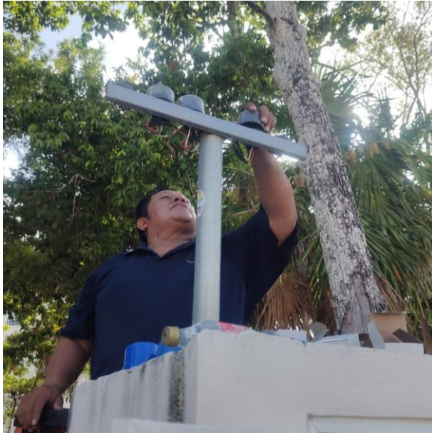
CAMBIO DE FOOCELDAS POR NUEVAS; FRACC. ALDEA TULUM.
