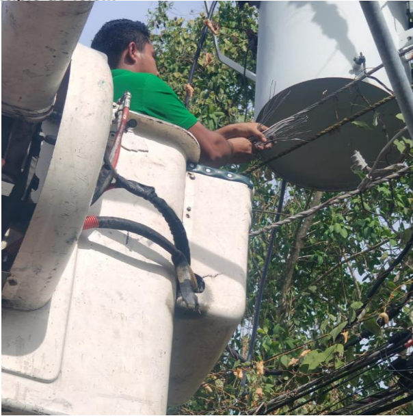
INSTALACIÓN DE LINEA REVENTADA; CALLE PALENQUE ENTRE CALLE AZUCENA, COL. LA VELETA.
