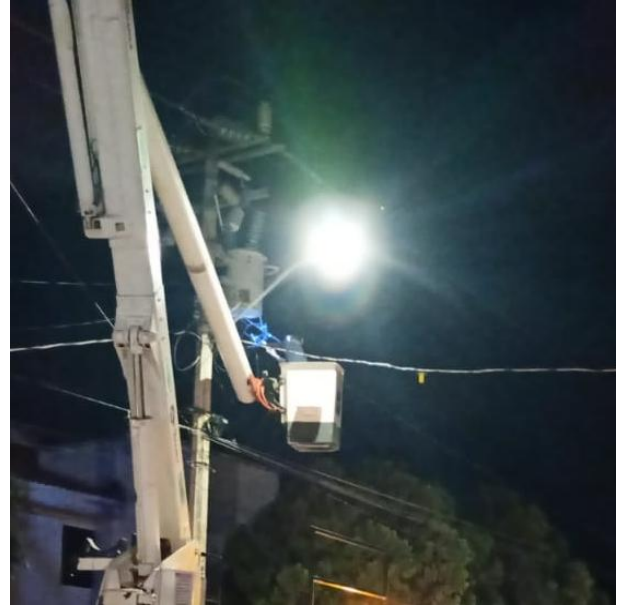
REHABILITACIÓN DE LUMINARIA APAGADA; CALLE ASTEROIDE ENTRE AV. COBA, COL. LAK'IIN.
