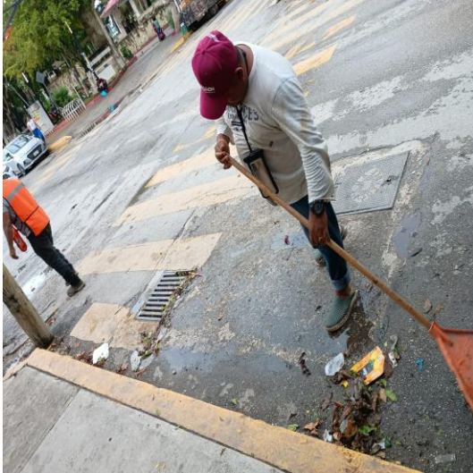
Limpieza de rejillas: Calle sol oriente entre calle alfa sur; colonia centro sur.
