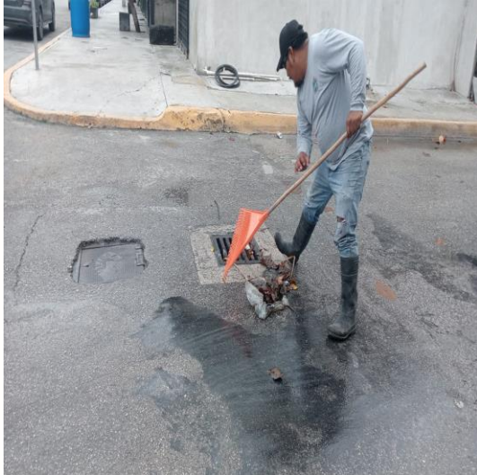
Limpieza de rejillas: Calle sagitario oriente entre av. satélite; colonia centro norte.
