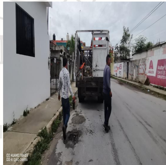
Limpieza de rejillas: Calle géminis sur entre calle neptuno sur; colonia centro sur.
