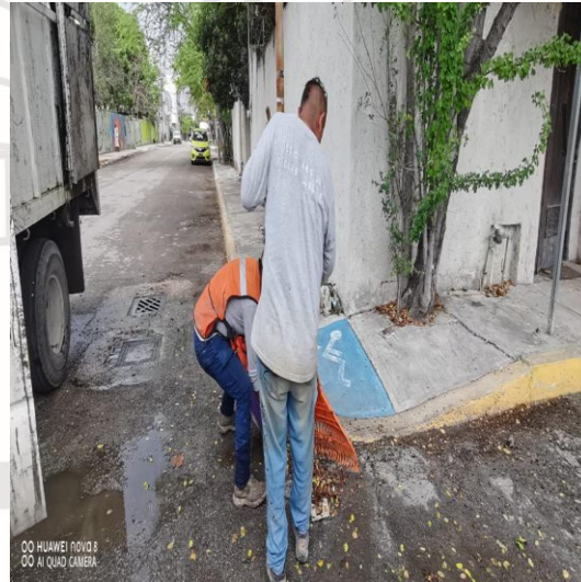
Limpieza de rejillas: Calle mercurio poniente entre calle luna sur; colonia centro sur.
