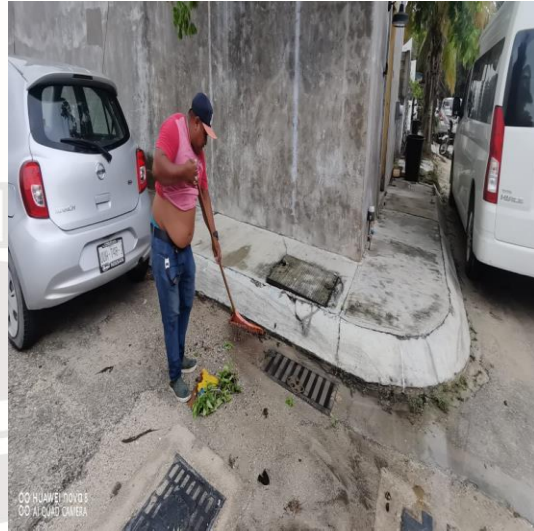
Limpieza de rejillas: Calle 7 sur entre calle 2 a bis; fraccionamiento villas Tulum.
