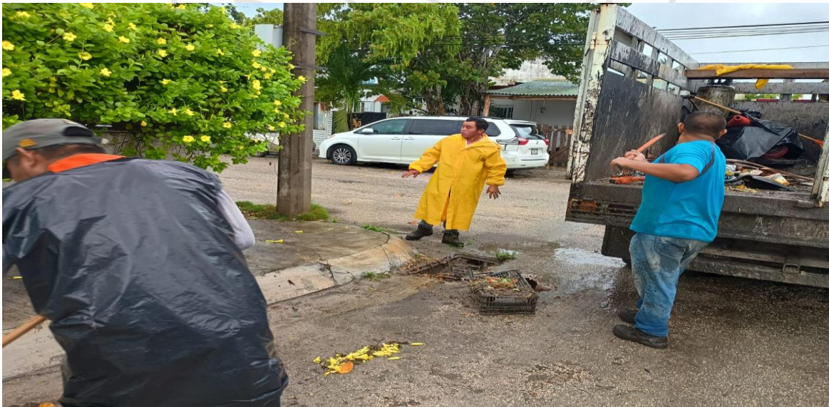
Limpeza de rejillas: Calle 5 sur entre calle 2 a oriente; fraccionamiento villas TULUM.
