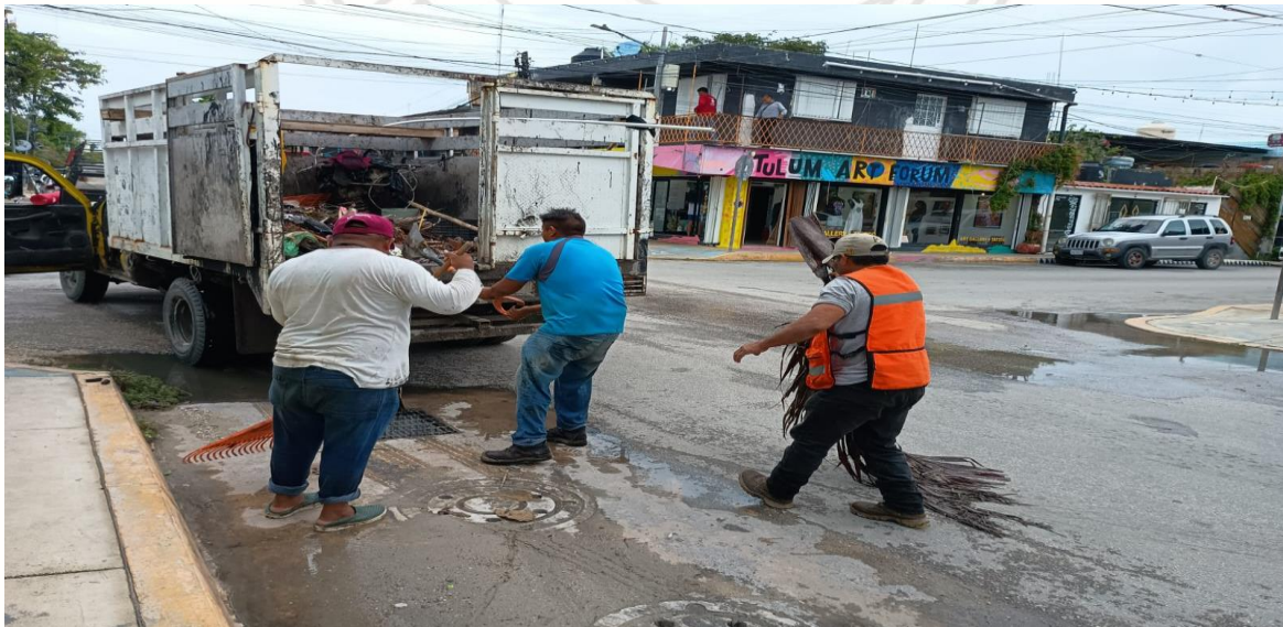
Limpieza de rejillas: Calle sol oriente entre calle beta sur; colonia centro sur.
