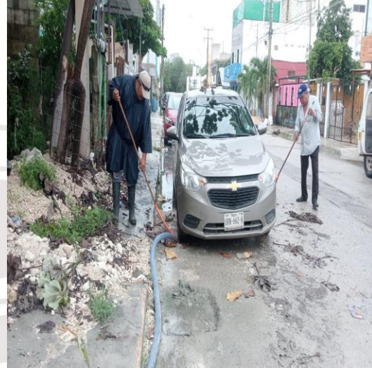
Limpieza de rejillas: Calle huracán beulah entre calle huracán mitch; fraccionamiento huracanes.
