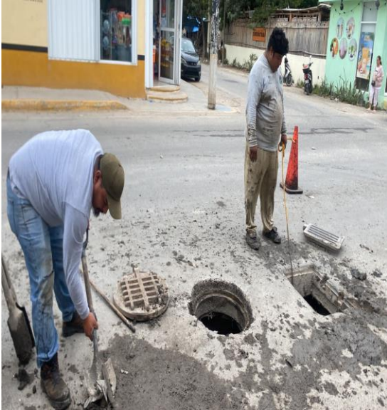
Limpieza de pozos; Av. kulkán entre calle polar poniente y calle saturno poniente; colonia luna.
