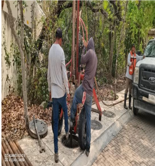
Desazolve de pozos Calle aldea zama entre calle kaam, fraccionamiento aldea zama. (pozo no. 01).
