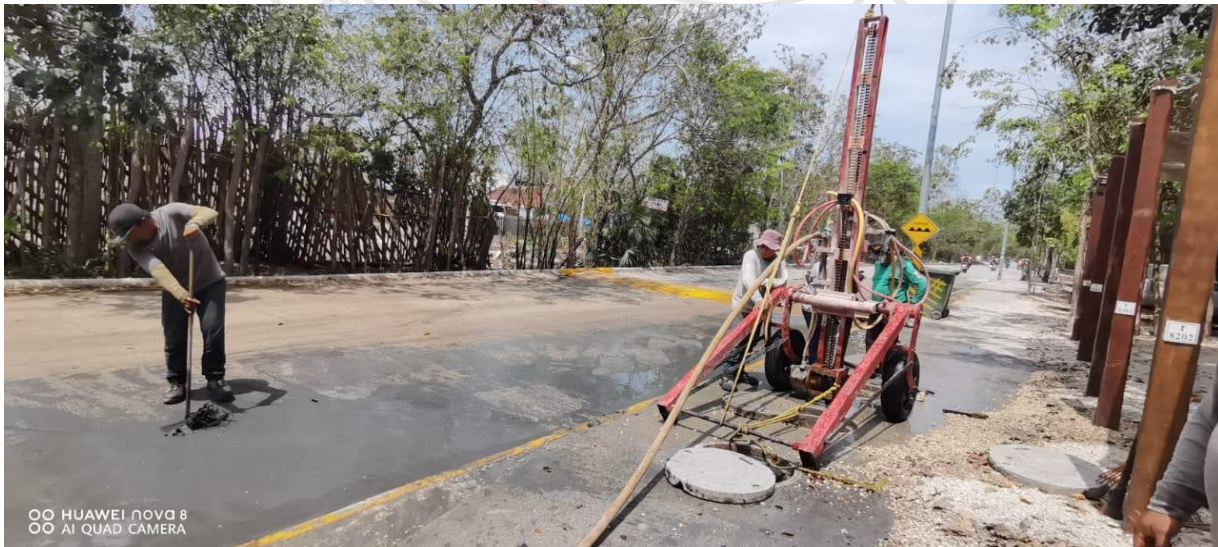
Desazolve de pozos Calle Juan-Ek entre calle itzamna y calle alfa sur, fraccionamiento aldea zama.
