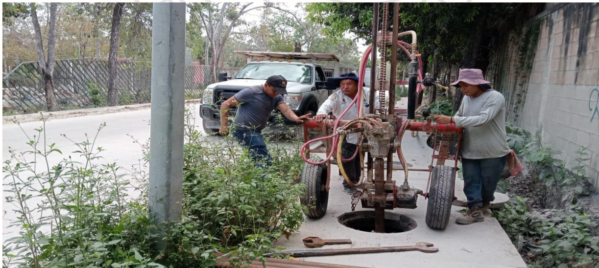
Desazolve de pozos Calle Juan-Ek entre calle itzamna y calle alfa sur.
