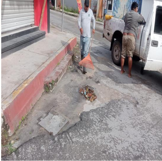
Limpieza de rejillas: Calle polar poniente entre calle júpiter sur; colonia centro sur.
