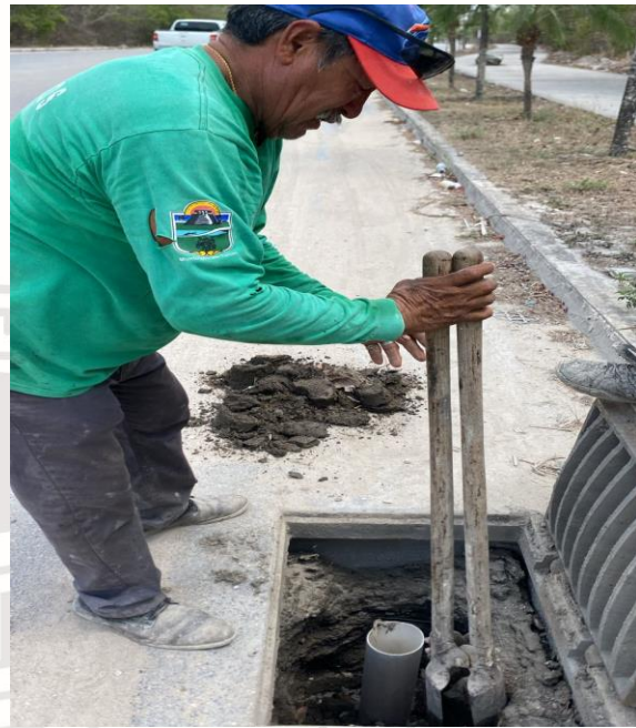
Limpieza de pozos; Av. 10 norte bis entre av. Tulum fraccionamiento villas Tulum.
