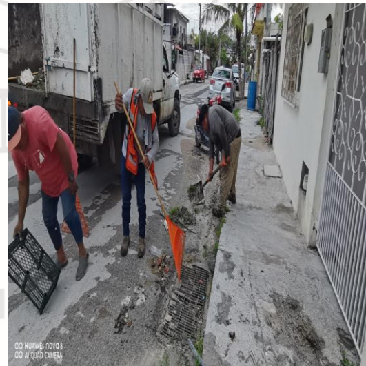
Limpieza de rejillas: Calle huracán janeth entre calle huracán paulina; fraccionamiento huracanes.
