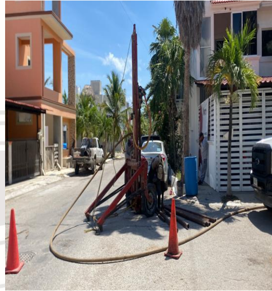
Desazolve de pozos Calle 2 oriente entre calle andador tepich, fraccionamiento guerra de casta.
