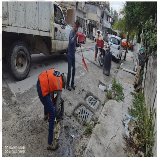
Limpieza de rejillas: Calle huracán rossana entre calle huracán paulina; fraccionamiento huracanes.
