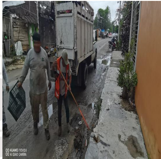
Limpieza de rejillas: Calle mercurio oriente entre calle saturno sur; colonia centro sur.
