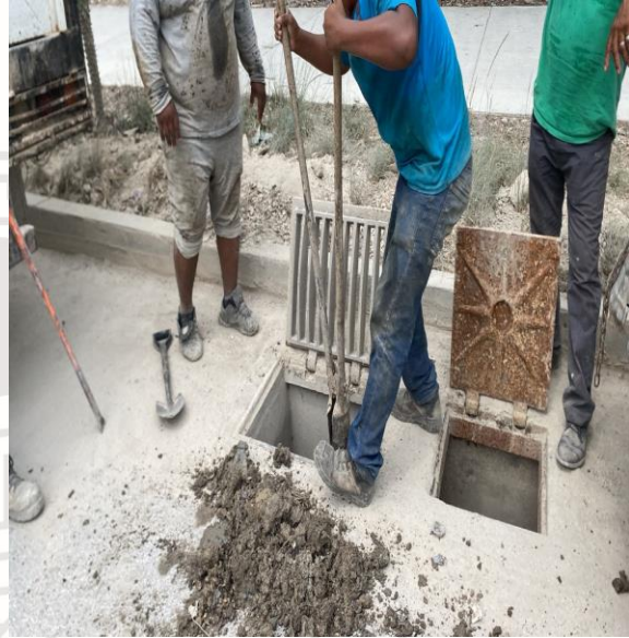
Limpeza de pozos; Av. 10 norte bis entre calle 2 bis norte; fraccionamiento villas Tulum.
