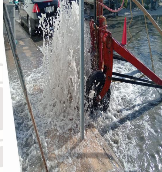
Desazolve de pozos Calle 4 oriente entre calle libra norte, fraccionamiento villas Tulum.
