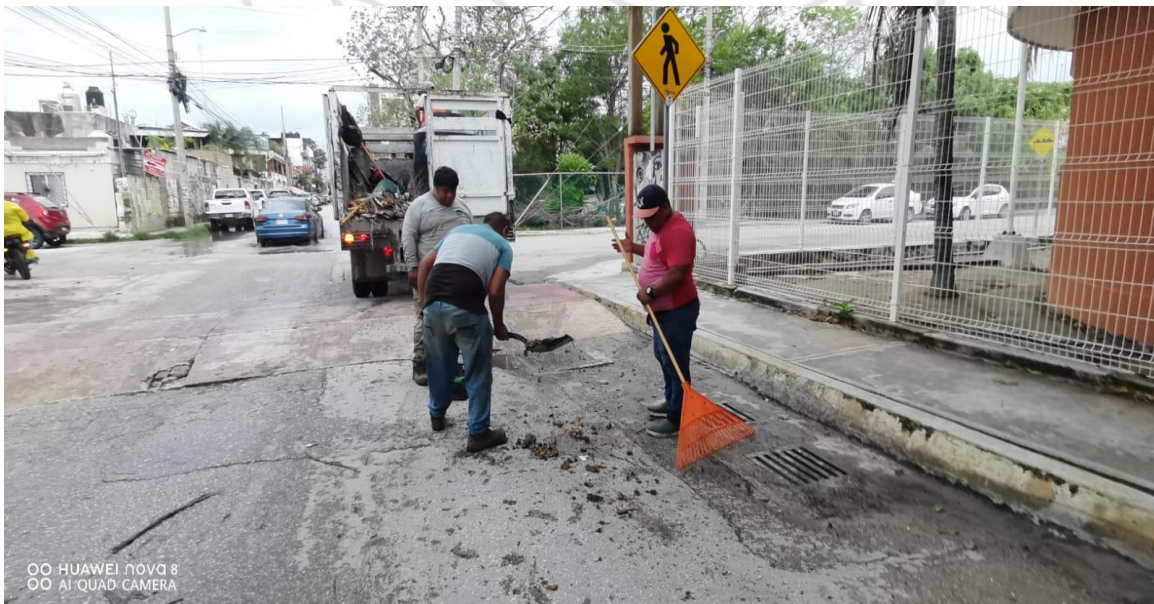
Limpieza de rejillas: Calle sol oriente entre calle libra sur; colonia centro sur.
