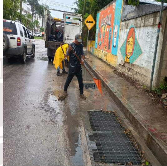
Limpieza de rejillas: Calle 5 sur entre la calle 2 bis oriente; fraccionamiento villas Tulum.
