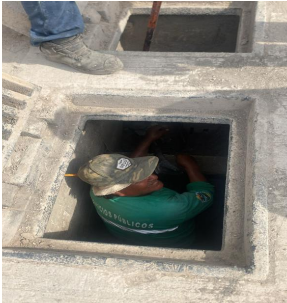
Limpieza de pozos; Calle 4 poniente entre calle osiris norte y calle 2 poniente; colonia centro norte.
