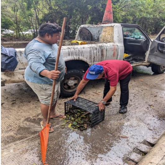
Limpeza de rejillas: Calle aldea zama; fraccionamiento aldea zama.
