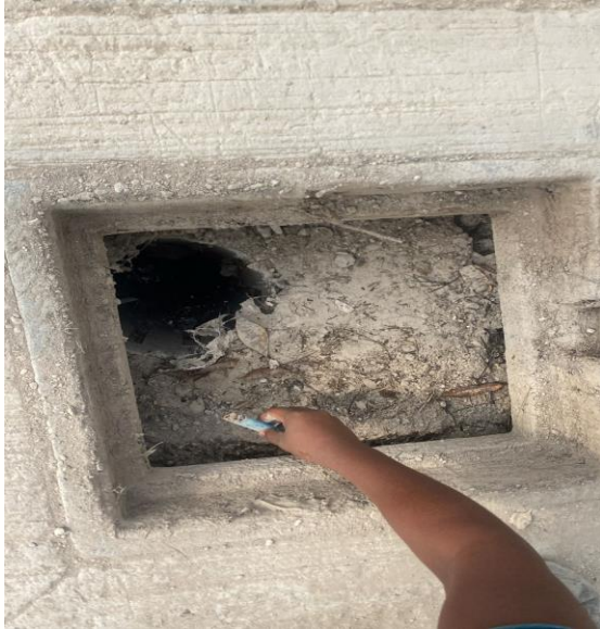
Limpieza de pozos; Av. 10 norte bis entre calle jaaleb y calle kitam; colonia ejido norte. Pozo 01.
