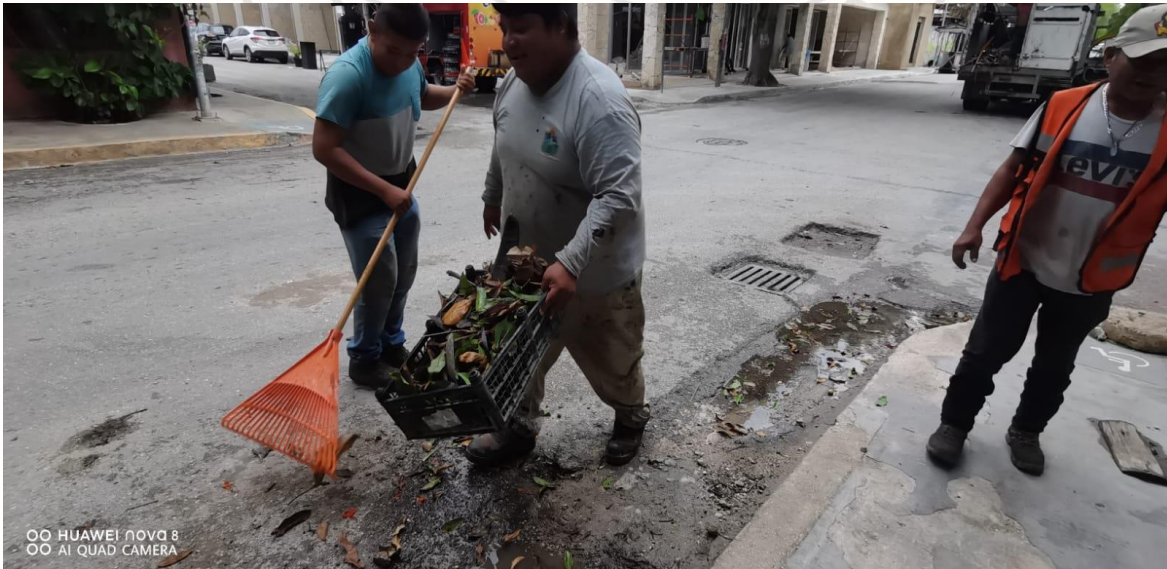
Limpieza de rejillas: Calle andrómeda oriente entre calle orión sur; colonia centro sur.
