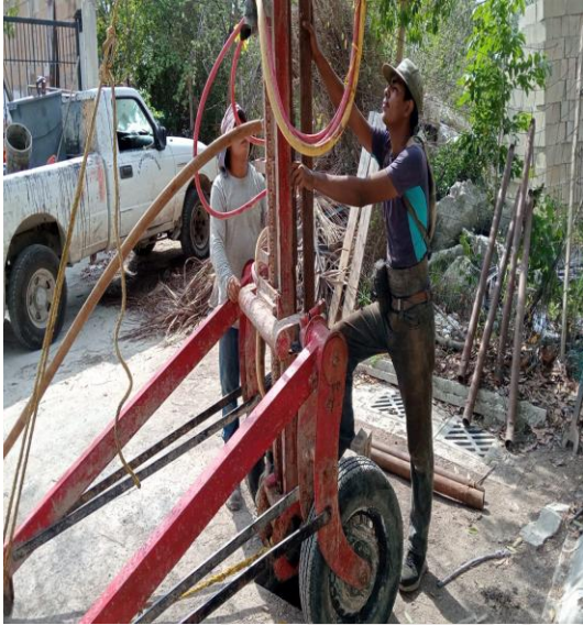
Desazolve de pozos Calle 2 oriente entre calle 11 y calle 13 sur, fraccionamiento villas Tulum.
