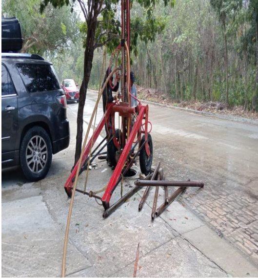
Desazolve de pozos Calle balam dzacab entre calle dátil; fraccionamiento aldea zama
