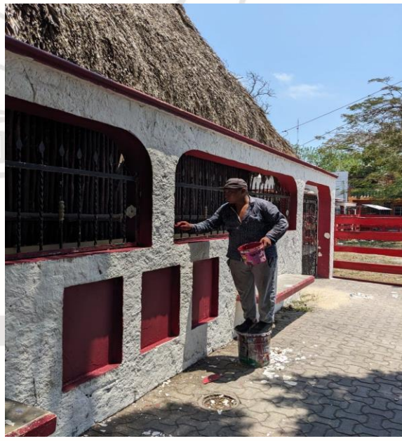
Pintura; Realización de pintura en el parque de la cancha maya; colonia maya.
