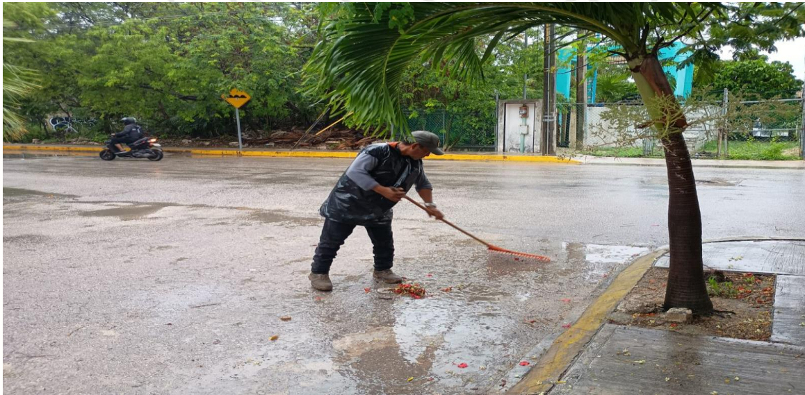
Limpieza de rejillas: Calle 2 bis oriente entre calle 5 sur; fraccionamiento villas Tulum.
