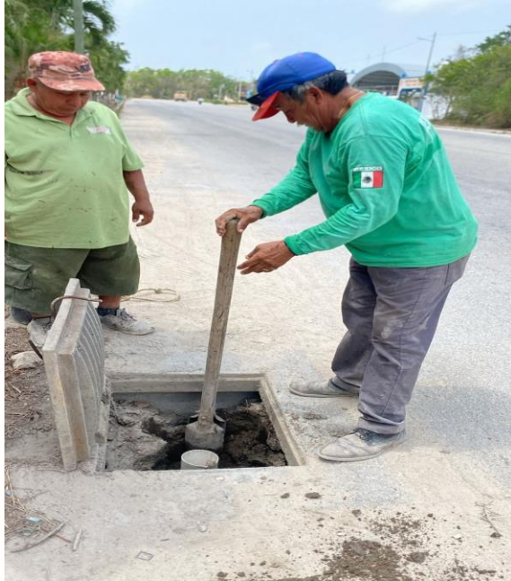
Limpieza de pozos; Av. 10 norte bis entre av. Tulum; fraccionamiento villas Tulum.
