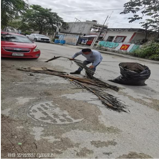
Limpieza de rejillas: Calle géminis sur entre calle 4 oriente; colonia centro norte.
