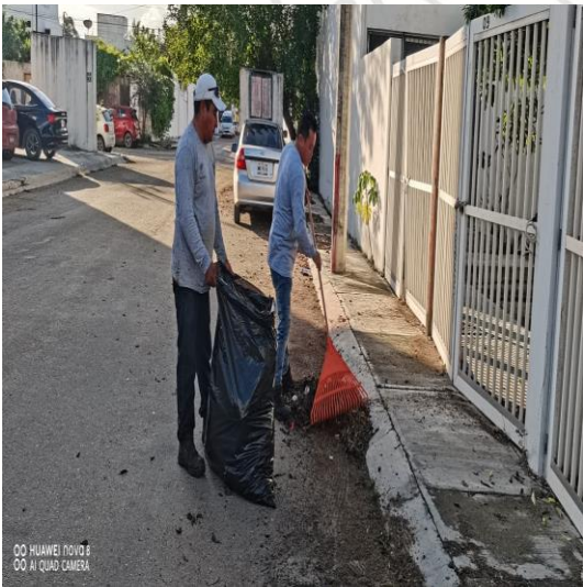
Limpieza de rejillas; Calle 5 sur entre calle 4 poniente y la calle 2 oriente; fraccionamiento villas Tulum.
