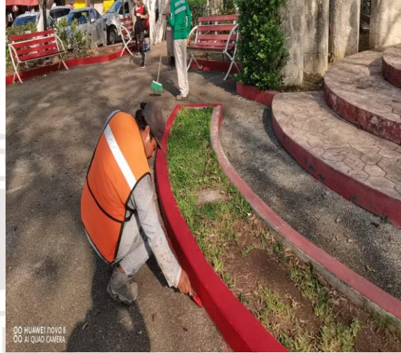
Pintura; Realización de pintura en las bases de las guarniciones del monumento de Benito Juárez parque dos aguas.
