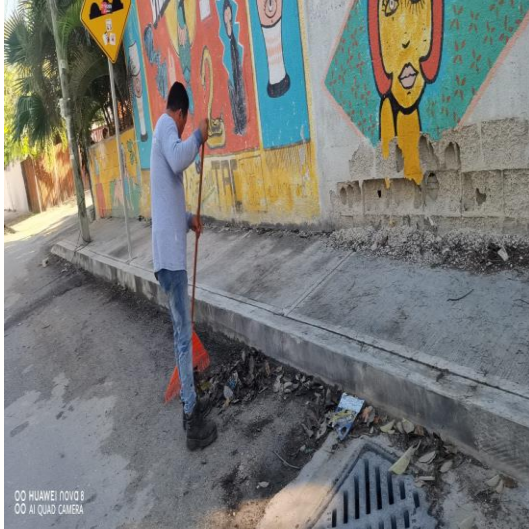
Limpieza de rejillas; Calle 3 sur entre calle 2 bis oriente y la av. Tulum; fraccionamiento villas Tulum.
