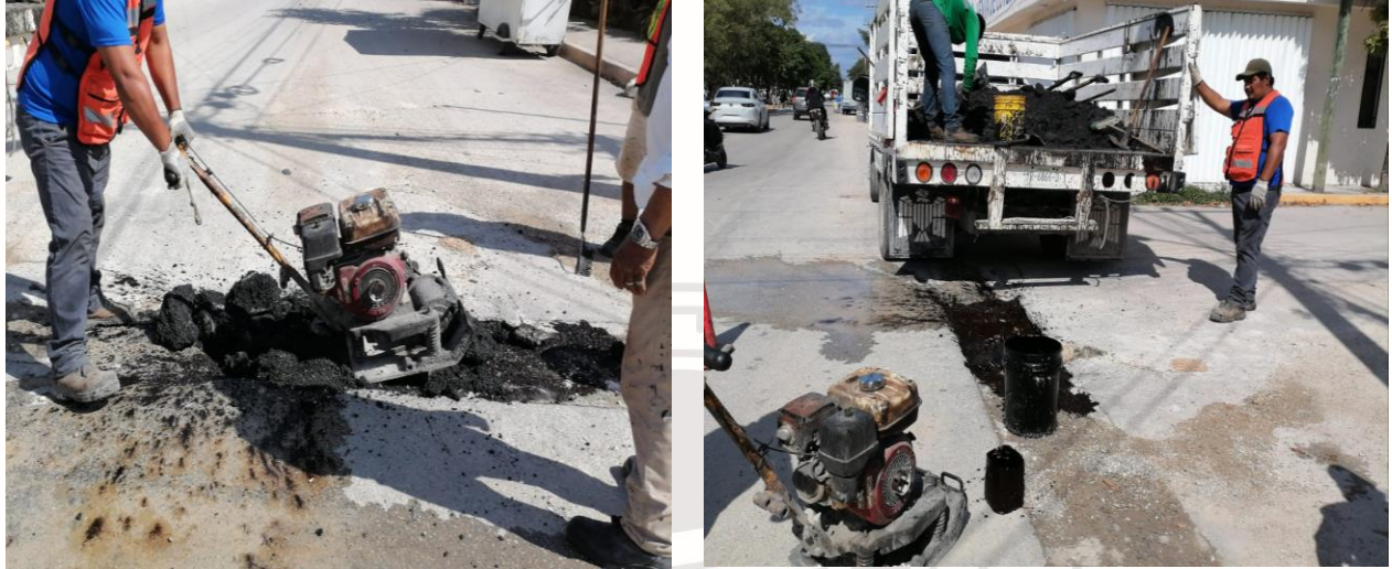
Bacheo: Av. Tulum entre calle luna sur; colonia centro.
