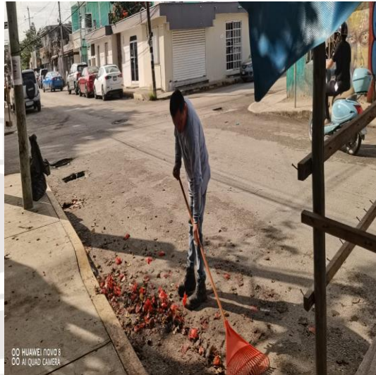
Limpieza de rejillas: Calle andrómada oriente entre la calle beta sur; colonia centro sur.
