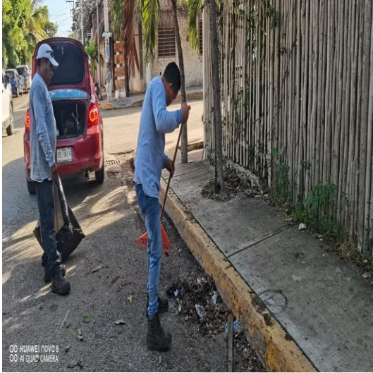
Limpieza de rejillas: Calle andrómeda oriente entre la av. satélite sur; colonia centro sur.
