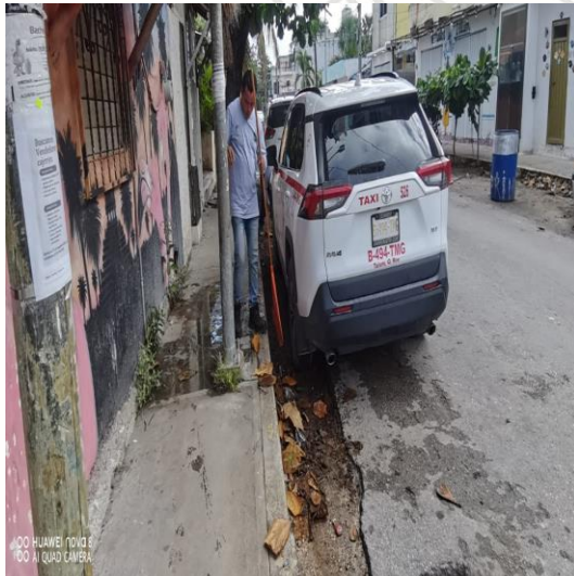
Limpieza de rejillas; Calle andrómeda oriente entre calle osiris sur; colonia centro sur.
