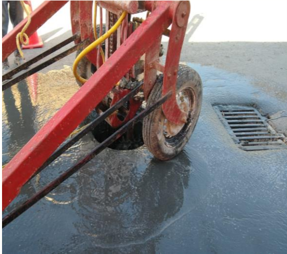
Desazolve de pozos Calle centauro norte entre calle polar oriente; colonia centro.
