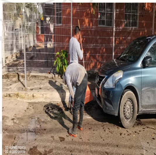
Limpieza de rejillas: Calle andrómeda oriente entre calle osiris sur; colonia centro sur.
