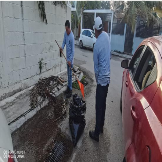
Limpeza de rejillas; Calle 17 entre calle 4 oriente y calle 2 bis oriente; fraccionamiento villas Tulum.
