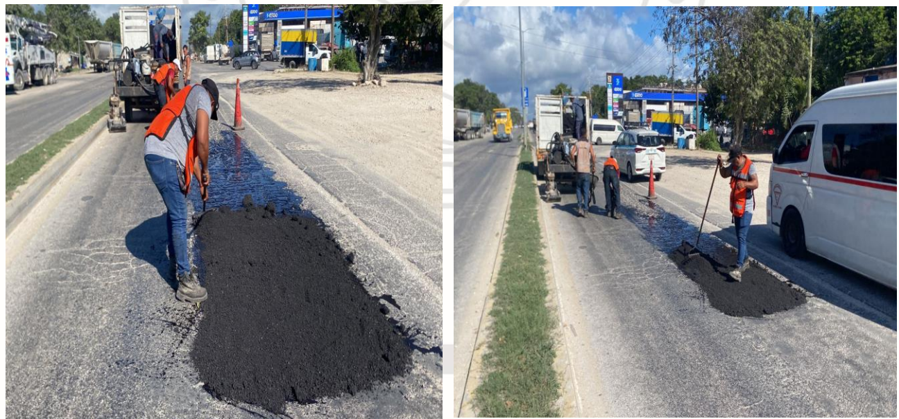
Bacheo: Av. coba entre av. Tulum; colonia centro.
