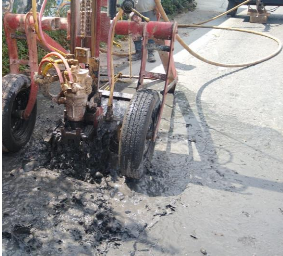
Desazolve de pozos Calle centauro norte entre calle sagitario oriente; colonia centro.
