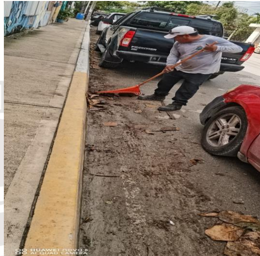
Limpieza de rejillas: Calle neptuno oriente entre calle centauro sur; colonia centro sur.
