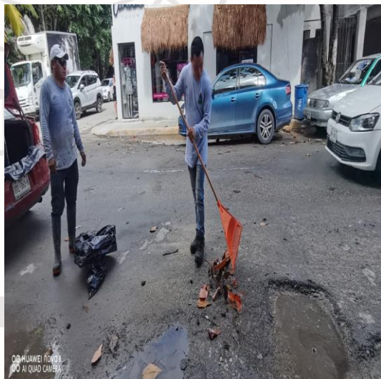
Limpeza de rejillas: Calle sol oriente entre calle centauro sur; colonia centro sur.
