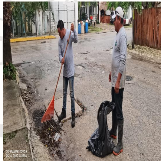
Limpieza de rejillas: Calle 2 bis oriente entre calle 3 sur; fraccionamiento villas Tulum.
