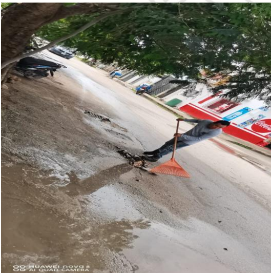
Limpieza de rejillas: Calle géminis sur entre calle sol oriente; colonia centro sur.
