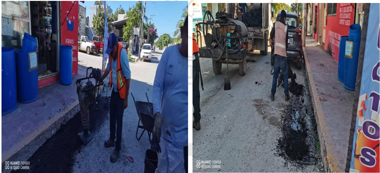
Bacheo: Calle tun-kul entre calle orión norte; colonia centro.
