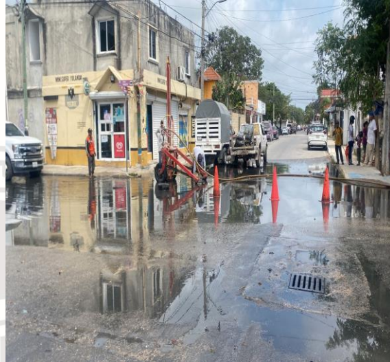
Desazolve de pozos Calle gama oriente entre calle orión sur; colonia lak'iin.
