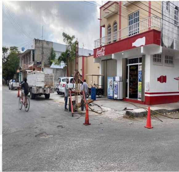
Desazolve de pozos Calle tumble kuxtal entre calle chanchen; colonia ejido norte.
