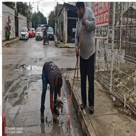
Limpieza de rejillas; Calle andrómeda oriente entre calle gémínis sur; colonia centro sur.
