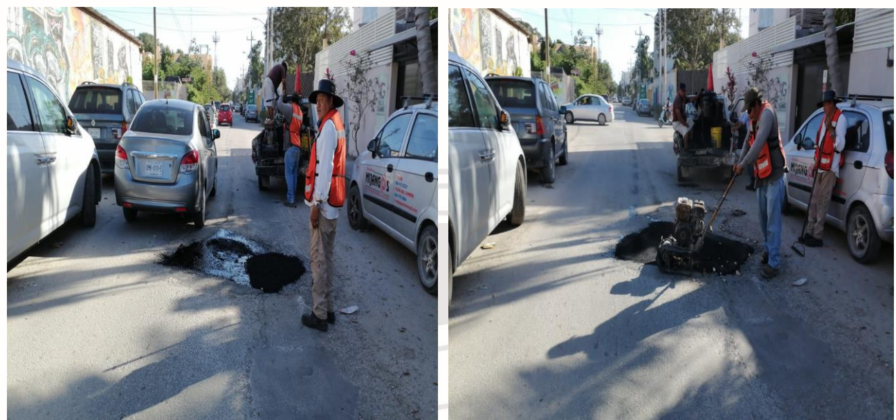
Bacheo: Calle andrómada entre av. satélite y calle géminis; colonia lak'iin.
