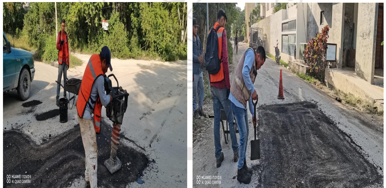
Bacheo: Calle 6 sur entre calle 1 poniente; colonia la veleta.
