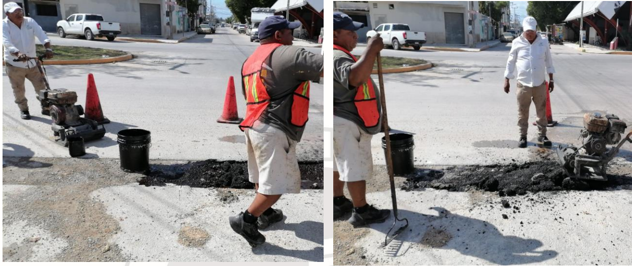
Bacheo: Av. satélite sur entre calle gama; colonia lak'iin.
