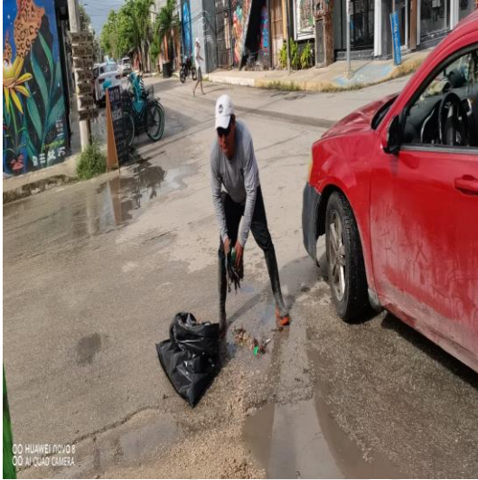
Limpieza de rejillas: Calle sol oriente entre calle beta sur; colonia centro norte.
