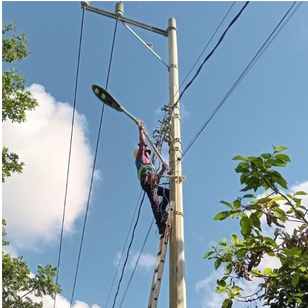
REHABILITACIÓN DE LAMPARAS OV-15; MANUEL ANTONIO AY.
