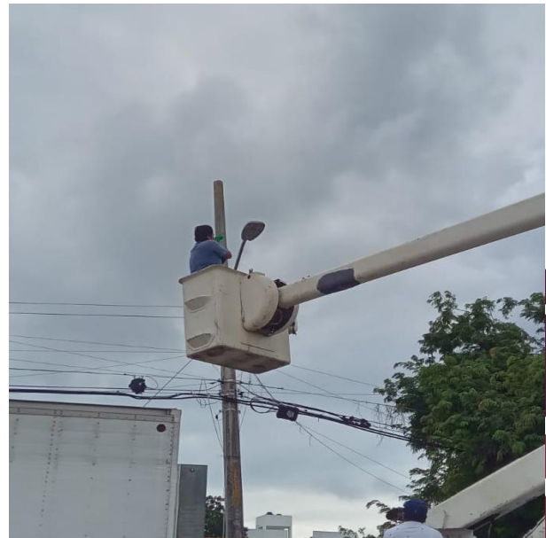
RECONEXIÓN DE LUMINARIA APAGADA POR SULFATO, CALLE BETA NORTE; COLONIA MAYAPAX
