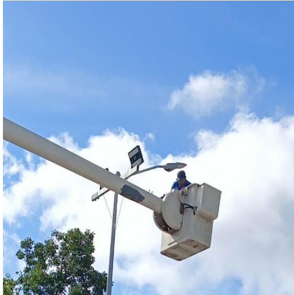
INSTALACIÓN DE LAMPARA LED CON BRAZO; CALLE AZUCENA, COL. YA'AX TULUM.
