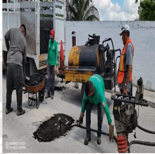
Bacheo; Calle 4 oriente entre calle alfa norte y calle júpiter norte, colonia centro.
