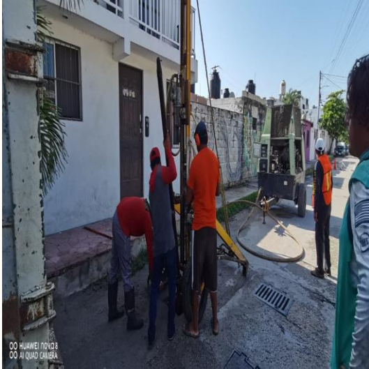
Desazolve de pozos; Calle neptuno oriente entre gama y orión sur, colonia lak'iin.
