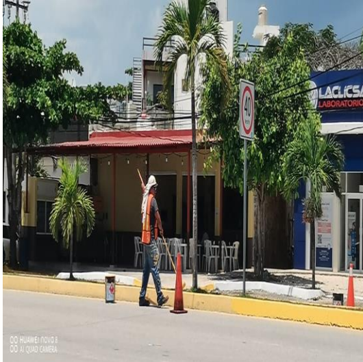
Pintura; Av. Tulum entre calle centauro sur, calle palenque y calle saturno sur.
