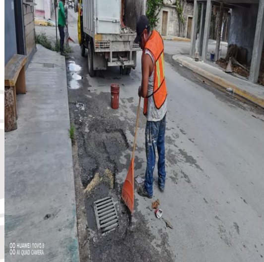
Limpeza de rejillas; Calle andrómeda oriente entre la av. satélite y la calle centauro.
