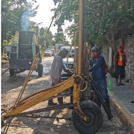
Desazolve de pozos; Calle sagitario oriente entre calle centauro norte y av. Satélite, colonia centro.
