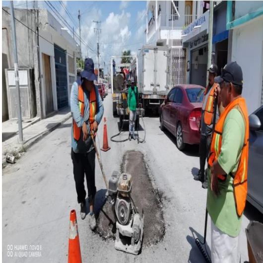
Bacheo; Calle 4 oriente entre la calle orión norte y calle beta norte, colonia centro norte.
