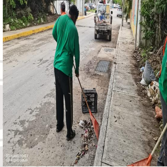
Limpieza de rejillas; Calle 3 sur entre la calle 2 oriente a y la calle 2 oriente.
