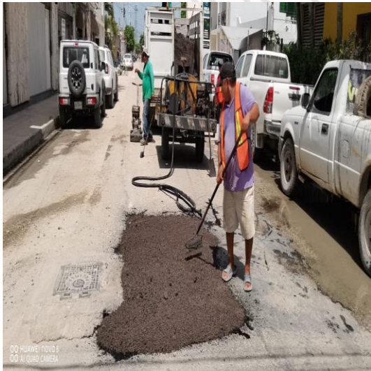
Bacheo; Calle sol oriente entre calle géminis sur y av. satélite, colonia centro sur.
