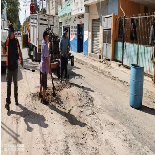
Bacheo; Calle mercurio oriente entre calle acuario sur, colonia centro sur.
