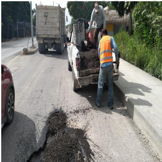
Bacheo; Comunidad Macario Gómez.
