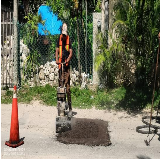
Bacheo; Calle géminis norte entre calle sagitario oriente y calle 2 poniente, colonia centro norte.
