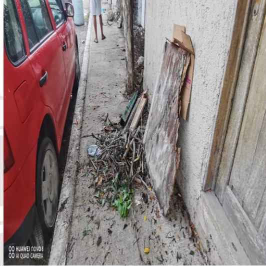
Limpeza de rejillas; Calle luna poniente entre la calle leo sur y la calle aries sur.
