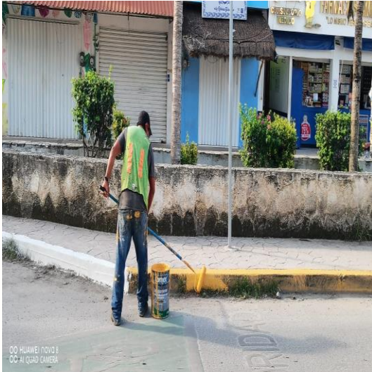
Pintura; Camellón central de la av. Tulum y sus laterales de la calle júpiter hasta la calle alfa.
