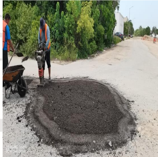
Bacheo; Calle jaaleeb entre la calle palma Tulum y calle sacxikin, fraccionamiento xul kaa.
