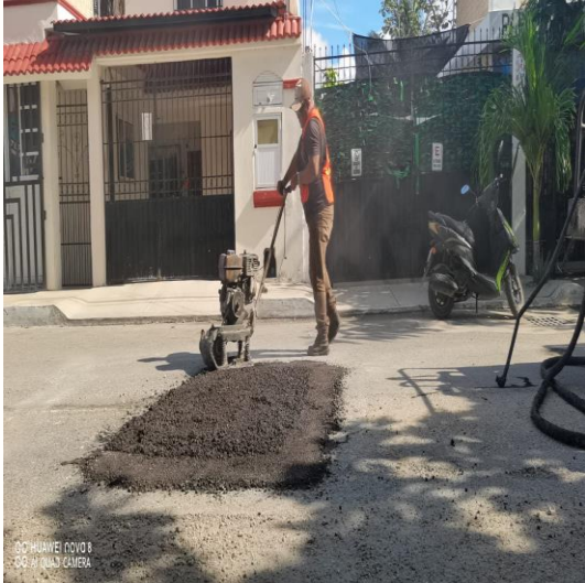
Bacheo; Calle venus oriente entre calle centauro sur y av. Satélite, colonia centro.
