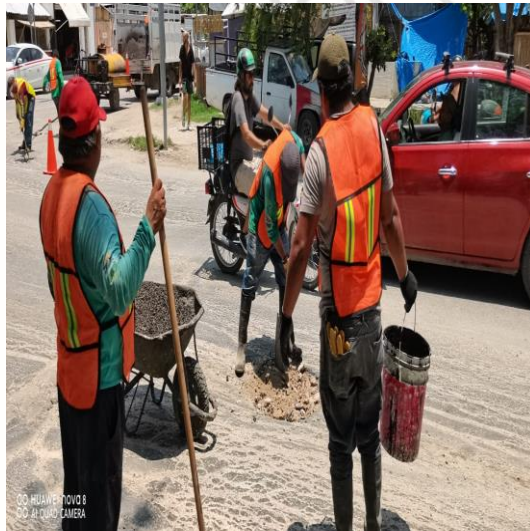
Bacheo; Calle Osiris norte entre av. ook-k'ot y av. Kukulkán, colonia centro.
