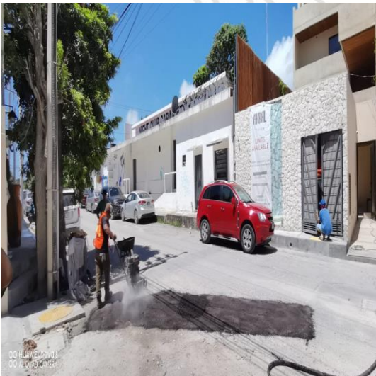
Bacheo; Calle libra norte entre av. Tulum y calle polar poniente, colonia centro norte.
