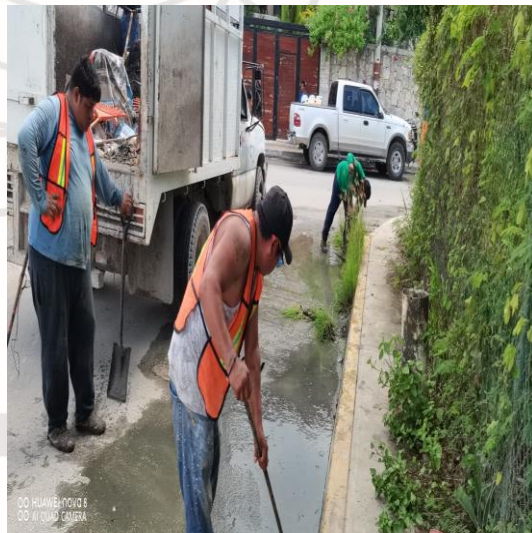
Limpeza de rejillas; Calle plutón entre la calle omega sur y la calle alfa sur.
