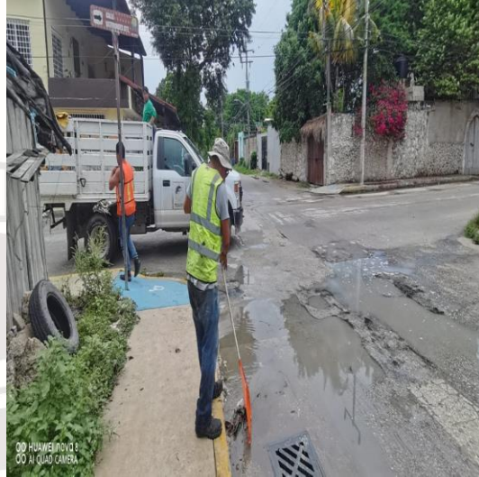
Limpeza de rejillas; Calle asteroides oriente entre la calle Orión sur y la calle beta sur.
