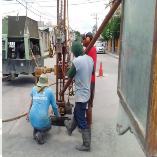
Desazolve de pozos; Calle tun-kul entre calle osiris norte, colonia maya pax.
