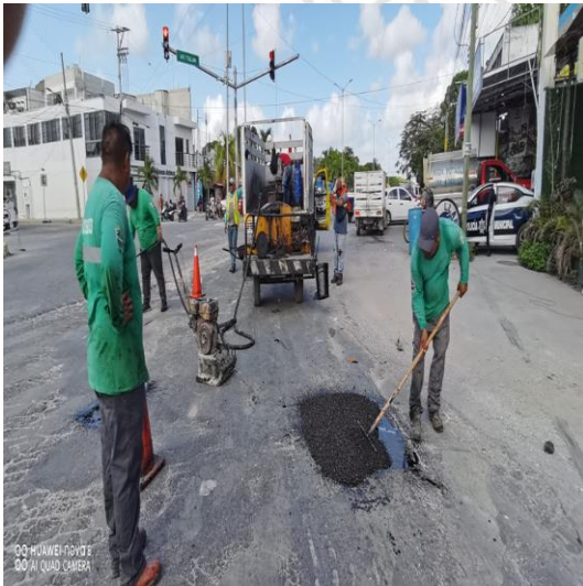
Bacheo; Av. Kukulcán entre av. Tulum, colonia centro norte.
