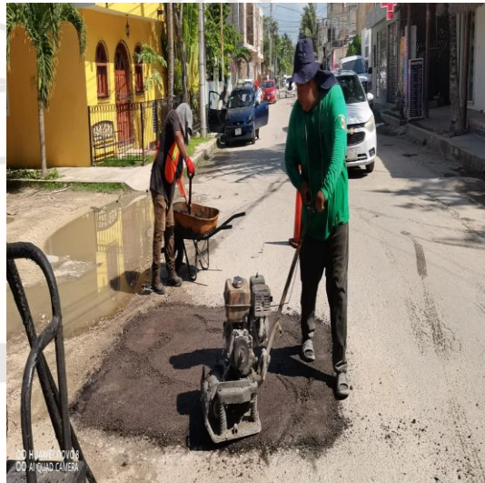
Bacheo; Calle palenque entre calle ontario y calle 7 sur, colonia veleta.
