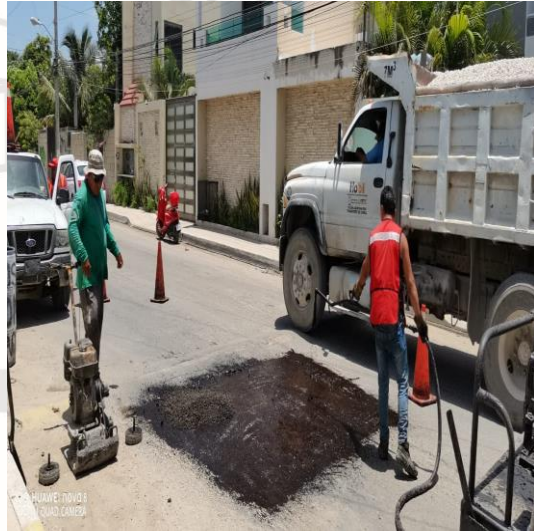
Bacheo; Calle golondrina entre calle sian kan y calle chanchen, colonia tumben kaa.
