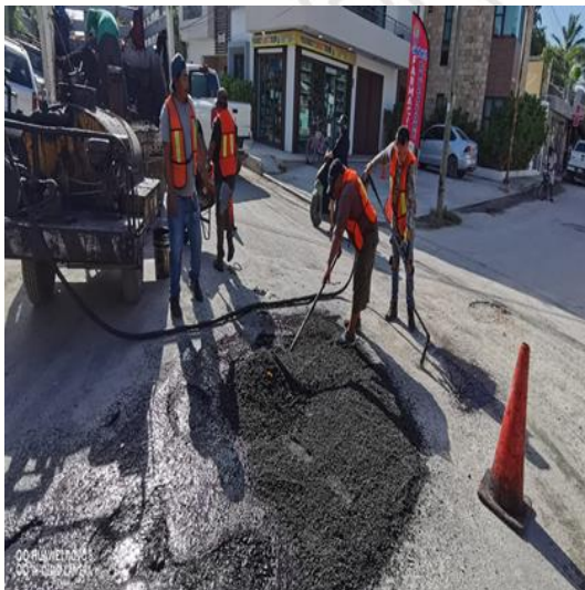
Bacheo; Calle palenque ente calle Ontario y av. coba, colonia veleta.
