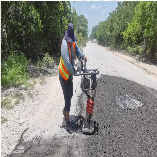
Bacheo; Calle 4 norte entre calle Palmas Tulum, fraccionamiento palmas.
