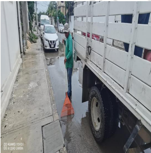
Limpieza de rejillas; Calle sagitario Oriente entre calle Orión Norte y centauro Norte.
