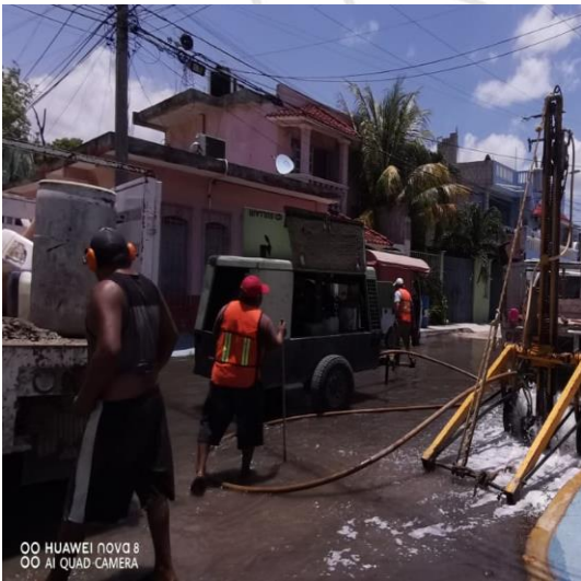
Desazolve de pozos; Calle ori3n sur entre calle asteroides y calle gama oriente, colonia lak'iin.
