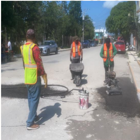
Bacheo; Calle tun-k'ul entre osiris norte y calle alfa norte, colonia centro.
