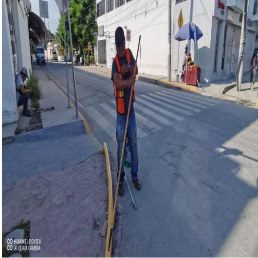
Pintura; Av. Tulum entre calle centauro sur, calle palenque y calle saturno sur.
