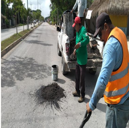
Bacheo; Comunidad Macario Gómez.
