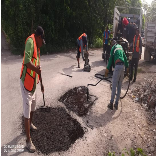
Bacheo; Calle 2 poniente entre calle acuario norte y calle júpiter norte, Colonia centro norte.
