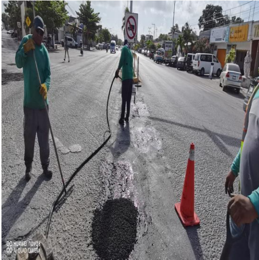
Bacheo; Av. Kukulkán entre av. Tulum, colonia centro norte.
