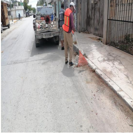
Limpieza de rejillas; Calle gama oriente y calle centauro sur.
