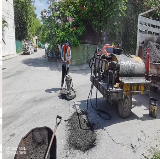
Bacheo; Calle 2 poniente entre calle júpiter norte y calle alfa norte, colonia centro norte.
