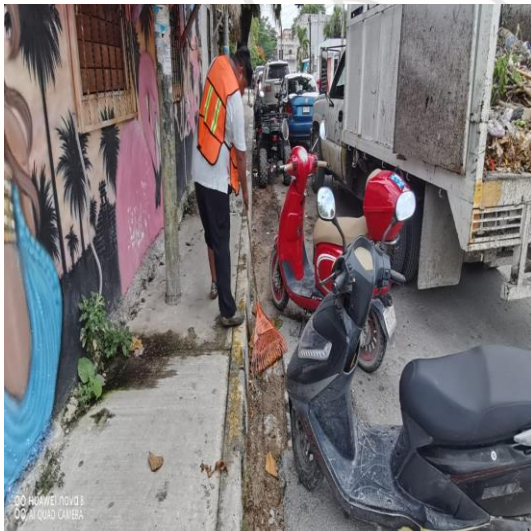
Limpieza de rejillas; Calle andrómeda oriente entre la calle osiris sur y beta sur.
