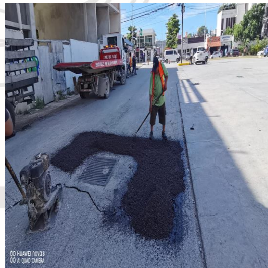
Bacheo; Calle géminis norte entre av. Tulum y calle polar poniente, colonia centro.
