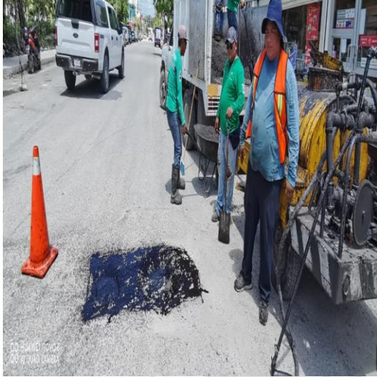
Bacheo; Calle tun-kul entre calle osiris y calle alfa norte, colonia mayapax.
