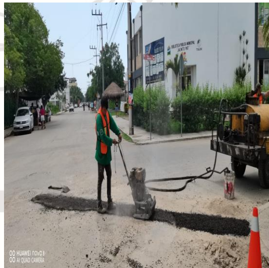
Bacheo; Calle tun-k'ul entre osiris norte y calle alfa norte, colonia centro.
