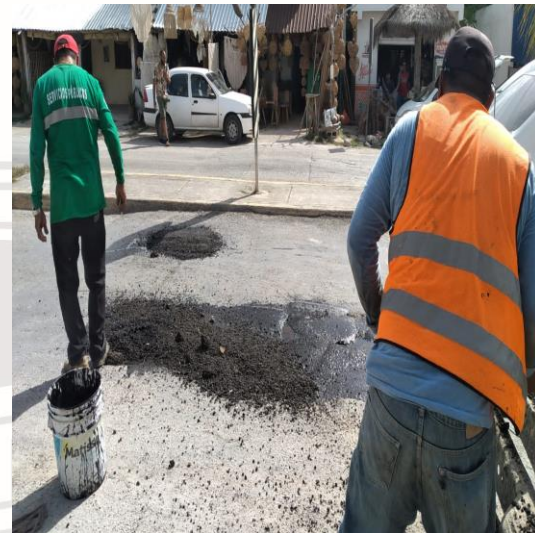
Bacheo; Comunidad Macario Gómez.
