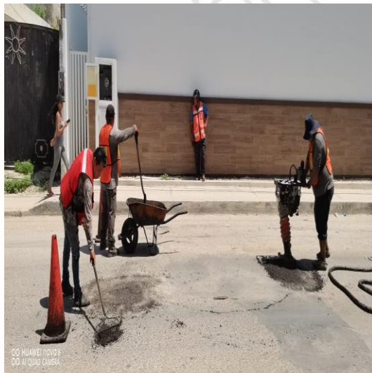
Bacheo; Calle mercurio oriente entre calle centauro y av. satélite sur, Colonia centro sur.
