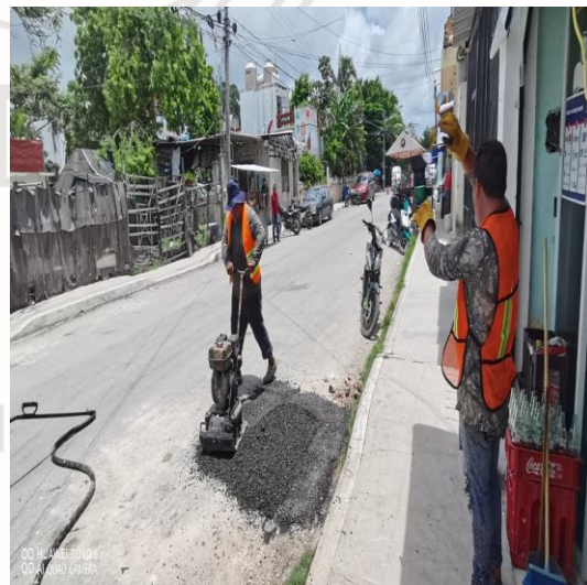
Bacheo; Calle venus oriente entre calle orión sur y calle centauro sur, colonia centro.
