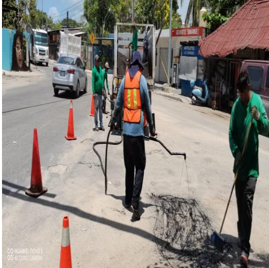
Bacheo; Av. Kukulkán entre av. ook-k'ot y calle Júpiter norte, colonia mayapax.
