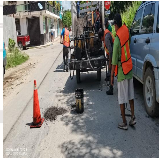
Bacheo; Calle géminis norte entre calle 2 oriente y calle 4 oriente, colonia centro norte.
