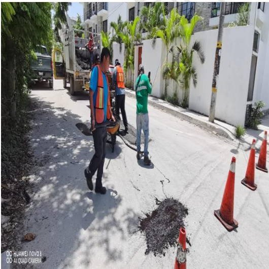
Bacheo; Calle andrómada oriente entre calle libra sur y calle escorpión sur, colonia centro sur.
