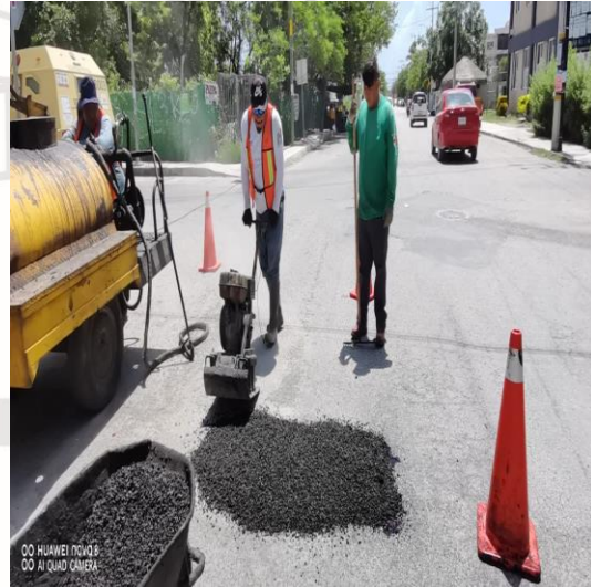
Bacheo; Calle tun-kul entre calle osiris y calle alfa norte, colonia ejido norte.
