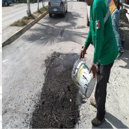
Bacheo; Comunidad Macario Gómez.
