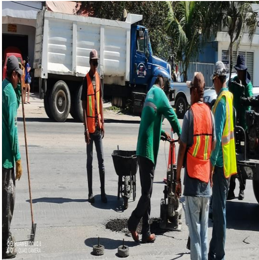
Bacheo; Av. Tulum entre calle asunción y calle palenque, colonia centro sur.
