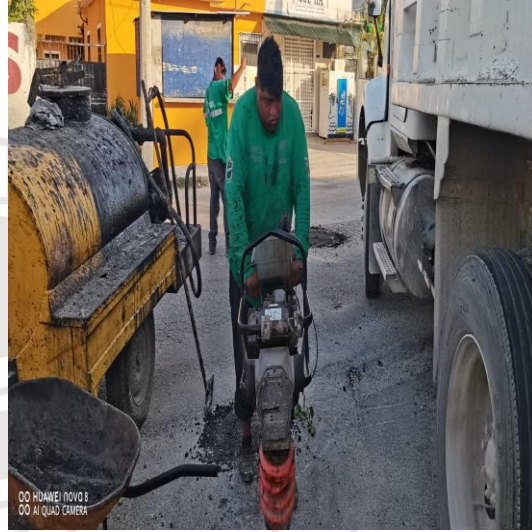
Bacheo; Av. Kukulcán entre calle saturno norte y calle polar poniente, colonia luna.
