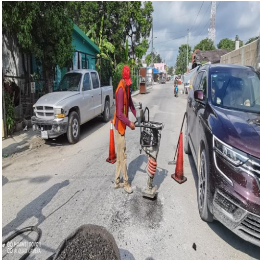
Bacheo; Calle venus oriente entre calle av. osiris sur y calle beta sur, colonia centro.
