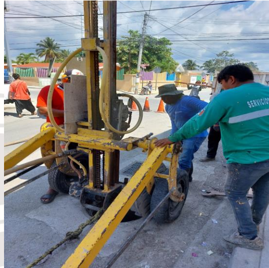
Desazolve de pozos; Calle 2 oriente entre calle beta norte y sagitario oriente, colonia centro.
