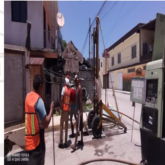
Desazolve de pozos; Calle beta sur entre calle asteroides oriente, colonia lak'iin.
