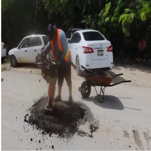
Bacheo; Calle jaaleeb entre calle palma Tulum y calle sacxikin, fraccionamiento xul kaa.
