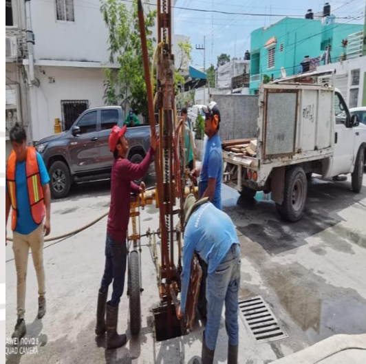
Desazolve de pozos; Calle 2 oriente entre calle escorpión norte, fraccionamiento guerra de castas.
