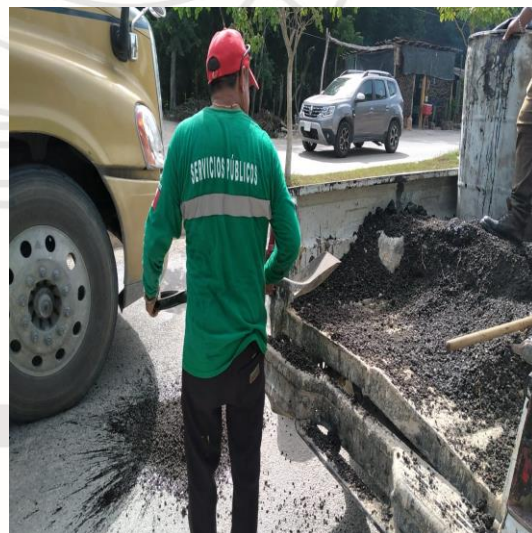
Bacheo; Comunidad Macario Gómez.
