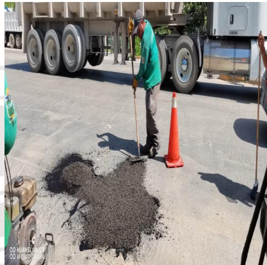
Bacheo; Av. Tulum entre calle asunción y calle palenque, colonia centro sur.
