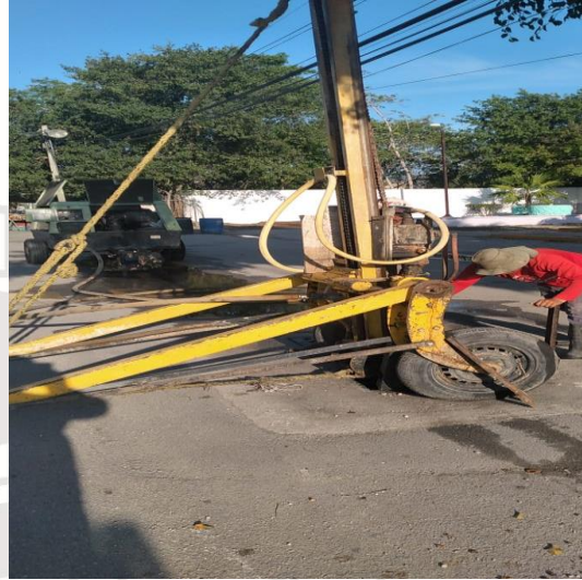
Desazolve de pozos; Calle tun-k'ul entre calle beta norte y calle chikil, colonia mayapax.
