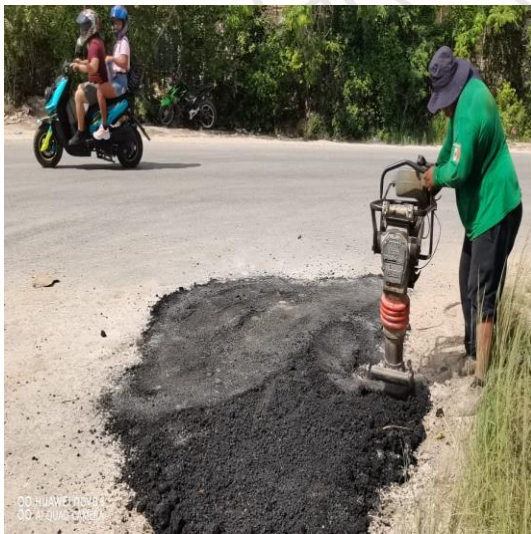
Bacheo; Calle 2 norte entre calle 2 bis, fraccionamiento palmas.
