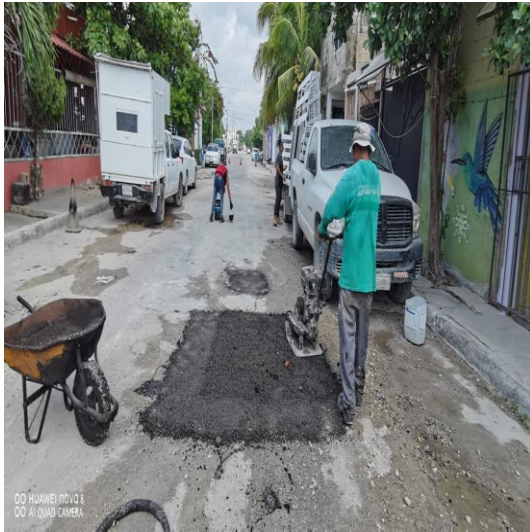
Bacheo; Calle nabal entre calle naal y calle omm, colonia tumben kaa.
