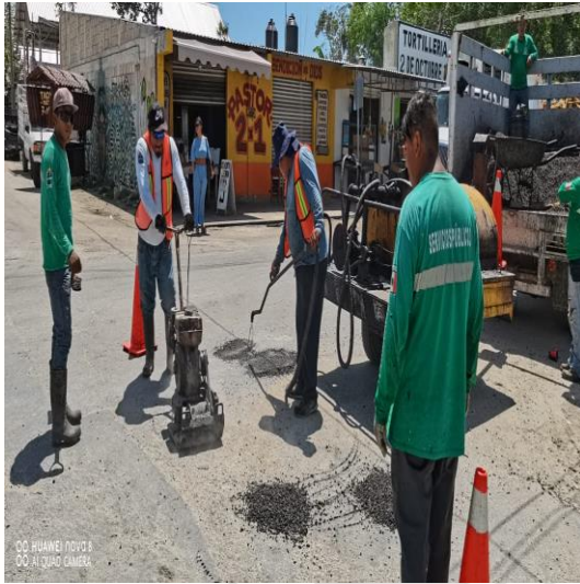
Bacheo; Av. kulkán entre chanchen y av. ook-k'ot, colonia ejido norte.
