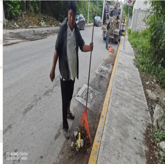
Limpieza de rejillas; Calle 3 sur entre la calle 2 a bis oriente y av. Tulum.
