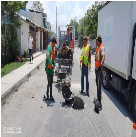
Bacheo; Calle Osiris norte entre av. ook-k'ot y av. Kukulkán, colonia centro.
