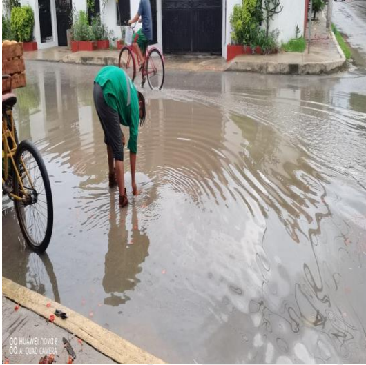
Limpeza de rejillas; Calle júpiter sur entre la calle luna poniente y calle leo sur.
