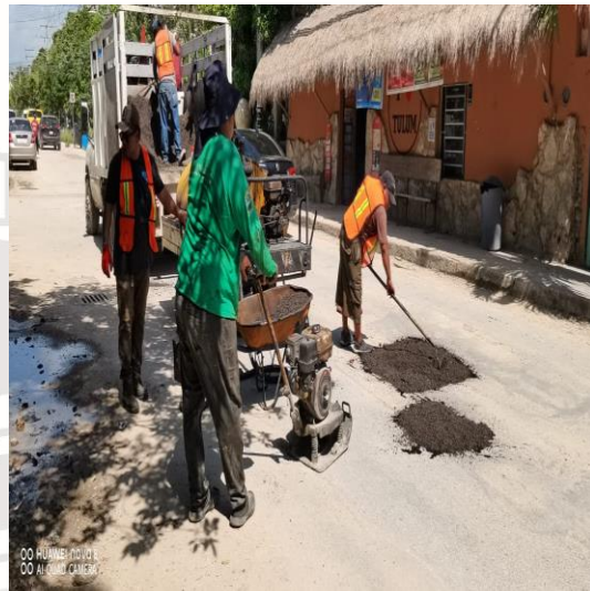
Bacheo; Calle 7 sur entre calle 14, colonia veleta.
