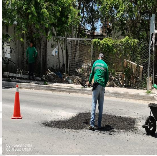
Bacheo; Av. ook-k'ot entre calle alfa norte y calle mega norte, colonia mayapax.
