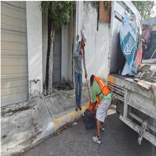
Limpeza de rejillas; Calle mercurio poniente entre la calle saturno poniente y la calle luna sur.
