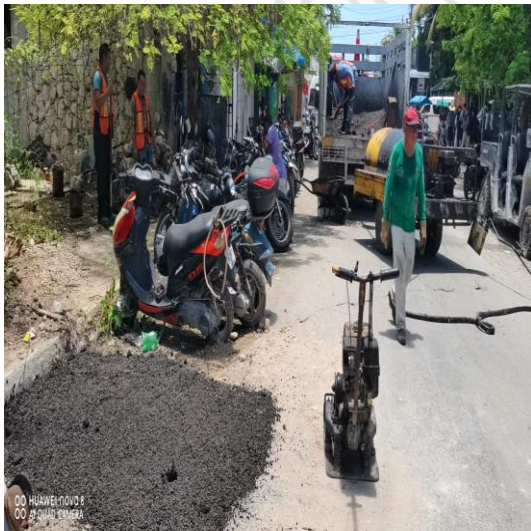
Bacheo; Calle venus oriente entre calle beta sur y calle orión sur, colonia centro.
