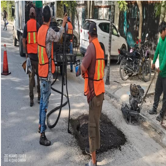
Bacheo; Av. kulkán entre av. Juanek y calle 16, colonia veleta.
