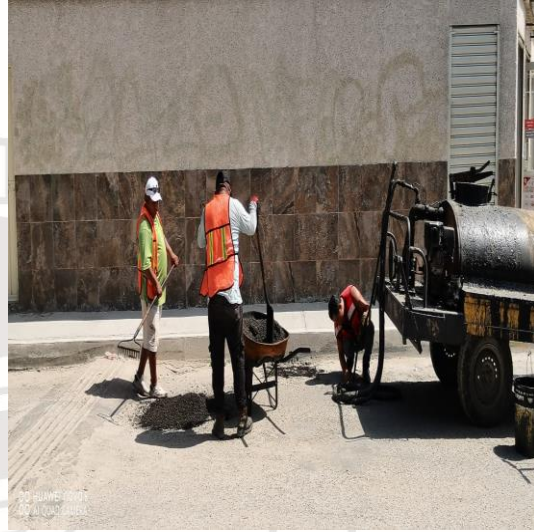
Bacheo; Calle faisán entre calle 26 y av. Selva, colonia tumben kaa.
