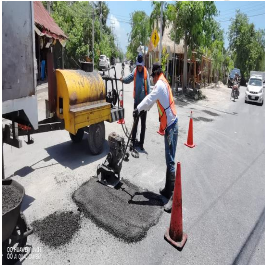
Bacheo; Av. kukulkán entre av. ook-k'ot y calle Júpiter norte, colonia mayapax.
