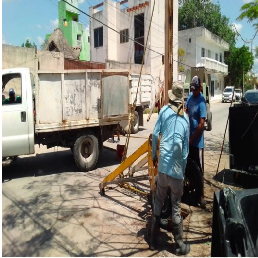
Desazolve de pozos; Calle centauro norte entre calle polar oriente, colonia centro.
