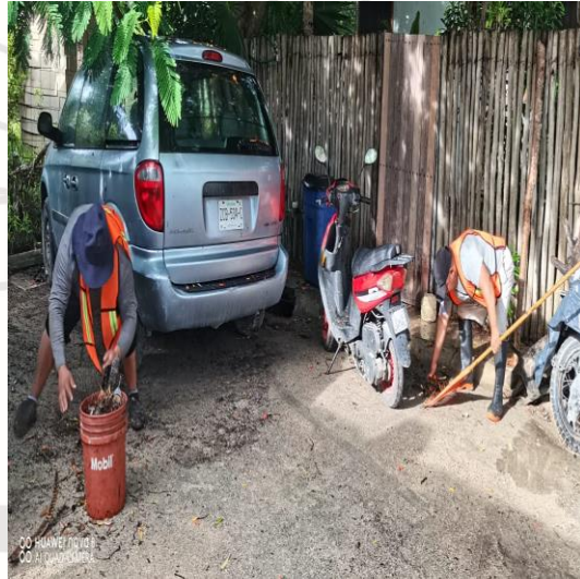
Limpeza de rejillas; Calle chemuyil entre 4 oriente.
