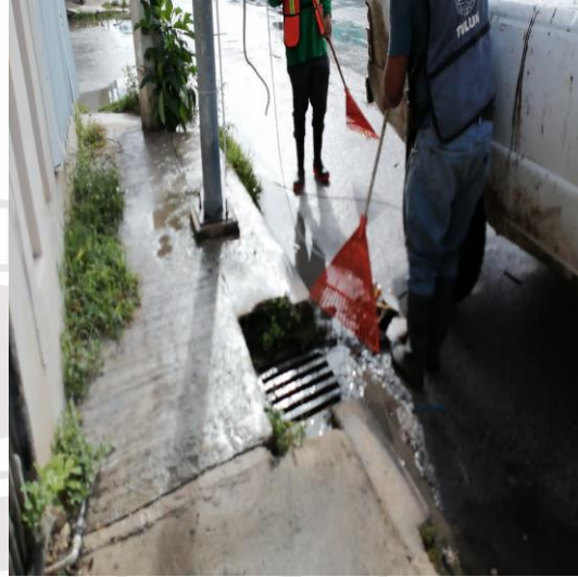
Limpieza de rejillas; Calle sagitario oriente entre beta norte.
