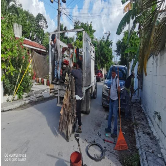
Limpeza de rejillas; Calle 17 entre la calle 4 oriente y la calle 2 bis oriente.
