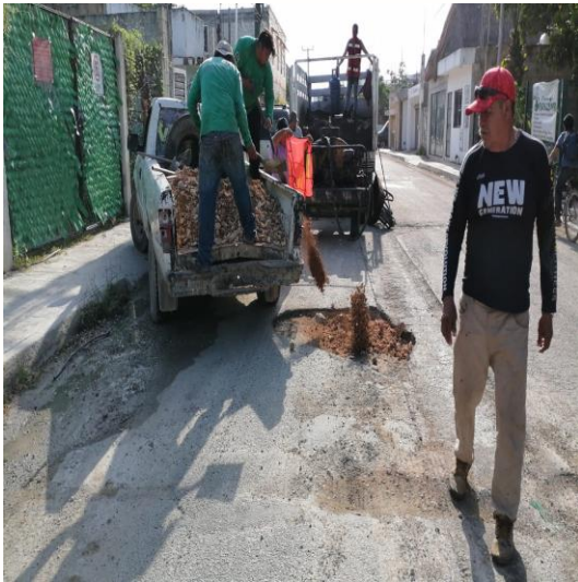
Bacheo; Calle polar oriente entre calle osiris norte y calle beta norte, colonia centro norte.
