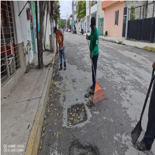
Limpeza de rejillas; Calle neptuno oriente entre la av. satélite sur y la calle centauro sur.
