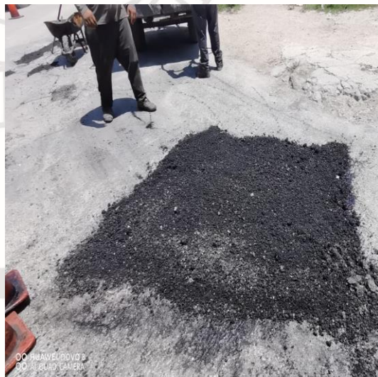
Bacheo; Calle venus oriente entre calle orión sur y calle centauro sur, Colonia centro.
