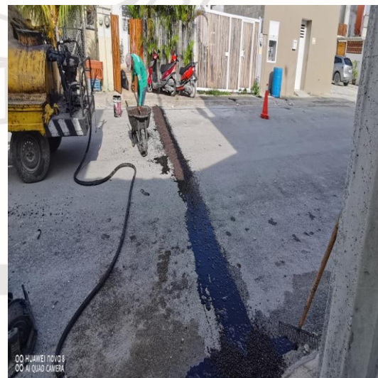
Bacheo; Calle guinea entre calle palma rapis, fraccionamiento palmas.
