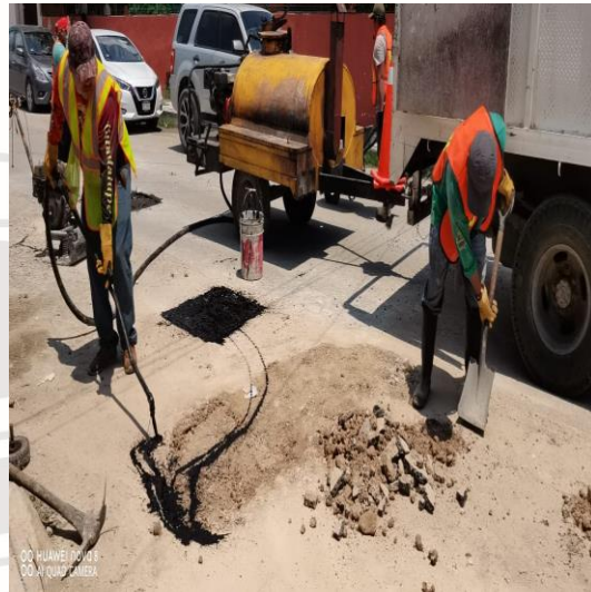
Bacheo; Calle 2 poniente entre calle osiris norte y calle beta norte, colonia centro.
