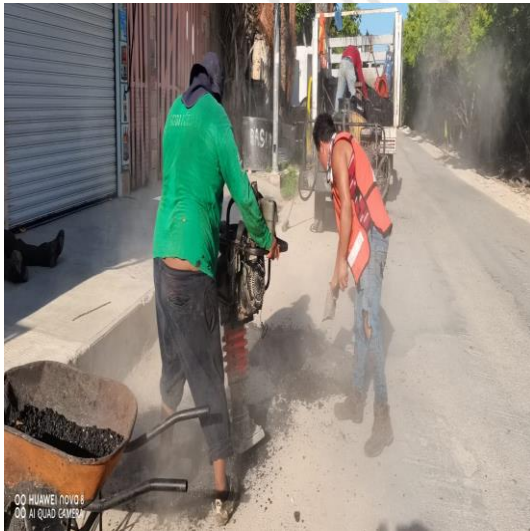
Bacheo; Calle 4 norte entre calle 5 bis y av. 10, fraccionamiento palmas.
