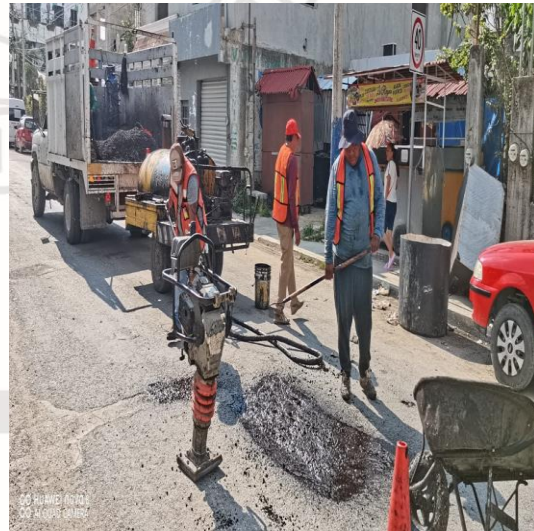
Bacheo; Calle venus oriente entre calle av. osiris sur y calle beta sur, colonia centro.
