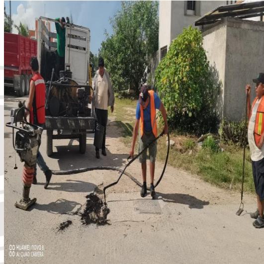
Bacheo; Calle Jaaleeb entre la calle Tz'uib, fraccionamiento xul kaa.
