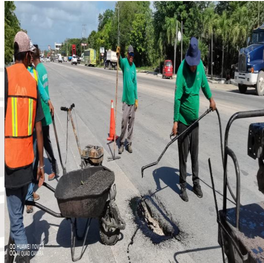
Bacheo; Av. Tulum entre calle asunción y calle palenque, colonia centro sur.
