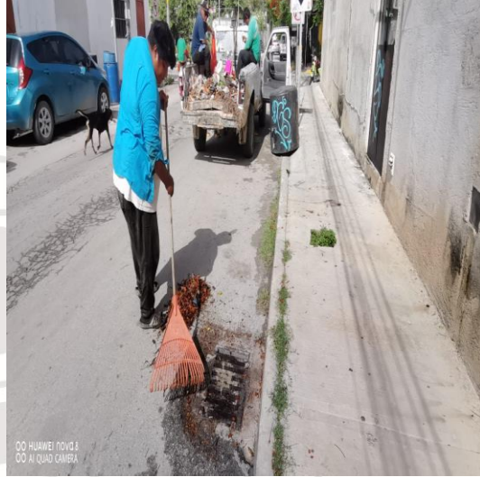
Limpieza de rejillas; Calle sagitario oriente entre la calle Osiris y la calle alfa norte.
