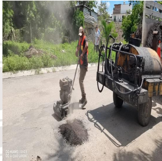
Bacheo; Calle 2 poniente entre calle géminis norte, colonia centro norte.
