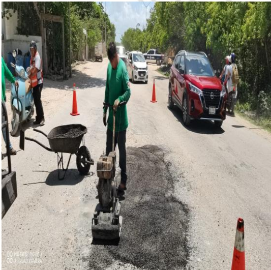
Bacheo; Av. selva entre calle chan caah y calle kohunlich, colonia tumben kaa.
