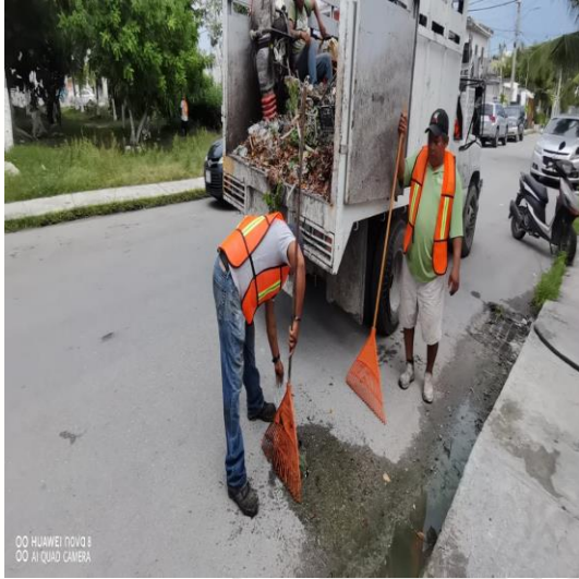
Limpieza de rejillas; Calle huracanes Janeth entre la calle huracanes mitch y huracanes paulina.
