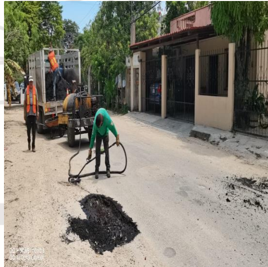
Bacheo; Calle chemuyil entre calle chichen Itzá y akumal, colonia ejido norte.
