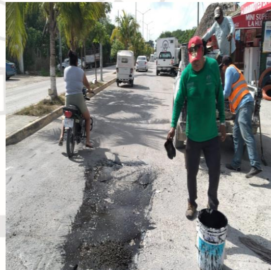
Bacheo; Comunidad Macario Gómez.
