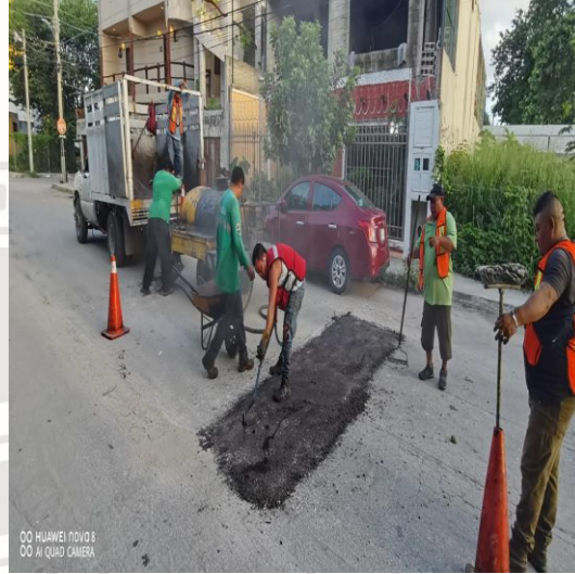
Bacheo; Calle neptuno oriente entre calle osiris sur y calle alfa sur, colonia centro.
