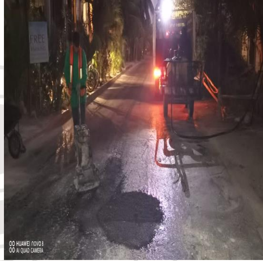
Bacheo; Hotel tago hasta los arcos, zona costera.
