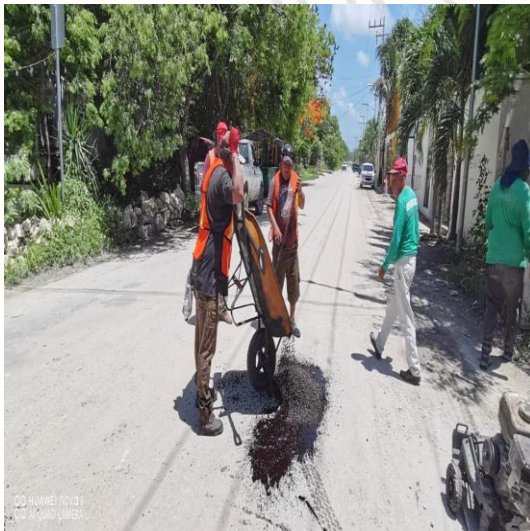
Bacheo; Calle 7 sur entre calle 12 y calle 10 sur, colonia veleta.
