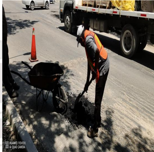
Bacheo; Calle osiris norte entre av. ook-k'ot y av. kukulkán, colonia mayapax.
