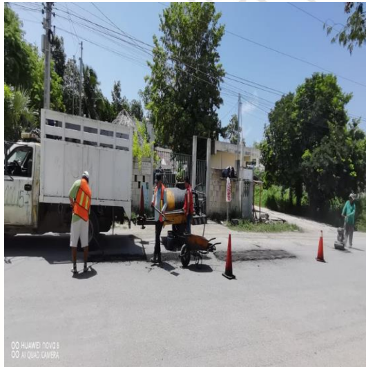
Bacheo; Av. selva entre calle venado y calle jaguar, colonia tumben kaa.
