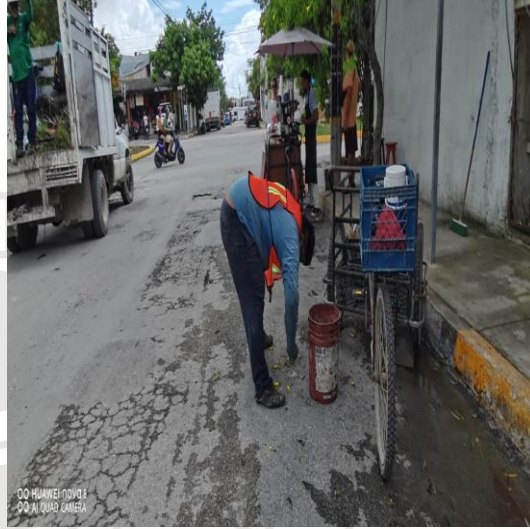
Limpeza de rejillas; Calle venus oriente entre la calle centauro sur y la av. satélite.
