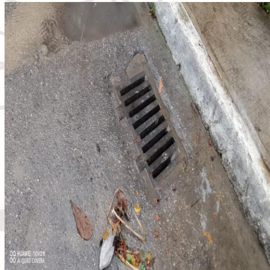
Limpieza de rejillas; Calle sagitario Oriente entre la calle géminis norte y la Av. Satélite.
