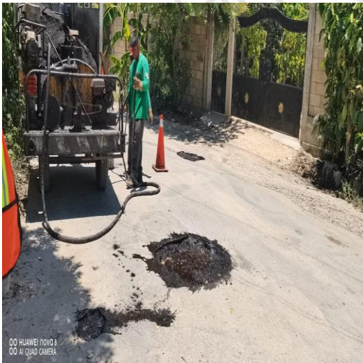
Bacheo; Calle xcaret entre av. kukulkán y calle chemuyil, colonia ejido norte.
