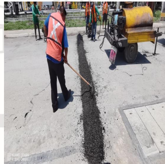
Bacheo; Calle boulevard palmas Tulum entre calle palma yagua, fraccionamiento palmas.
