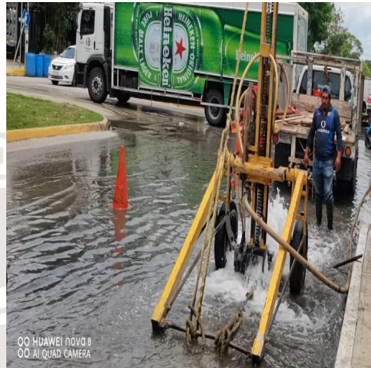
Desazolve de pozos; Av. satélite entre polar poniente y calle sagitario, colonia cetro.
