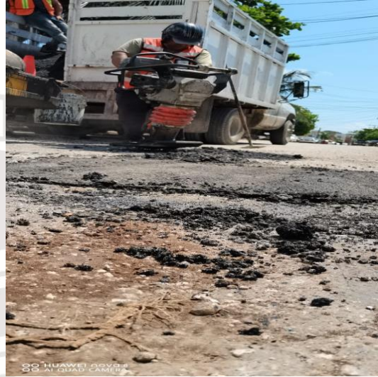
Bacheo; Calle júpiter norte entre calle le´xiu y av. Kukulkán, colonia centro.
