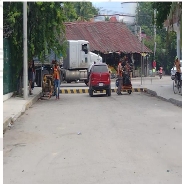
Calle júpiter norte entre av. Tulum y av. Ook-k'ot (altura de cárcamo).
