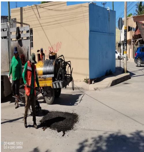
Bacheo; Calle mercurio poniente entre la calle acuario sur y Júpiter sur.
