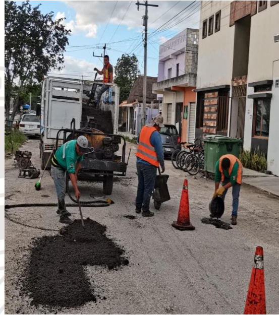
Bacheo; Calle ontario entre kukulkan y saturno.
