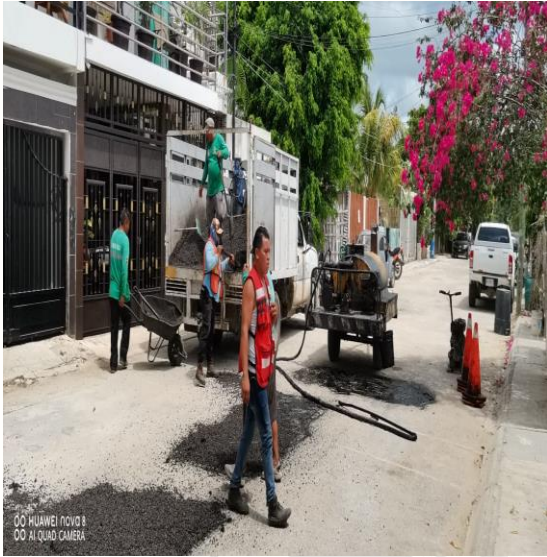
Bacheo; Fraccionamiento Villas Tulum. Calle chemuyil entre la calle 4 oriente y la calle 17
