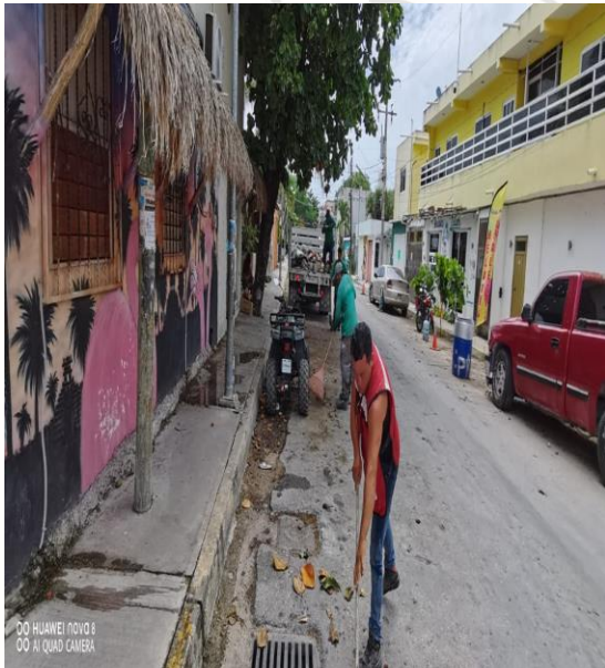
Limpeza De Rejillas: Calle Andromeda oriente entre la calle Osiris norte y la calle beta sur
