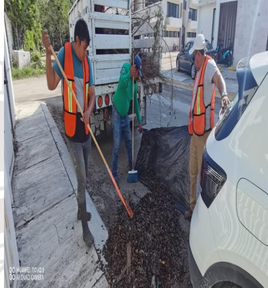
Limpeza de rejillas; Calle 5 sur entre calle 4 oriente y la calle 2 a oriente
