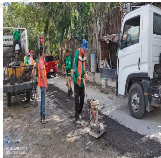
Bacheo; Calle mercúrio oriente entre escorpión sur y av coba
