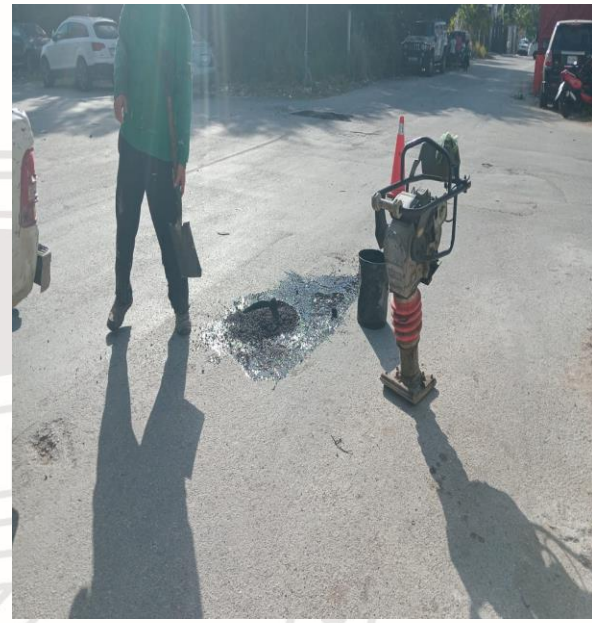
Bacheo; Calle 2 oriente entre géminis norte y escorpión norte.
