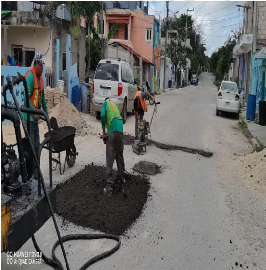
Bacheo; Calle caleta entre yalku y punta venado.
