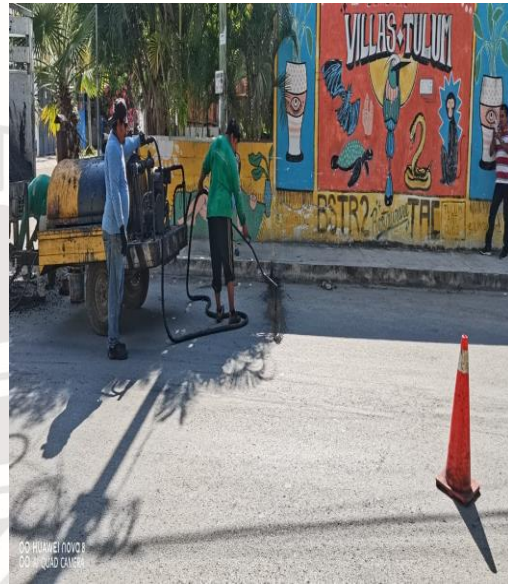
Bacheo; Calle 3 sur entre la calle 2 bis oriente entre av. Tulum
