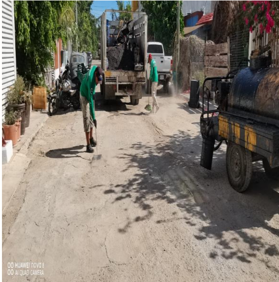
Bacheo; Fraccionamiento Villas Tulum. Calle chemuyil entre la calle 4 oriente y la calle 17
