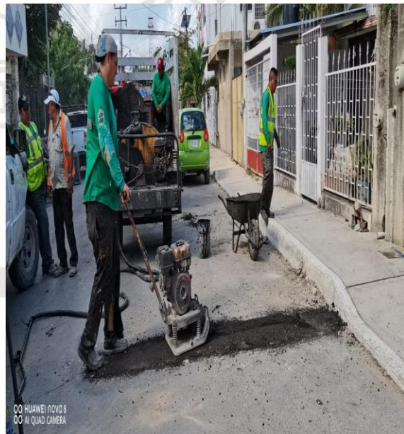
Bacheo; Calle sol oriente entre centauro y ori3n sur.
