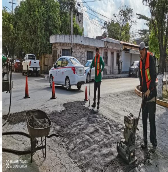
Bacheo; Av satélite sur entre calle andromeda y av Tulum.
