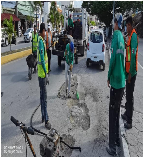
Bacheo; Av Tulum entre centauro sur y av satelite.
