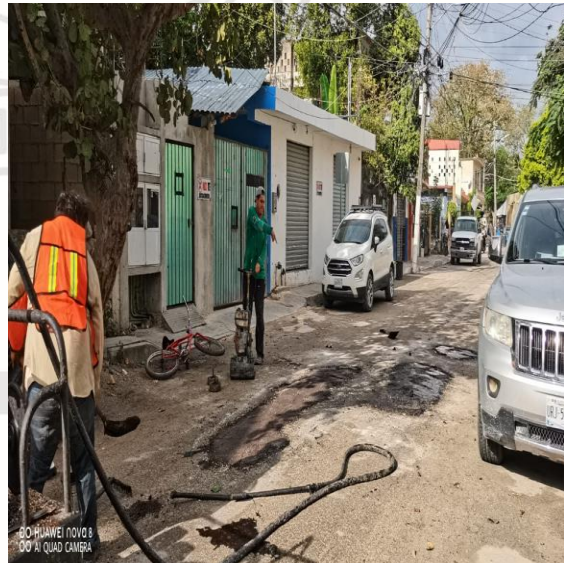
Bacheo; Calle mercúrio poniente entre júpiter y acuario sur.
