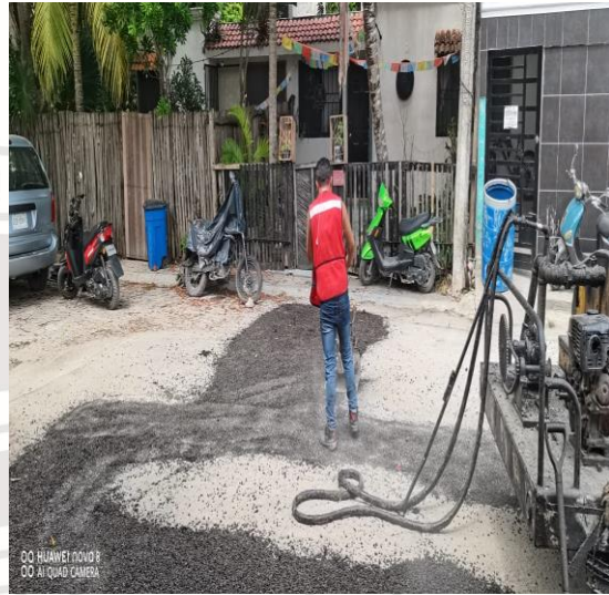
Bacheo; Fraccionamiento Villas Tulum. Calle chemuyil entre la calle 4 oriente y la calle 17
