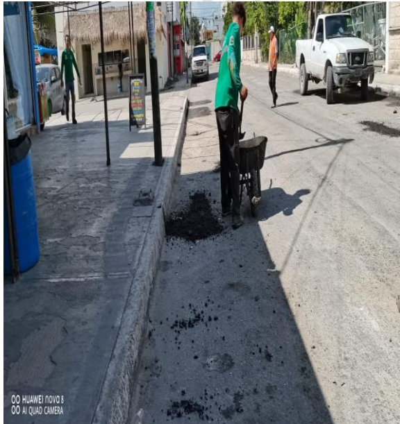
Bacheo; Calle venus oriente entre alfa sur y osiris sur
