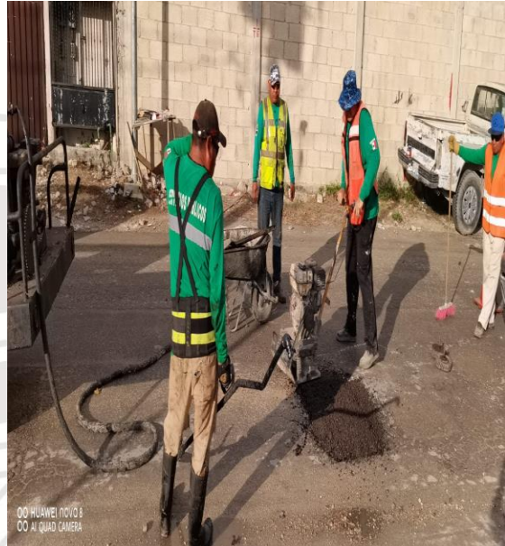
Bacheo; Calle alfa sur entre calle gama oriente y mercúrio.
