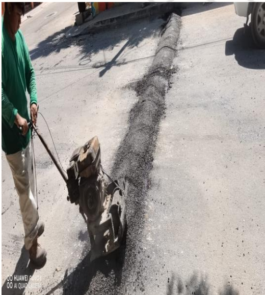
Bacheo; Calle mercurio norte entre Av. Tulum y la calle polar poniente
