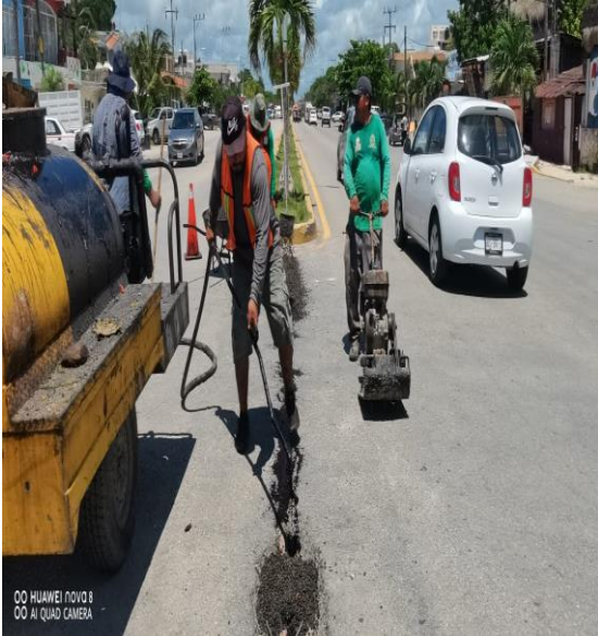
Bacheo; Av. Tulum entre la calle saturno
