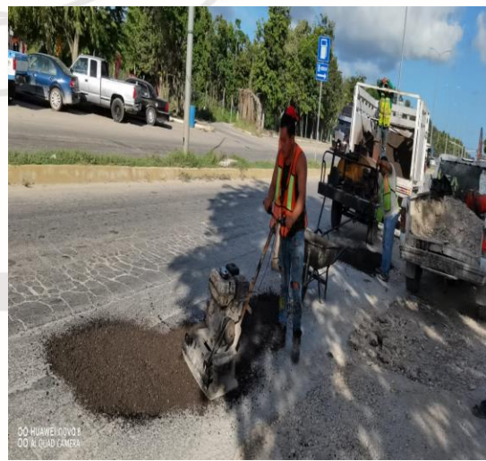
Bacheo; Av. coba entre bubul-ek y av. Okoot.
