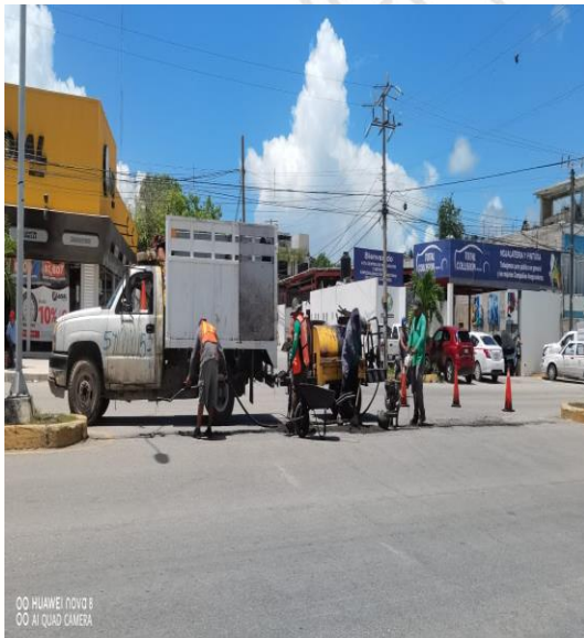
Bacheo; Av. Tulum entre la calle saturno
