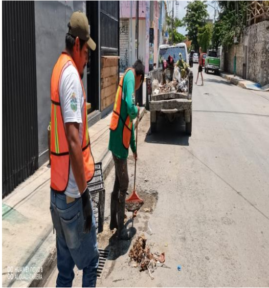
Limpeza de rejillas; Calle sol Oriente entre la calle centauro sur y la calle centauro sur
