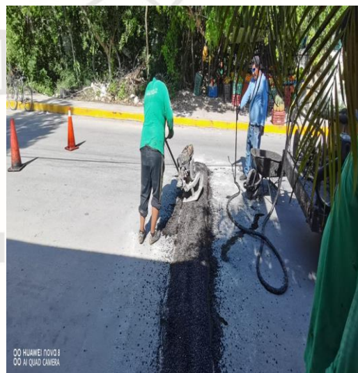
Bacheo; Calle 3 sur entre la calle 2 bis oriente entre av. Tulum
