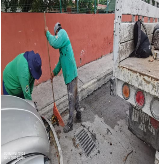
Limpeza De Rejillas: Calle 2 poniente entre la calle Osiris norte y la calle beta norte
