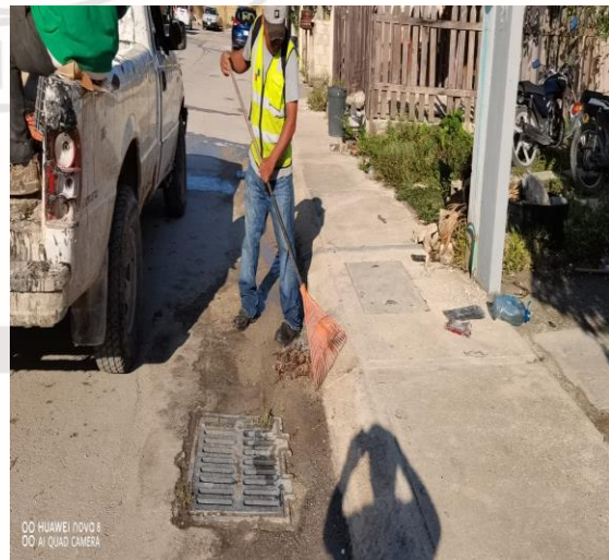
Limpieza de rejillas; Calle palma abanico entre calle bulevar palma y calle palma guinea.
