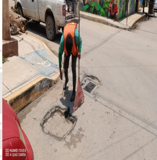
Limpeza De Rejillas: Calle Andromeda oriente entre la calle beta y Orión sur
