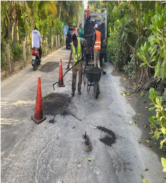
Bacheo; Zona costera (inicio hotel core).
