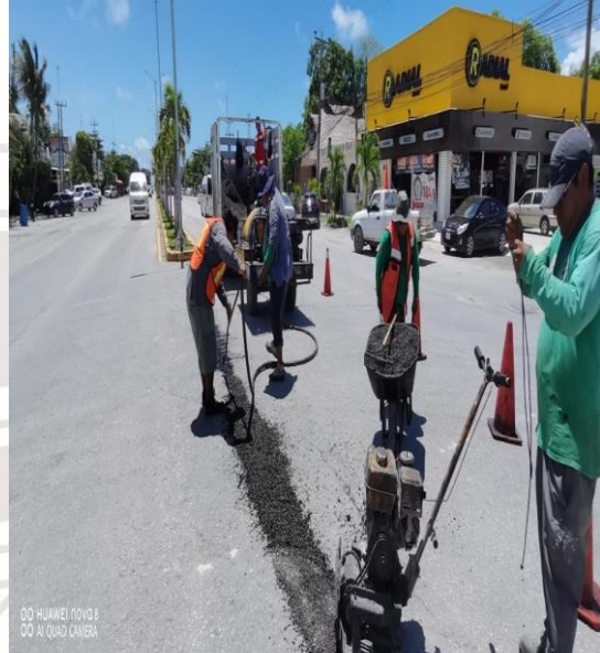
Bacheo; Av. Tulum entre la calle saturno
