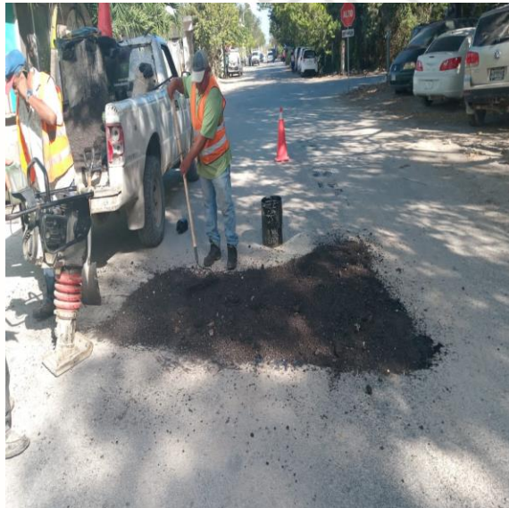
Bacheo; Calle 2 oriente entre géminis norte y escorpión norte.
