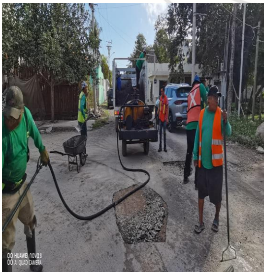
Bacheo; Calle mercúrio oriente entre géminis sur y libra.
