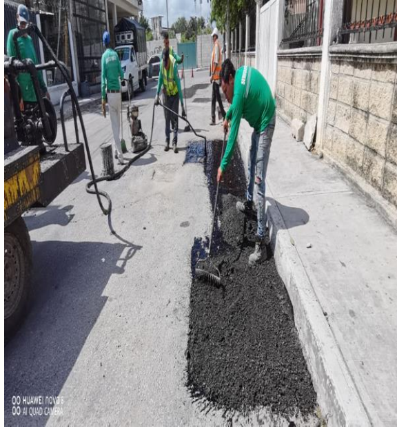
Bacheo; Calle sol oriente entre osiris sur y alfa sur.
