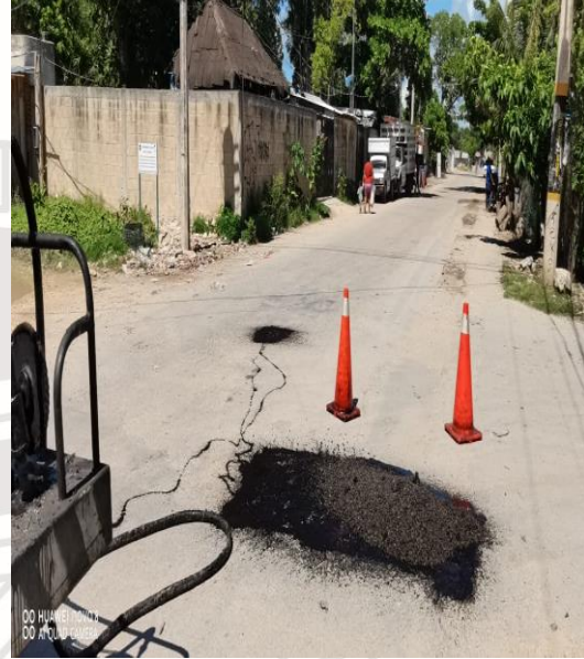
Bacheo; Calle mercurio oriente entre la calle beta sur y orión sur
