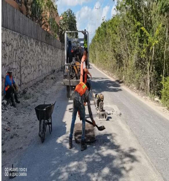
Bacheo; Calle 4 norte entre av 5 y 5 bis.
