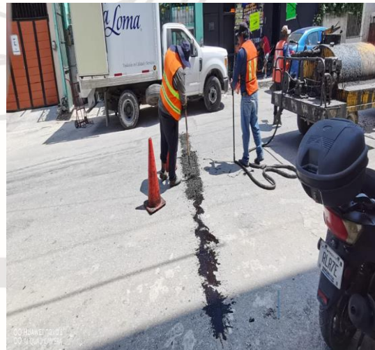
Bacheo; Calle 2 poniente entre la Av. Satellite y calle géminis Norte
