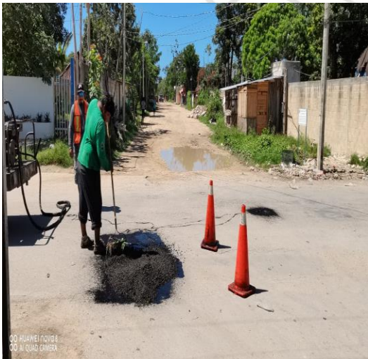
Bacheo; Calle mercurio oriente entre la calle beta sur y orión sur
