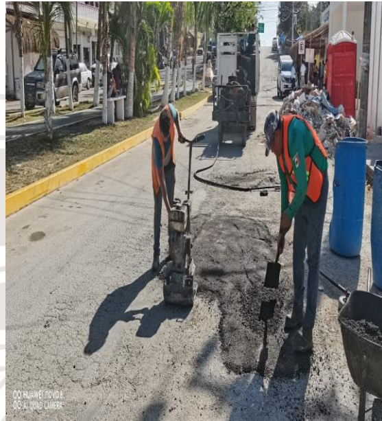
Bacheo; Akumal Pueblo
