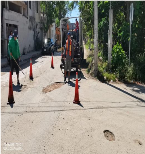
Bacheo; Calle mercurio poniente entre la calle Luna poniente y alfa sur
