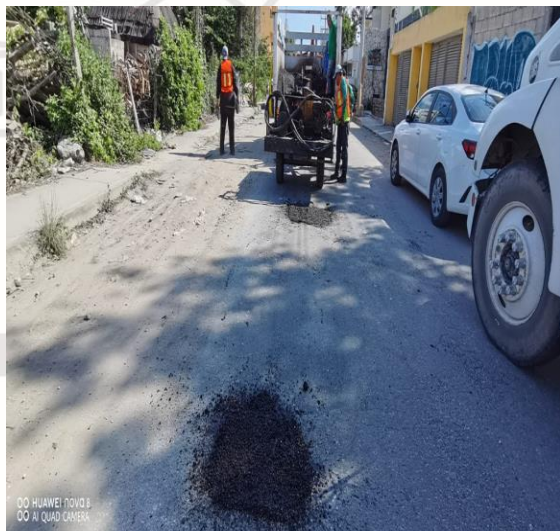
Bacheo; Calle andrómeda oriente entre géminis sur y libra sur.
