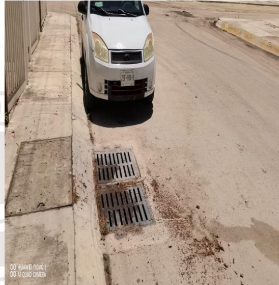
Limpeza De Rejillas: Calle 5 sur entre la calle 2 a oriente y la calle 4 oriente
