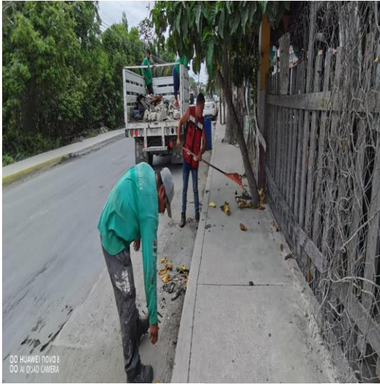
Limpeza De Rejillas: Calle Golondrina entre la Av. sian kan y la calle chan-chen
