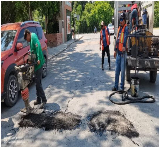
Bacheo; Calle 3 sur entre la calle 2 bis Oriente y la Av. Tulum
