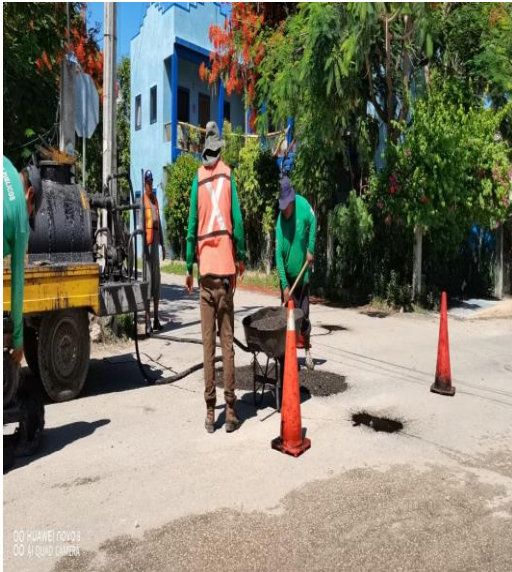
Bacheo; Calle mercurio poniente entre la calle Luna poniente y alfa sur
