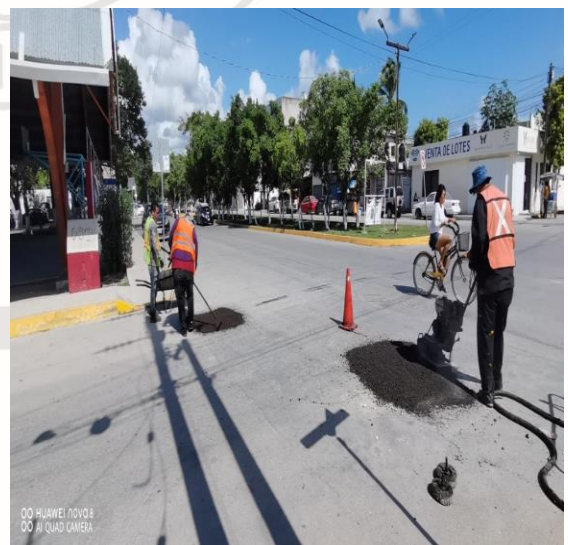
Bacheo; Av satélite entre neptuno oriente y gama oriente.
