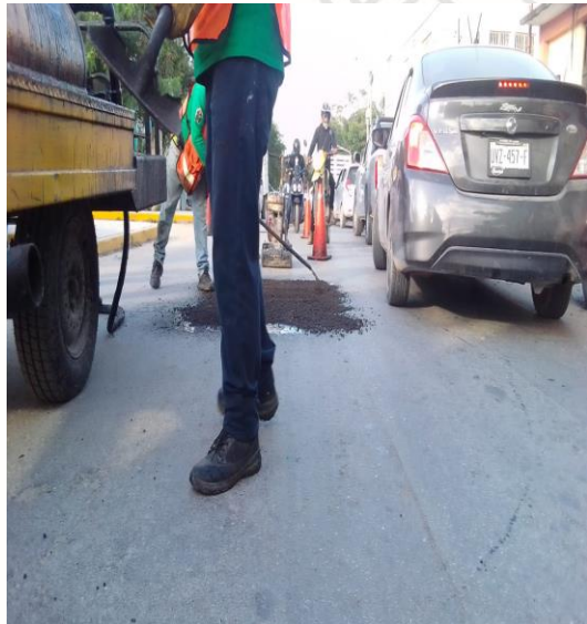
Bacheo; Calle mercúrio entre omega sur.
