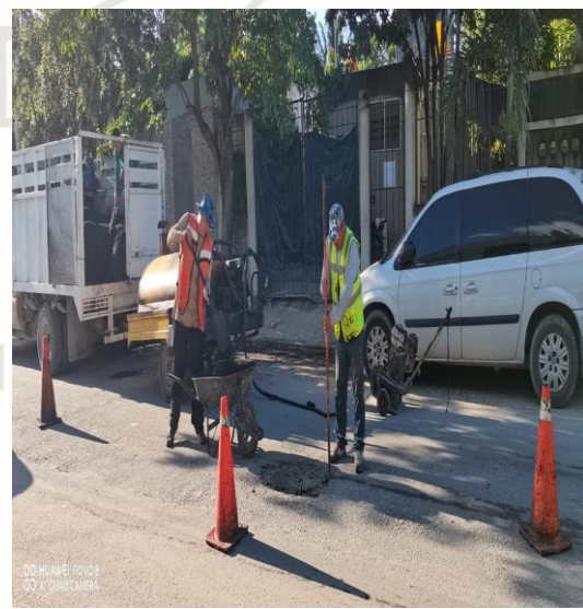
Bacheo; Calle golondrina entre av selva y sian ka'an.
