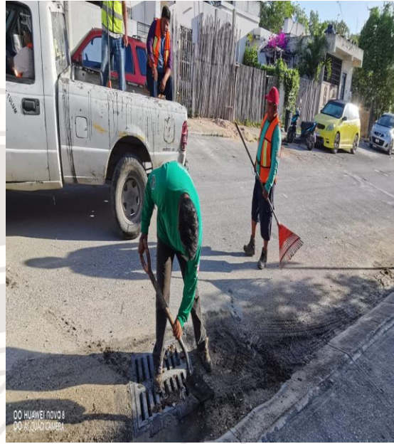
Limpieza de rejillas; Calle palmas chat entre palmas yagua y palmas guinea.
