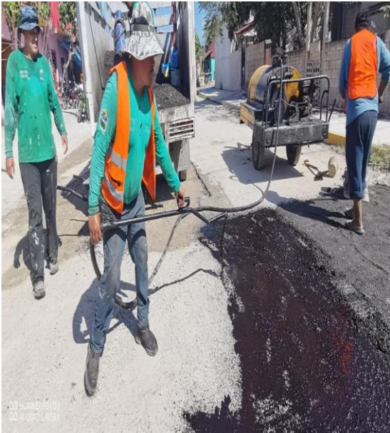
Bacheo; Calle omm entre tepezcuintle.
