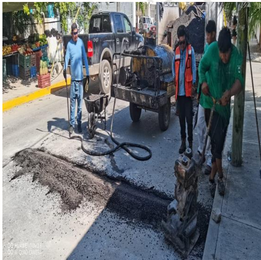
Bacheo; Calle 3 sur entre la calle 2 bis oriente entre av. Tulum
