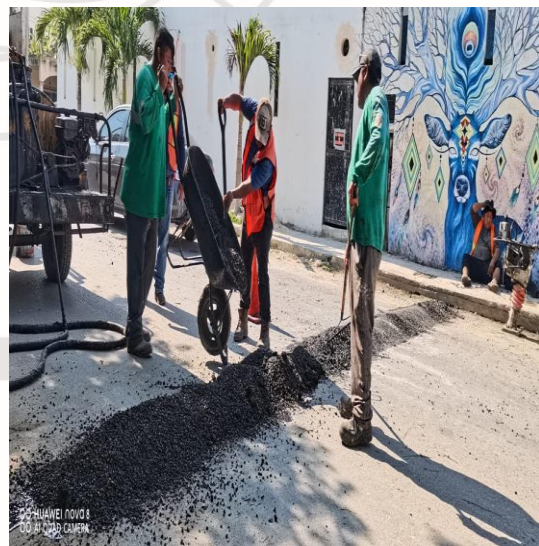
Bacheo; Calle 6 Oriente entre la Av. Coba y la calle 11
