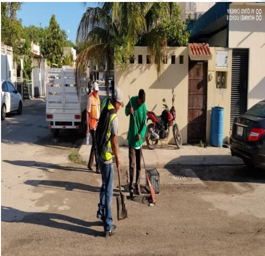
Limpieza de rejillas; Calle guinea entre calle palma rapiz y calle reyna.
