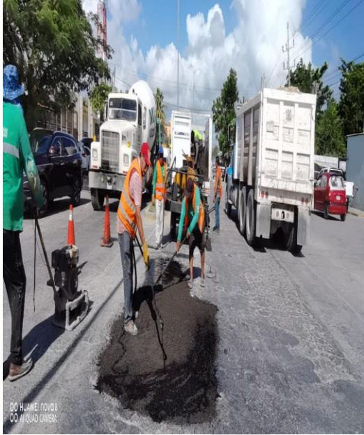
Bacheo; Av. coba oriente entre av. Tulum y polar poniente.
