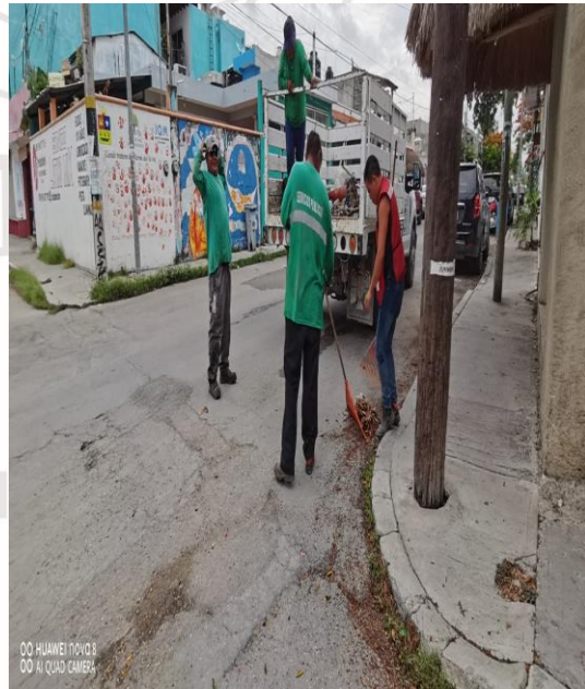
Limpeza De Rejillas: Calle 2 poniente entre la calle alfa norte y la calle Osiris norte
