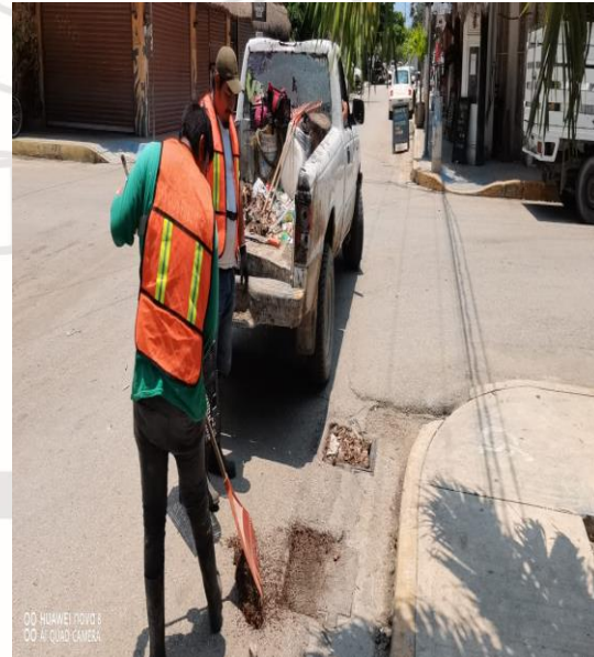
Limpeza De Rejillas: Calle Andromeda oriente entre la calle centauro sur y la avenida satélite
