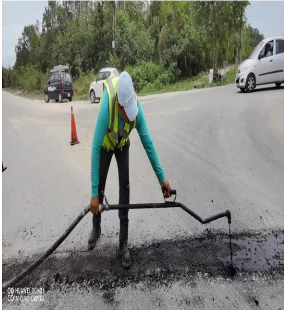
Bacheo; Calle 2 norte entre 10 norte.
