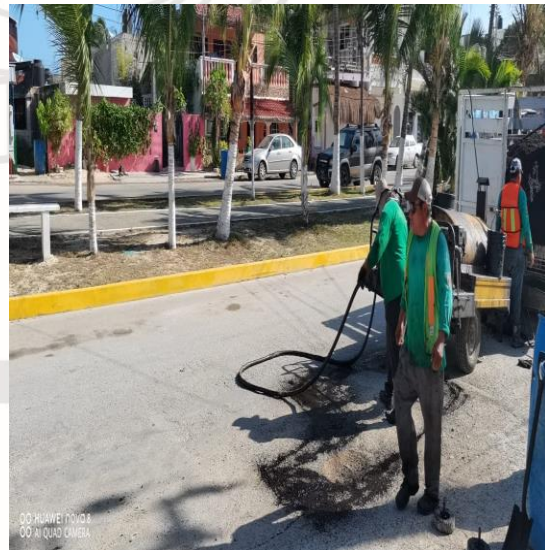
Bacheo; Akumal Pueblo
