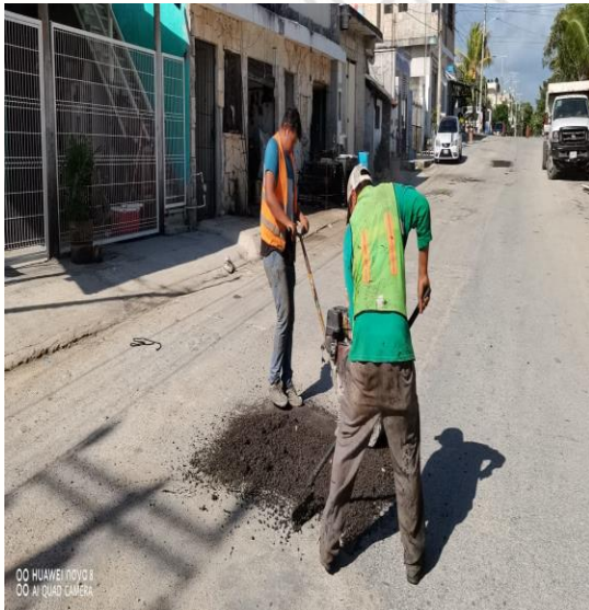
Bacheo; Akumal Pueblo
