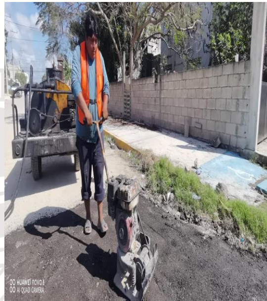
Bacheo; Calle omm entre tepezcuintle.
