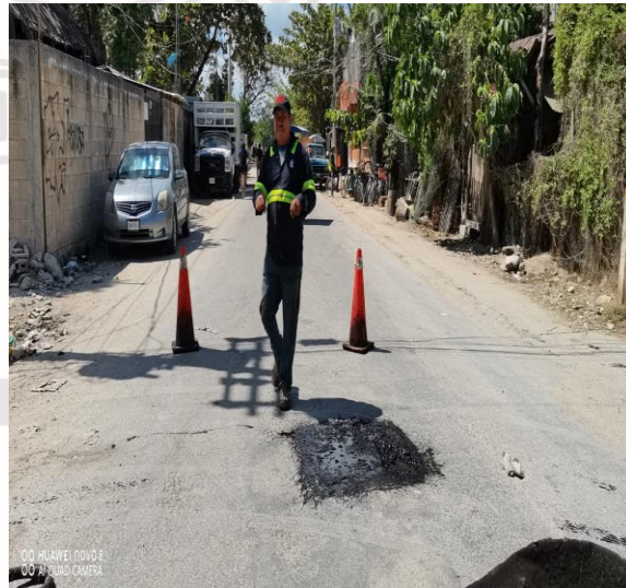
Bacheo; Calle mercurio oriente entre ori3n sur y centauro sur.
