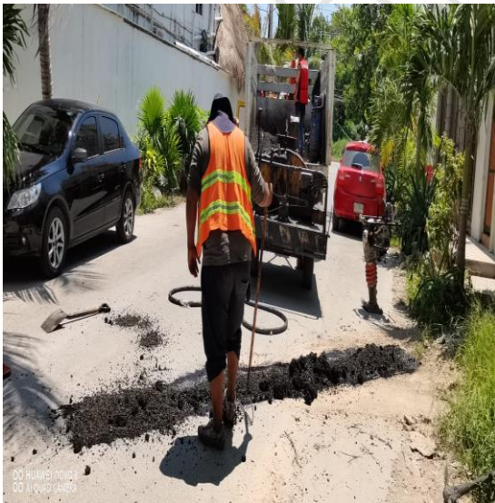
Bacheo; Calle 2 poniente entre la calle escorpión y Av. Coba
