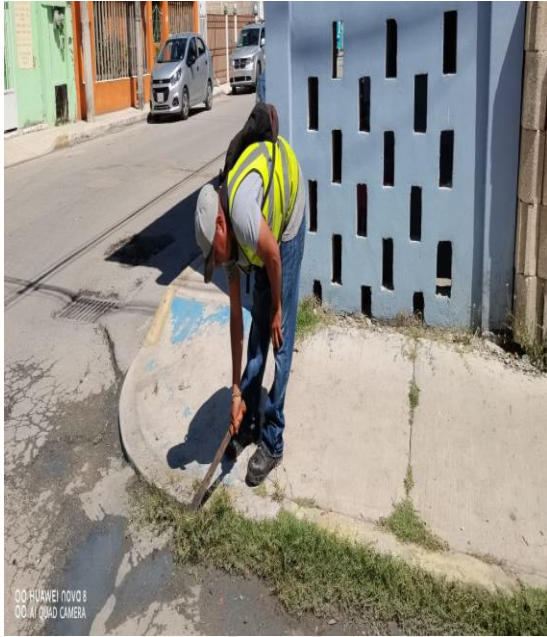
Limpieza de rejillas; Calle gama oriente entre calle beta sur y Órion sur.
