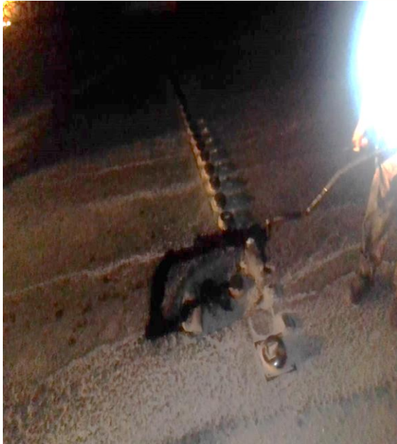
Bacheo; Zona costera (inicio hotel core).
