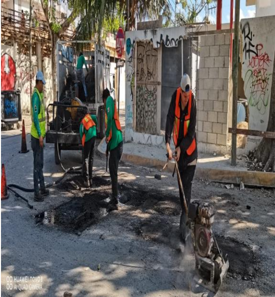
Bacheo; Calle acuario sur entre av Tulum y sol poniente.
