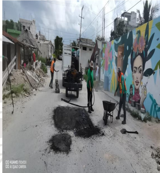
Bacheo; Calle caleta entre yalku y punta venado.
