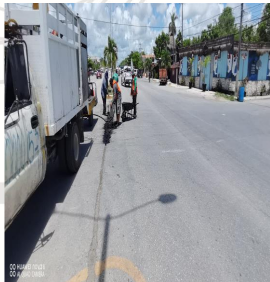
Bacheo; Av. Tulum entre la calle saturno
