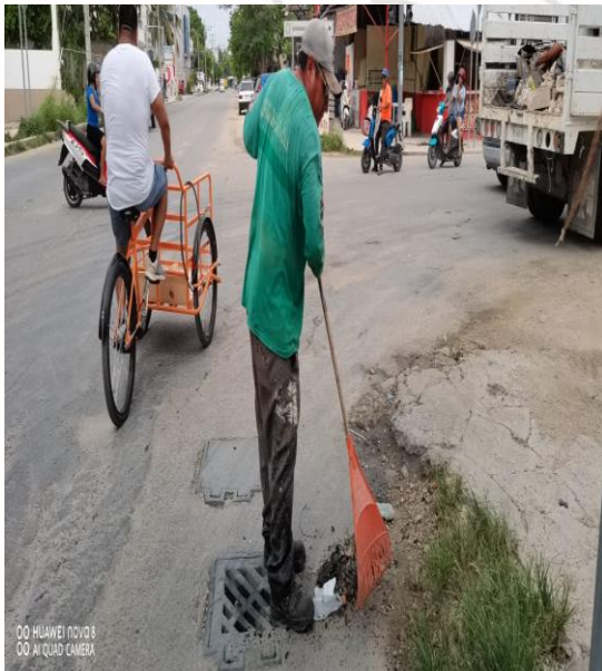
Limpeza De Rejillas: Av. ook-k'ot entre la calle Osiris norte entre la Av. kukulcan
