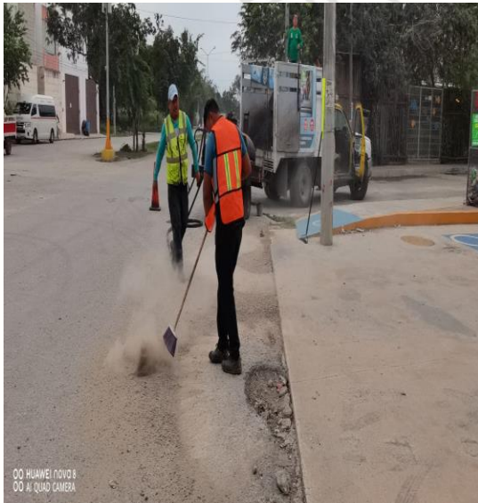
Bacheo; Av. selva entre calle faisán y tepescuintle.
