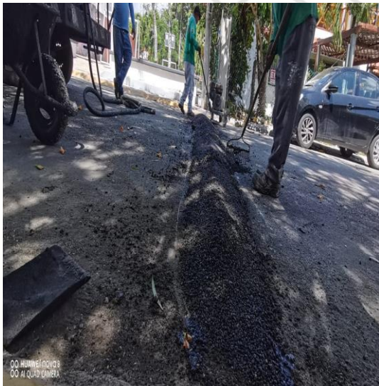
Bacheo; Calle 15 entre calle 4 oriente y calle 2 bis oriente
