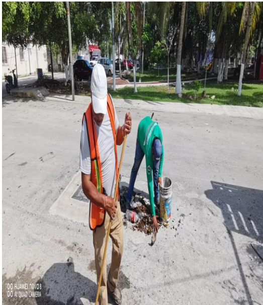
Limpieza de rejillas; Calle huracanes mitch entre la Calle huracanes Rossana y huracanes Janeth
