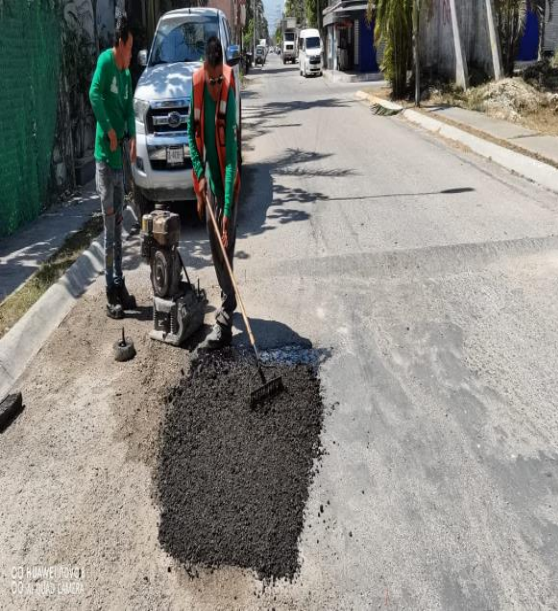
Bacheo; Calle 2 poniente entre escorpión norte y av coba.
