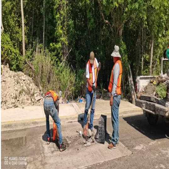
Limpeza De Rejillas: Calle kohunlich entre la avenida Tulum y calle akumal
