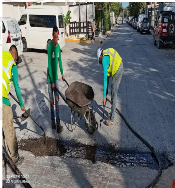
Bacheo; Av Tulum entre 3 sur y av coba.
