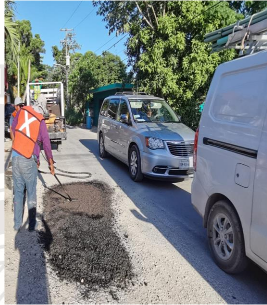
Bacheo; Calle zazil-há entre av kukulkan y boca paila.
