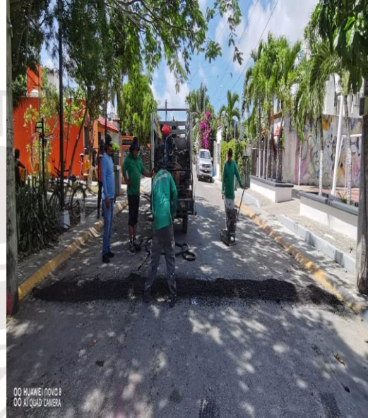
Bacheo; Calle 15 entre calle 4 oriente y calle 2 bis oriente
