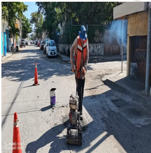
Bacheo; Calle sagitario entre osiris norte y alfa norte.
