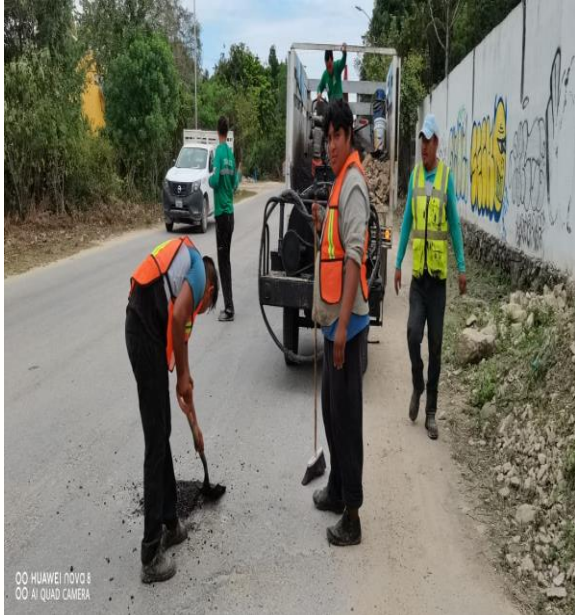
Bacheo; Av selva entre calle Kohunlich y x-carel.
