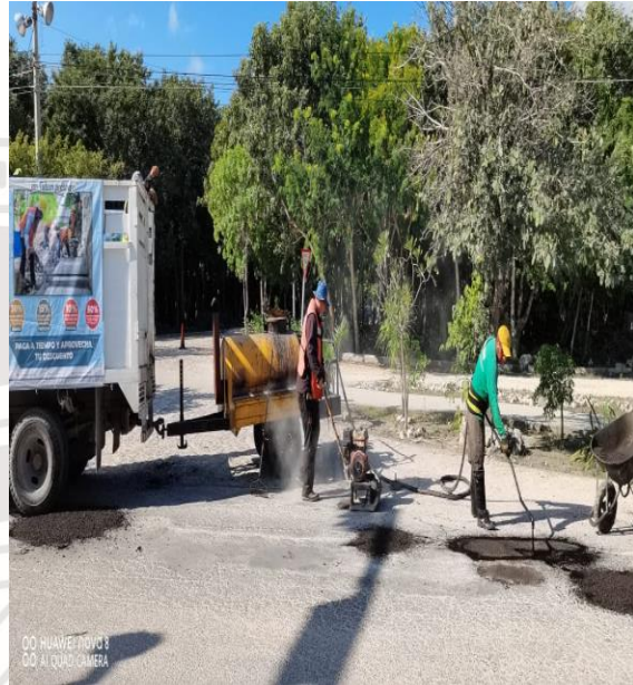
Bacheo; Av. coba sur entre aldea zamás
