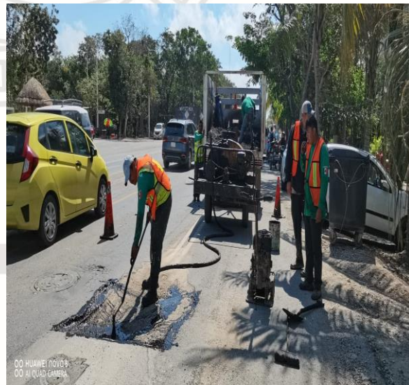
Bacheo; Av coba sur entre gama oriente y sol oriente
