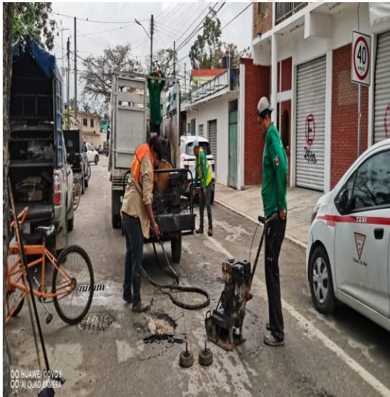
Bacheo; Calle acuario entre av tulum y sol poniente.
