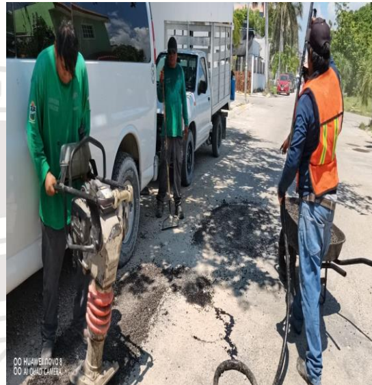
Bacheo; Calle 2 poniente entre la calle tepich.
