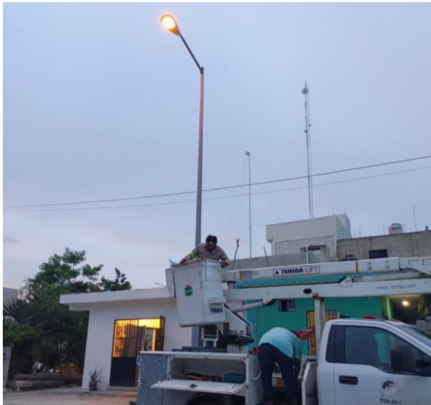
CAMBIO DE LUMINARIA OBSOLETA POR NUEVO TIPO LED; COL. YA'AX TULUM.
