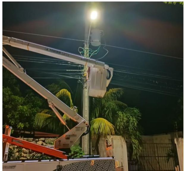
CAMBIO DE LUMINARIA OBSOLETA POR NUEVO TIPO LED; COL. TUMBEN KAA, CALLE RIO DE LA CONCORDIA ENTRE RIO CARDENAS Y RIO BASCA.
