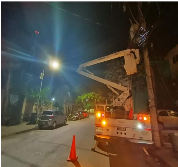
REHABILITACIÓN DE LÍNEAS DE ALUMBRADO PÚBLICO; COL. CENTRO, CALLE ANDROMEDA ENTRE CALLE CENTAURO OTE Y AV. SATELITE.
