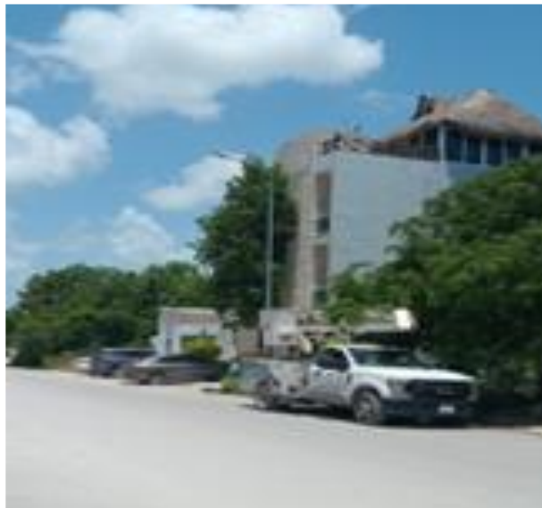
REHABILITACIÓN DE LÍNEAS DE ALUMBRADO PÚBLICO; COL. XUL KAA, CALLE TZ'UUB ENTRE 10 AV. NTE Y CALLE SACXIKIN.
