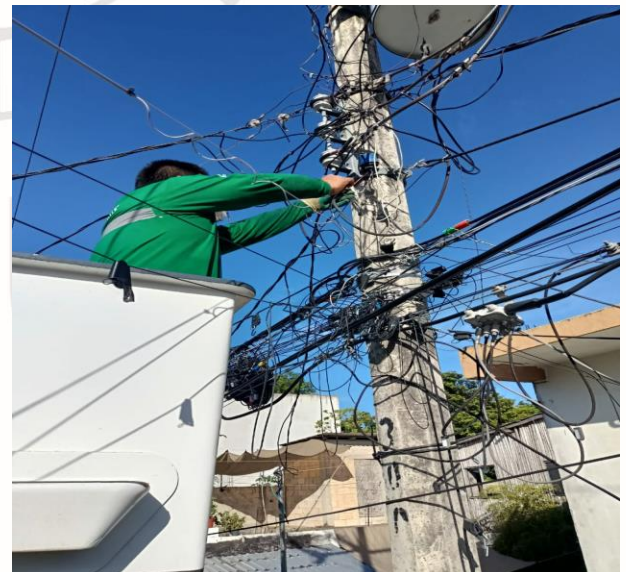
REHABILITACIÓN DE LÍNEAS DE ALUMBRADO PÚBLICO; COL. CENTRO, CALLE MERCURIO ENTRE CALLE KUKULKAN Y SATURNO PTE.
