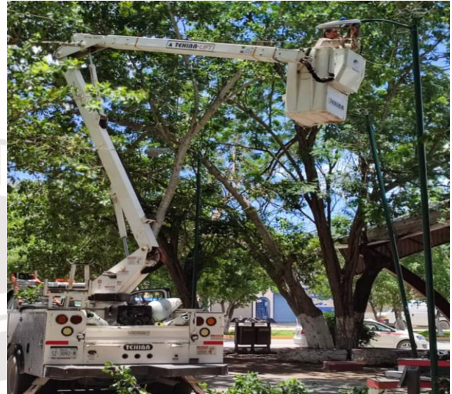
CAMBIO DE LUMINARIA OBSOLETA POR NUEVO TIPO LED; PARQUE LA CROC, COL. LAKIN, CALLE GAMA ENTRE AV. SATELITE SUR.
