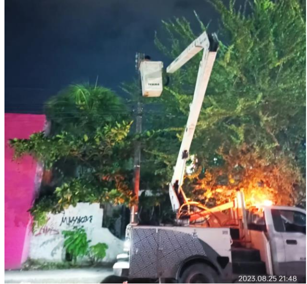
REHABILITACIÓN DE LÍNEAS DE ALUMBRADO PÚBLICO; COL. CENTRO, CALLE POLAR Y JUPITER NTE.
