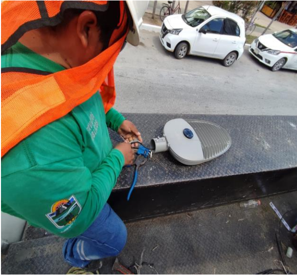
CAMBIO DE LUMINARIA OBSOLETA POR NUEVOS TIPO LED; COL. CENTRO, AV. TULUM ENTRE CALLE BETA Y AV. SATELITE.
