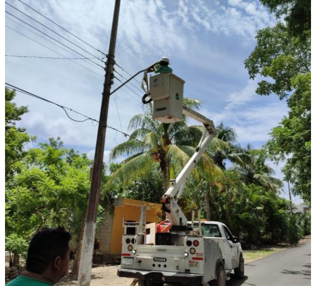
CAMBIO DE LUMINARIA OBSOLETA POR NUEVO TIPO LED; POBLADO DE COBA.
