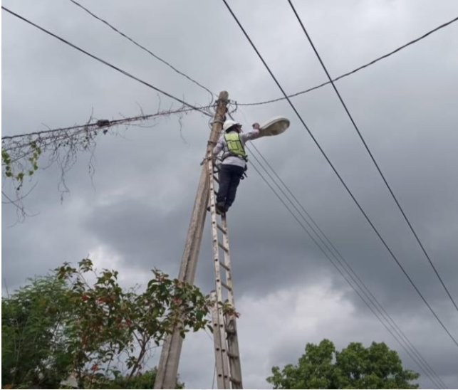
REHABILITACIÓN DE BASE DE FOTOCELDA Y FOTOCELDA; POBLADO DE MANUEL ANTONIO AY.
