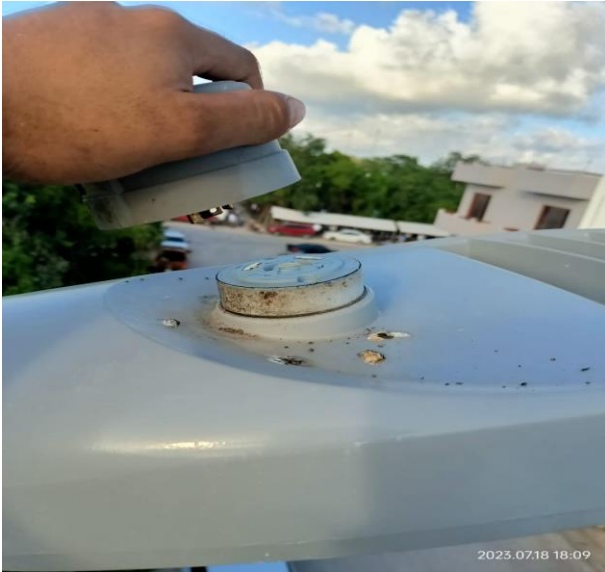
REHABILITACIÓN DE FOTOCELDA; COL. XUL KAA, CALLE KITAM ENTRE AV. NTE Y CALLE SACXIKIN.
