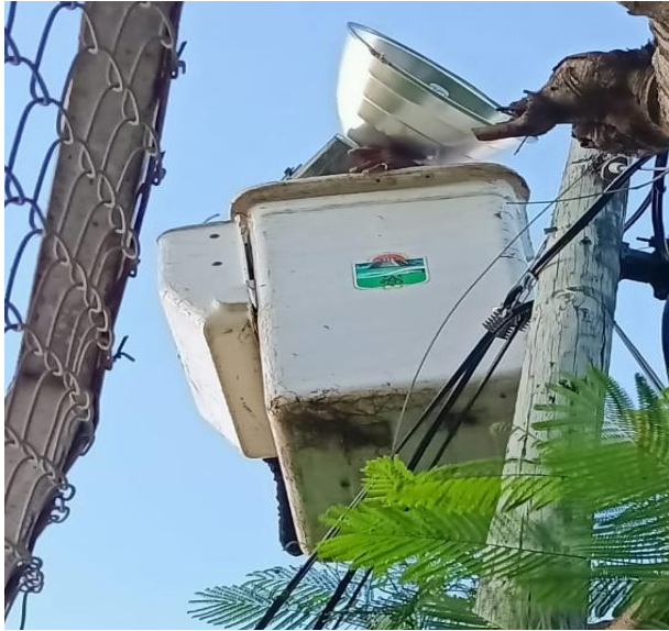
REHABILITACIÓN DE REFLECTOR; COL. CENTRO, CALLE SATURNO ENTRE CALLE MERCURIO OTE Y ONTARIO.
