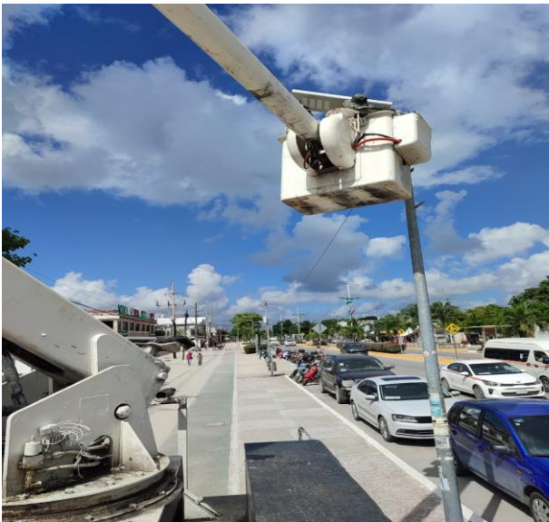
CAMBIO DE LUMINARIA OBSOLETA POR NUEVOS TIPO LED; COL. CENTRO, AV. TULUM ENTRE CALLE BETA Y AV. SATELITE.
