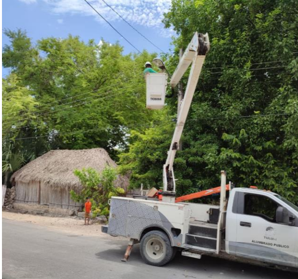
CAMBIO DE LUMINARIA OBSOLETA POR NUEVO TIPO LED; POBLADO DE COBA.
