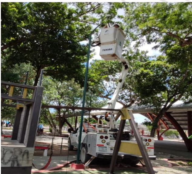
CAMBIO DE LUMINARIA OBSOLETA POR NUEVO TIPO LED; PARQUE LA CROC, COL. LAKIN, CALLE GAMA ENTRE AV. SATELITE SUR.
