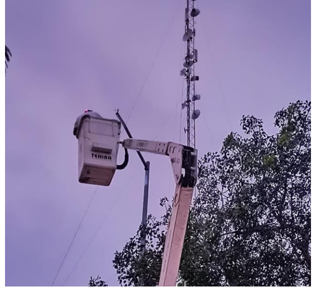
CAMBIO DE LUMINARIA OBSOLETA POR NUEVO TIPO LED; COL. YA´AX TULUM.
