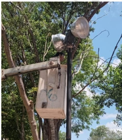
REHABILITACIÓN DE LÍNEAS DE ALUMBRADO PÚBLICO, FRACCIONAMIENTO PALMAS, CALLE PALMA GUINEA CON ESQUINA PALMA BOTELLA.
