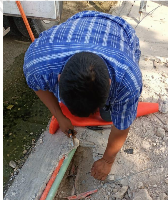
REHABILITACIÓN DE LÍNEAS DE ALUMBRADO PÚBLICO, FRACCIONAMIENTO VILLAS TULUM, CALLE 17 ENTRE CALLE 4 OTE Y 2 BIS OTE.
