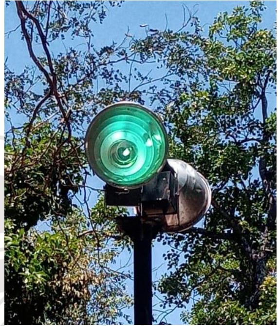
CAMBIO DE LUMINARIAS, COL. CENTRO, CALLE SOL OTE ENTRE CALLE OSIRIS SUR Y ALFA SUR.
