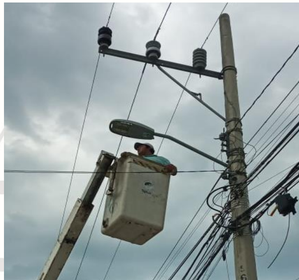
REHABILITACIÓN DE FOTOCELDA, COL. MAYAPAX, CALLE HOOC ENTRE CALLE ALFA NTE Y OMEGA NTE.
