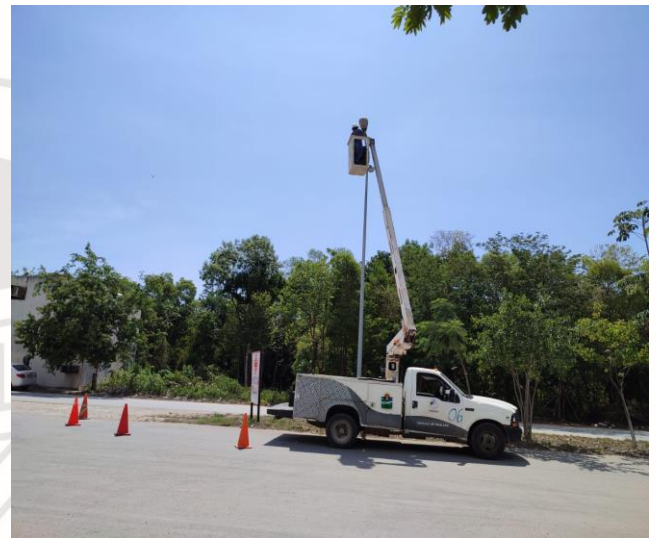
REHABILITACIÓN DE LÍNEAS DE ALUMBRADO PÚBLICO, COL. YA'AX TULUM.
