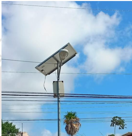
REHABILITACIÓN DE LÍNEAS DE ALUMBRADO PÚBLICO, COL CENTRO, AV. SATELITE ENTRE CALLE POLAR Y SAGITARIO.
