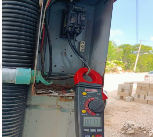
REHABILITACIÓN DE BASE DE FOTOCELDA Y FOTOCELDA, COL. TUMBEN KAA, CALLE MAYA BALAM ENTRE CALLE CHICHEN ITZA Y AKUMAL.
