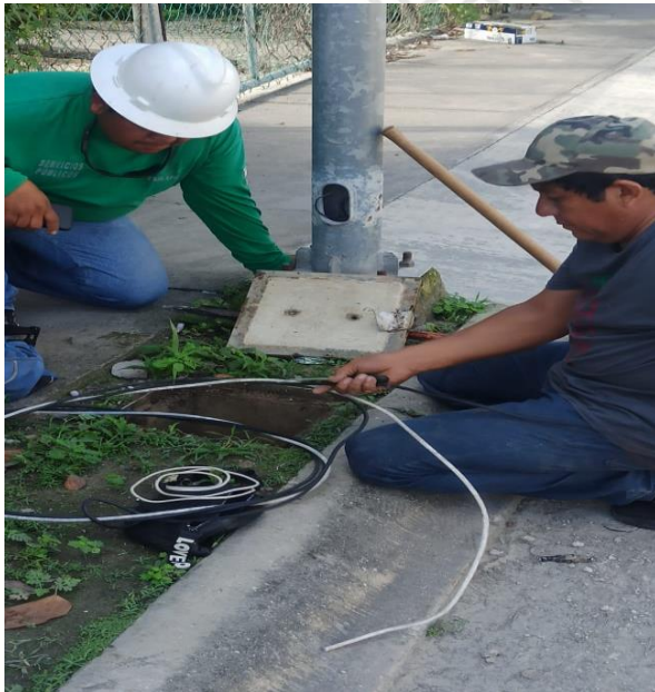
INSTALACIÓN DE CABLE SUBTERRANEO, QUE SE ENCONTRABA REVENTADO, COL. GUERRA DE CASTAS
