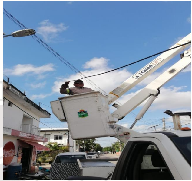
REHABILITACIÓN DE LUMINARIA, QUE SE ENCONTRABA FUERA DE SERVICIO, COL. CENTRO, CALLE 4 OTE / ALFA NTE Y OMEGA NTE
