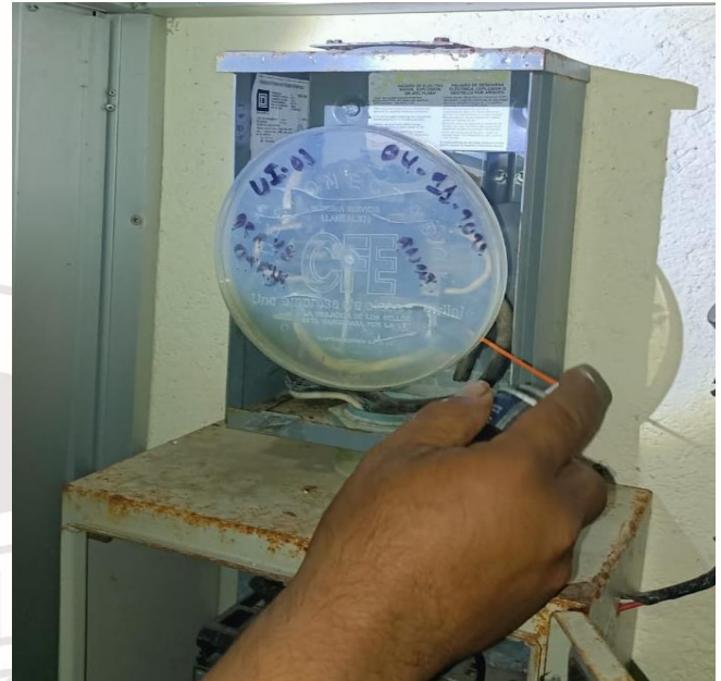
RECONEXIÓN DE LÍNEAS AÉREAS SULFATADAS, ENTRADA A LAS RUINAS A UN COSTADO DEL ESTACIONAMIENTO
