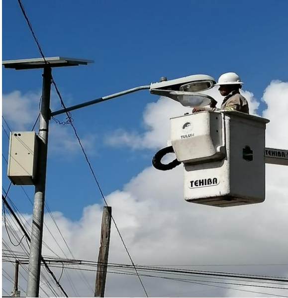
REHABILITACIÓN DE FOTOCELDA, QUE SE ENCONTRABA DE SERVICIO, COL. CENTRO, AV SATELITE, CALLE ALFA
