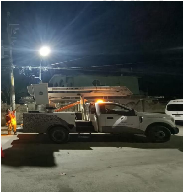
REHABILITACIÓN DE LUMINARIA, QUE SE ENCONTRABA FUERA DE SERVICIO, COL. CENTRO, CALLE 2 OTE / ALFA NTE
