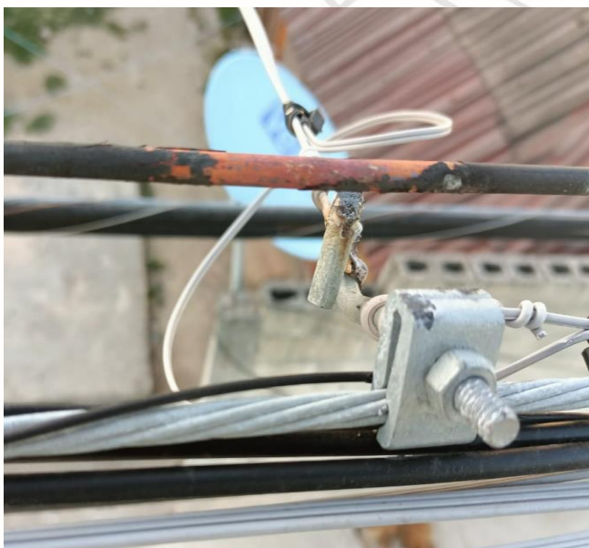
RECONEXIÓN DE LÍNEAS AÉREAS SULFATADAS, COL. EJIDO, CALLE KUKULCAN/ VENADO HASTA LA CALLE 11
