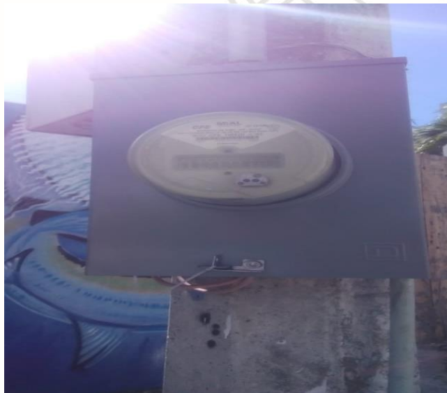
INSTALACIÓN DE BASE DE MEDIDOR, QUE SE ENCONTRABA FUERA DE SERVICIO, COL. MAYA PAX, CALLE TUNKUL / CENTAURO Y ORION
