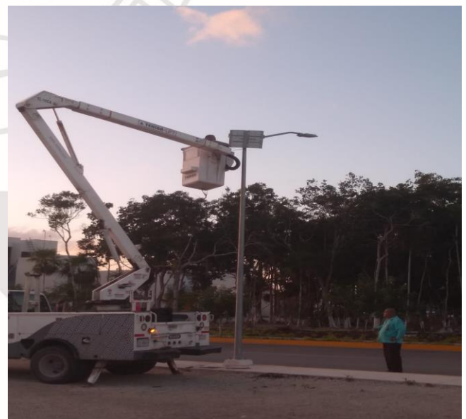
INSTALACIÓN DE REFLECTOR, ALDEA TULUM, CALLE RUBI
