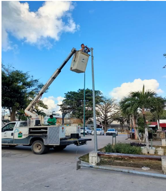
CAMBIO DE POSTES, FRACCIONAMIENTO LAS PALMAS
