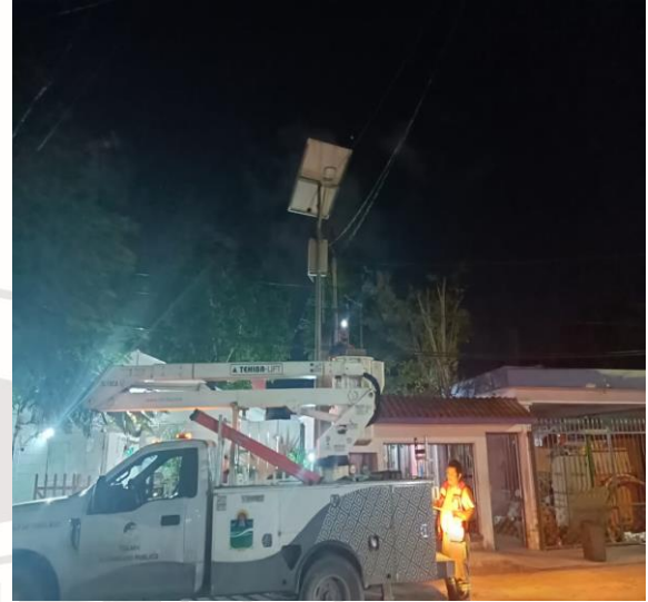
REHABILITACIÓN DE LUMINARIA, QUE SE ENCONTRABA FUERA DE SERVICIO, COL. CENTRO, CALLE 2 OTE / ALFA NTE
