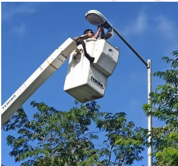
REHABILITACIÓN DE LUMINARIA, COL. YA'AX TULUM, AV. LA SELVA/ AZUCENA, 20 AV. NTE Y AV. NORTE
