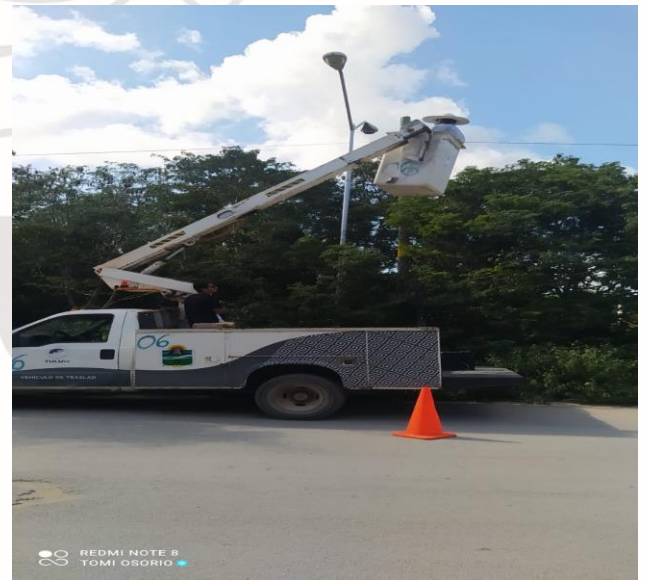
REHABILITACIÓN DE LAMPARA Y BALASTRO, QUE SE ENCONTRABA FUERA DE SERVICIO, COL. TUMBENKAA, AV 1 / CALLE TEPESCUINTLE
