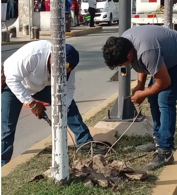
RECONEXIÓN DE LINEA SUBTERRANEA, QUE SE ENCONTRABA SULFATADO, COL.CENTRO, AV. TULUM / CENTAURO
