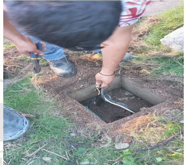
RECONEXIÓN DE LINEA SUBTERRANEA, QUE SE ENCONTRABA SULFATADO, MANUEL ANTONIO AY
