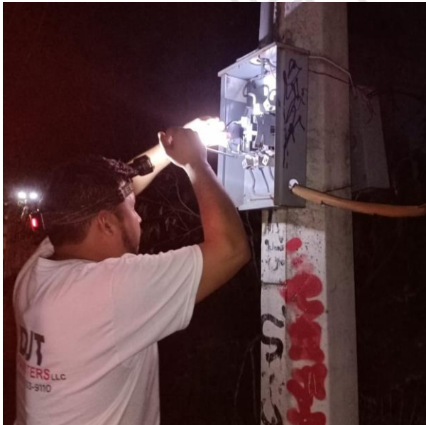
INSTALACIÓN DE BANCOS DE CONTROL, COBA
