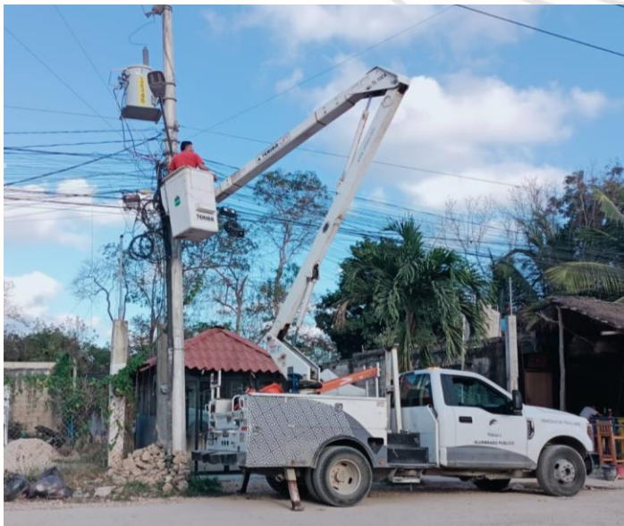
REHABILITACIÓN DE BASE DE FOTOCELDA Y FOTOCELDA, VARIOS PUNTOS DE LA CIUDAD
