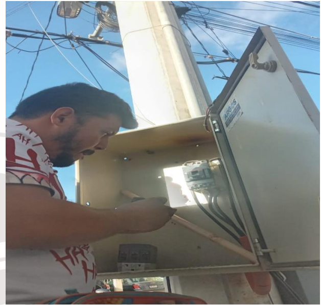
INSTALACIÓN DE BASE DE MEDIDOR, QUE SE ENCONTRABA FUERA DE SERVICIO, COL. EJIDO, CALLE CHANCHEN / CODORNIZ
