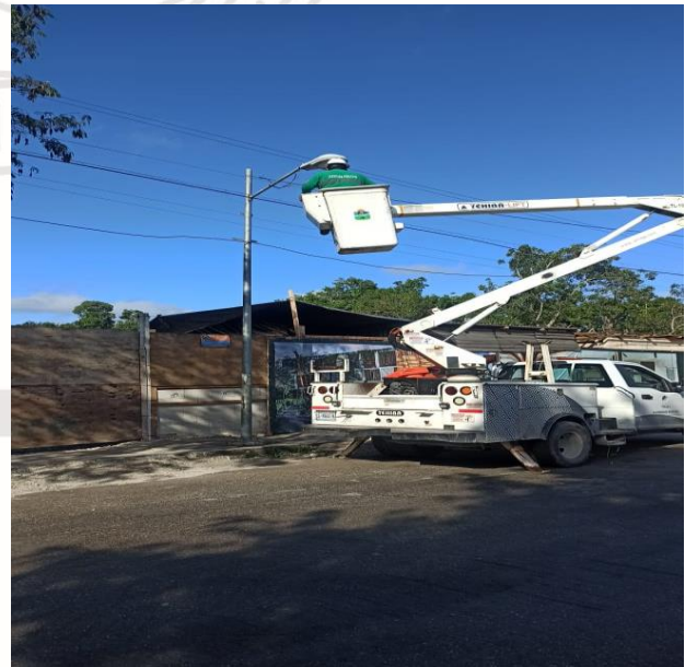
REHABILITACIÓN DE LAMPARA, QUE SE ENCONTRABA FUERA DE SERVICIO, COL. MAYA PAX, CALLE OSIRIS / TUNKUL Y CALLE 4
