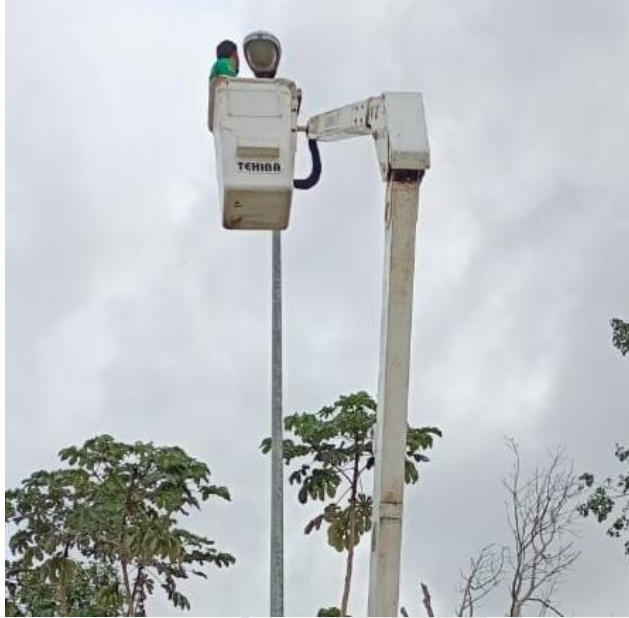
REHABILITACIÓN DE LUMINARIA, COL. YA'AX TULUM, CALLE VIOLETA/ AV. 15 NTE Y GLADIOLAS
