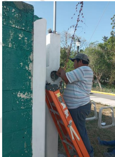
COL. CENTRO, C. ACUARIO NTE / 2 PONIENTE, SE REHABILITA MEDIDOR DAÑADO CAMBIANDO TERMINALES.
