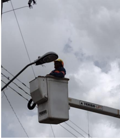
FRAC. VILLAS TULUM, SE TENSIONAN LINEAS AEREAS DE ALUMBRADO PUBLICO.
