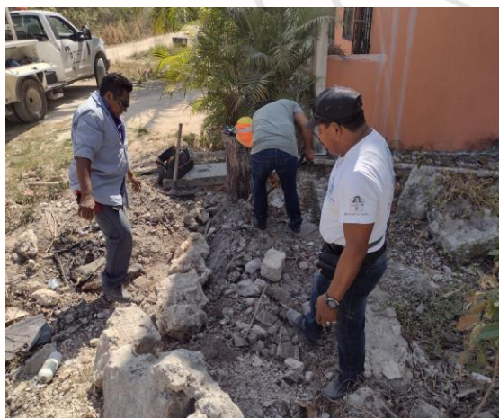
COL. CENTRO, AV. OSIRIS / ALFA, RECONEXIÓN DE LINEAS A LAMPARA QUE ESTAN SULFATADAS
