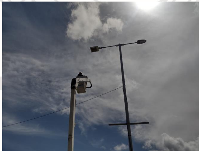
COL. YAAX TULUM, AV SATELITE, UNIDAD DEPORTIVA, ETC, REALIZACIÓN DE RECORRIDO DE ENCENDIDO DE SECTORES MANUALES
