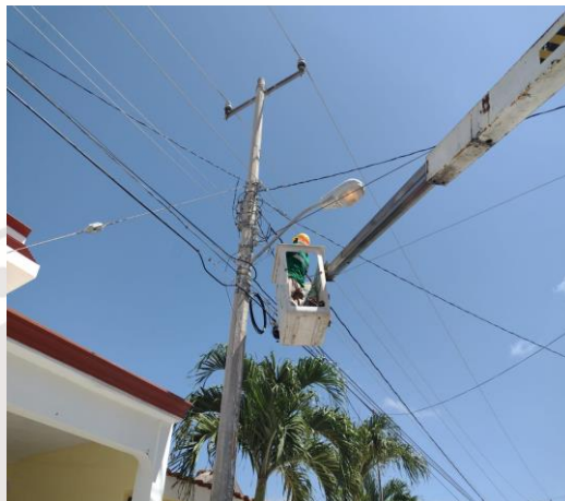
COL. CENTRO, HOLISTICA, CICLOVIA, AV SATELITE, UNIDAD DEPORTIVA, ETC, REALIZACIÓN DE RECORRIDO DE ENCENDIDO DE SECTORES MANUALES
