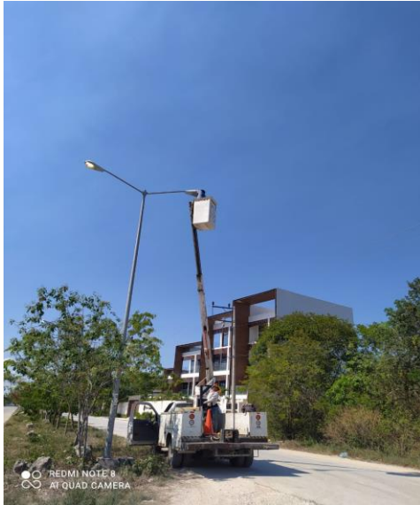
COL. VELETA, HAVEN, AV SATELITE, UNIDAD DEPORTIVA, ETC, REALIZACIÓN DE RECORRIDO DE ENCENDIDO DE SECTORES MANUALES
