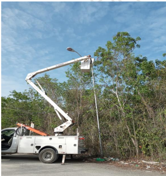
FRAC. VILLAS TULUM, C. 4 OTEV/ C. 13 Y C. 11, SE REALIZO MANTENIMIENTO A CONTACTOR QUE SE ENCONTRABA FALLANDO.
