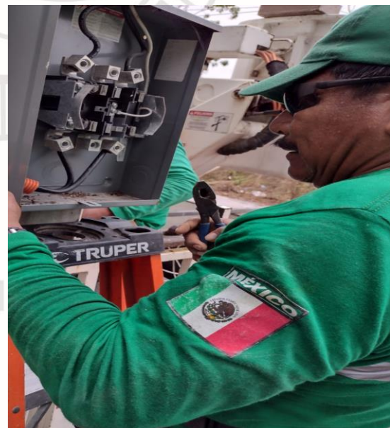
COL. TUBEN KA, C. AV.2 / C. 24 Y AV.1, SE REALIZO MANTENIMIENTO A CONTACTOR QUE SE ENCONTRABA FALLANDO.
