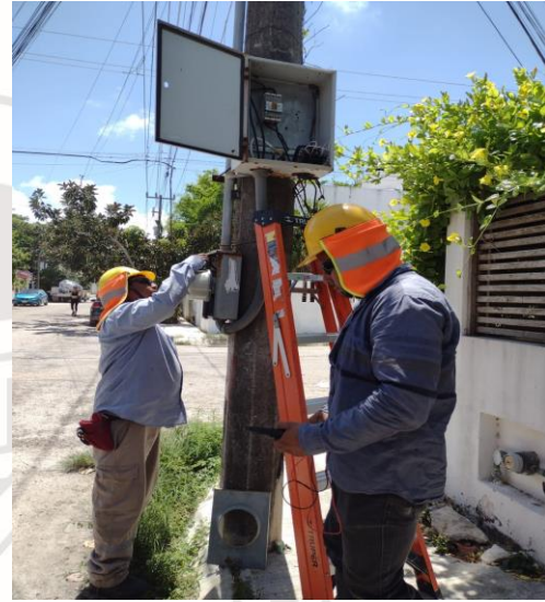
VILLAS TULUM, C. 2 OTE / C. 5 SUR, RECONEXIÓN DE LINEAS QUE TENIAS CORTO CIRCUITO
