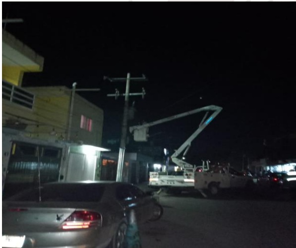
CICLOVIA, AV. SATELITE, PARQUE DOS AGUAS, UNIDAD DEPORTIVA, HOLISTICA, ETC, REALIZACIÓN DE RECORRIDO DE APAGADO DE SECTORES MANUALES
