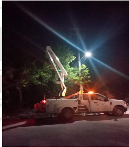
COL. CENTRO, C. OSIRIS Y ALFA, SE REHABILITO LAMPARA LED DE 73WTS CON BREAK.
