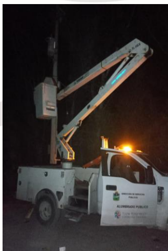
COL. TUBEN KAC. 24 / C. 1 Y 2, CAMBIO DE FOTOCELDA 220V A SECTOR.
