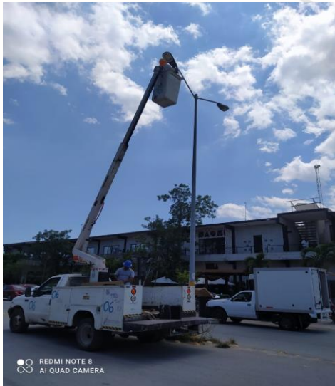
HOLISTICA, 5 AV. NORTE, SE REHABILITA DE LAMPARA Y BALASTRO OV-15 (TIPO AM-175W Y BALASTRO AM-175W)
