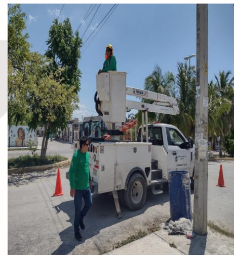
CICLOVIA, AV. SATELITE, PARQUE DOS AGUAS, UNIDAD DEPORTIVA, HOLISTICA, ETC, REALIZACIÓN DE RECORRIDO DE APAGADO DE SECTORES MANUALES
