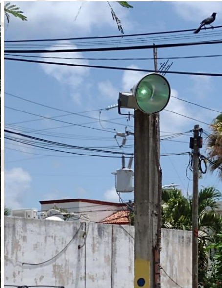
CICLOVIA, AV. SATELITE, PARQUE DOS AGUAS, UNIDAD DEPORTIVA, HOLISTICA, ETC, REALIZACIÓN DE RECORRIDO DE APAGADO DE SECTORES MANUALES.
