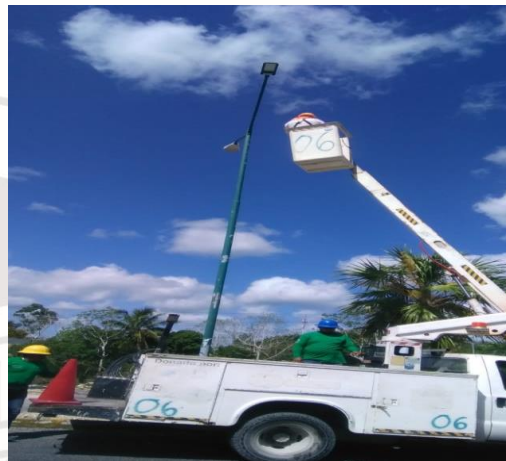
COL.XULKA, C. SACXIKIN / C. OKOOT Y KEE, LIMPIEZA Y MANTENIMIENTO DE CONTACTOR.
