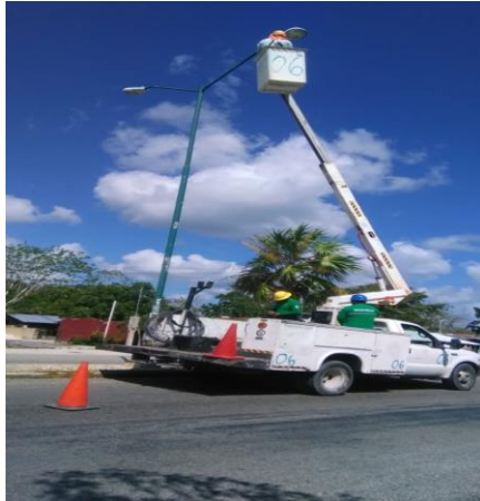
COL. CENTRO, OLÍSTICA, AV. SATELITE, CICLOVIA, ETC, REALIZACIÓN DE RECORRIDO DE ENCENDIDO DE SECTORES MANUALES.
