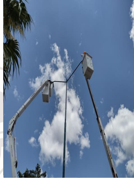
C. ALFA SUR / AV. TULUM Y SOL OTE, RECONEXIÓN DE LINEAS A LAMPARA QUE ESTAN SULFATADAS
