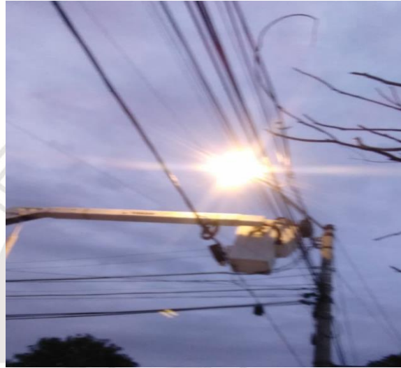
CICLOVIA, AV. SATELITE, PARQUE DOS AGUAS, UNIDAD DEPORTIVA, HOLISTICA, ETC, REALIZACIÓN DE RECORRIDO DE APAGADO DE SECTORES MANUALES.
