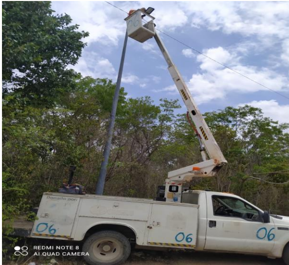
COL. XULKA, AV.10 / AV.LA SELVA, HOLISTICA, ETC, REEMPLAZO DE LUMINARIAS OBSOLETAS POR LAMPARAS LED DE 100 W.
