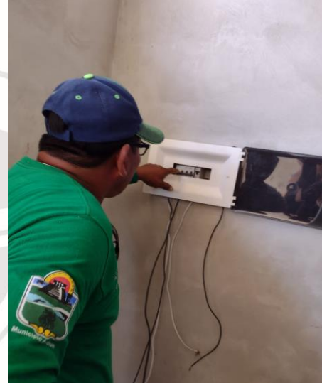
AKUMAL, APOYO DE VERIFICACION DE CENTROS DE CARGA EN OBRA.
