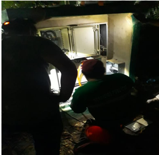
COL. CENTRO, UNIDAD DEPORTIVA, SE RESTABLECIO UN BREAK DE CENTRO DE CARGA, SE PUSO PASTILLA.
