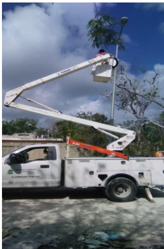
COL. CENTRO, HOLISTICA, CICLOVIA, AV SATELITE, UNIDAD DEPORTIVA, ETC, REALIZACIÓN DE RECORRIDO DE ENCENDIDO DE SECTORES MANUALES
