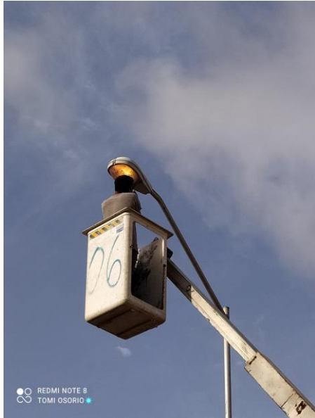
CICLOVIA, AV. SATELITE, PARQUE DOS AGUAS, UNIDAD DEPORTIVA, HOLISTICA, ETC, REALIZACIÓN DE RECORRIDO DE APAGADO DE SECTORES MANUALES
