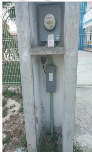
COL. TUBEN KA, C. AV.1 / AV.2, CAMBIO DE FOTOCELDA 220V EN SECTOR
