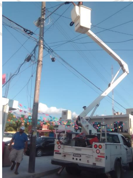
CHEMUYIL, ETC, CAMBIO DE FOTOCELDA 220V.
