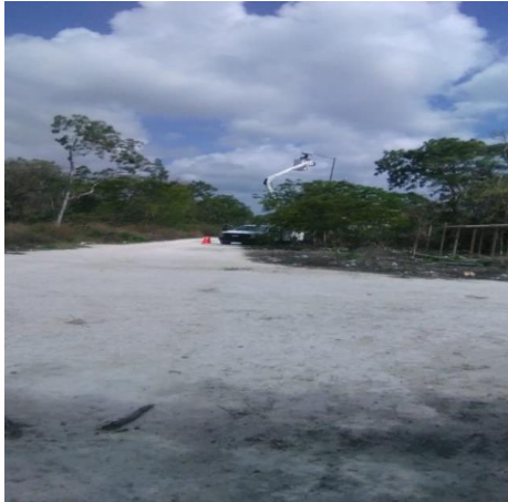
COL. CENTRO, HOLISTICA, CICLOVIA, AV SATELITE, UNIDAD DEPORTIVA, ETC, REALIZACIÓN DE RECORRIDO DE ENCENDIDO DE SECTORES MANUALES
