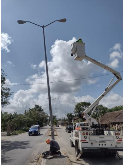
CICLOVIA, AV. SATELITE, PARQUE DOS AGUAS, UNIDAD DEPORTIVA, HOLISTICA, ETC, REALIZACIÓN DE RECORRIDO DE APAGADO DE SECTORES MANUALES.
