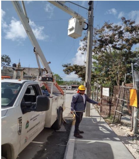
COL. CENTRO, C. OTE Y CENTAURO, REEMPLAZO DE LUMINARIAS LED POR NUEVAS
