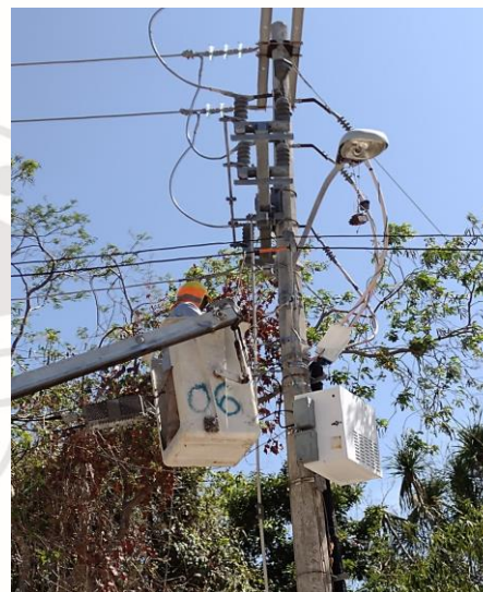
SAN JUAN, SE REHABILITA DE LAMPARA Y BALASTRO OV-15 (TIPO AM-175W Y
