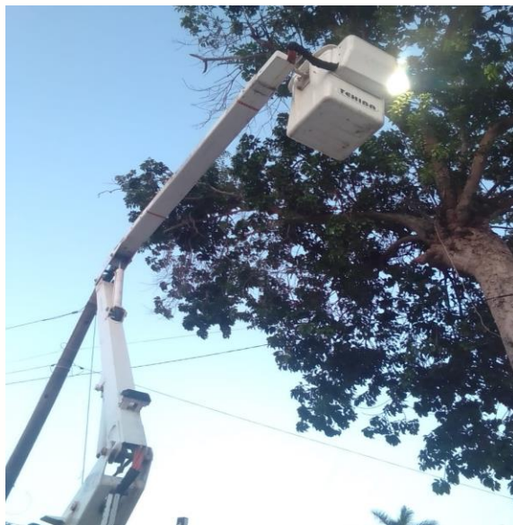
COL. CENTRO, C. LUNA / OMEGA Y PRIVADA, RECONEXIÓN DE LINEAS A LAMPARA QUE ESTAN SULFATADAS
