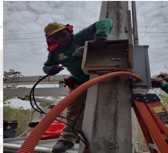
COL. TUBEN KA, C. AV.2 / C. 26 Y AV. LA SELVA, SE REALIZA LA RECONEXIÓN DE LINEAS SUBTERRANEAS DESCONECTADA.
