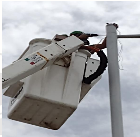
COL. CENTRO C. 2 PTE / ALFA NTE Y CENTAURO, REEMPLAZO DE LUMINARIAS QUEMADAS POR LAMPARA LED DE 100 W.
