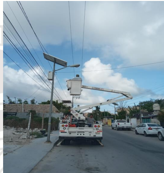
COL. TUBEN KA, SE REHABILITA DE LAMPARA Y BALASTRO OV-15 (TIPO AM-175W Y BALASTRO AM-175W)
