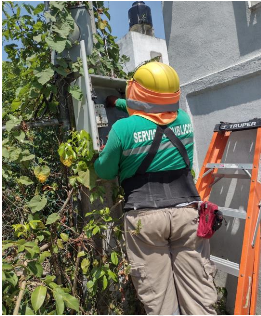
CICLOVIA, AV. SATELITE, PARQUE DOS AGUAS, UNIDAD DEPORTIVA, HOLISTICA, ETC, REALIZACIÓN DE RECORRIDO DE APAGADO DE SECTORES MANUALES
