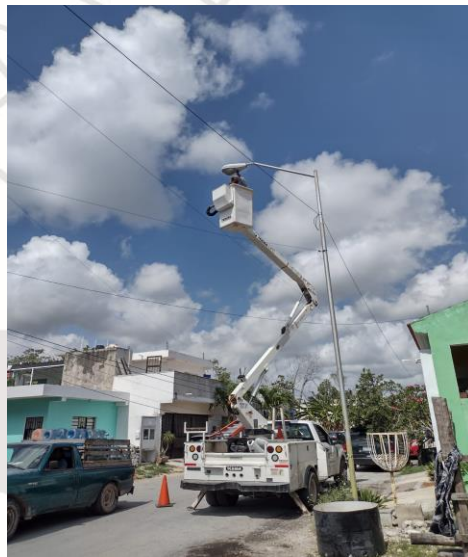
COL. CENTRO, OLISTICA, AV. SATELITE, CICLOVIA, ETC, REALIZACIÓN DE RECORRIDO DE ENCENDIDO DE SECTORES MANUALES
