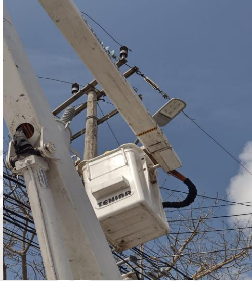
FRAC. VILLAS TULUM, SE REALIZA LA RECONEXIÓN DE LINEAS AEREAS QUE ESTAN SULFATADAS.
