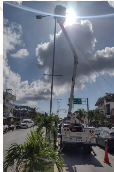
EJIDO, COCODRILO, AV KUKULKAN, REHABILITACIÓN DE LAMPARA TIPO LED
