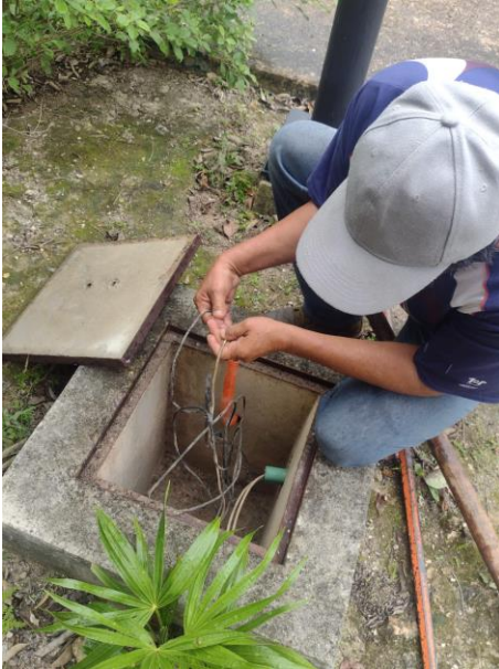
CICLOVIA, AV. SATELITE, PARQUE DOS AGUAS, UNIDAD DEPORTIVA, HOLISTICA, ETC. REALIZACIÓN DE RECORRIDO DE ENCENDIDO DE SECTORES MANUALES.
