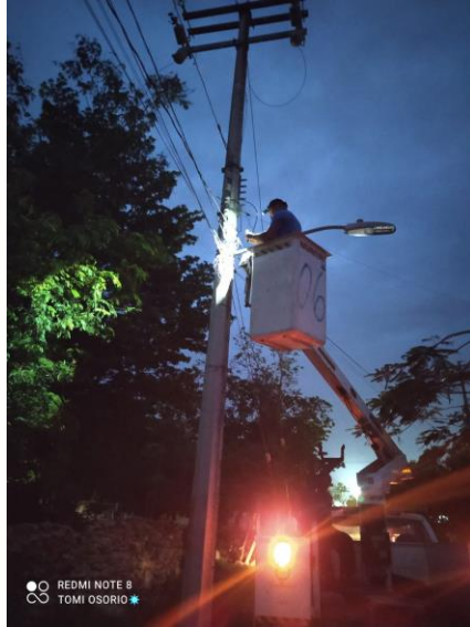
COL. VILLAS TULUM, YAAX TULUM / CICLOVIA Y 5TA AV, REALIZACIÓN DE RECORRIDO DE ENCENDIDO DE SECTORES MANUALES
