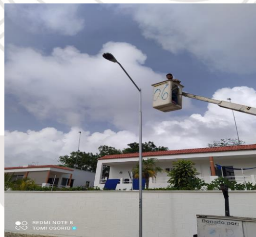
CICLOVIA, AV. SATELITE SUR, PARQUE 2 AGUAS, UNIDAD DEPORTIVA, AV 5 SUR, ETC, REALIZACIÓN DE RECORRIDO DE ENCENDIDO DE SECTORES MANUALES
