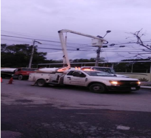
CICLOVIA, AV. SATELITE SUR, PARQUE 2 AGUAS, UNIDAD DEPORTIVA, AV 5 SUR, REALIZACIÓN DE RECORRIDO DE ENCENDIDO DE SECTORES MANUALES.
