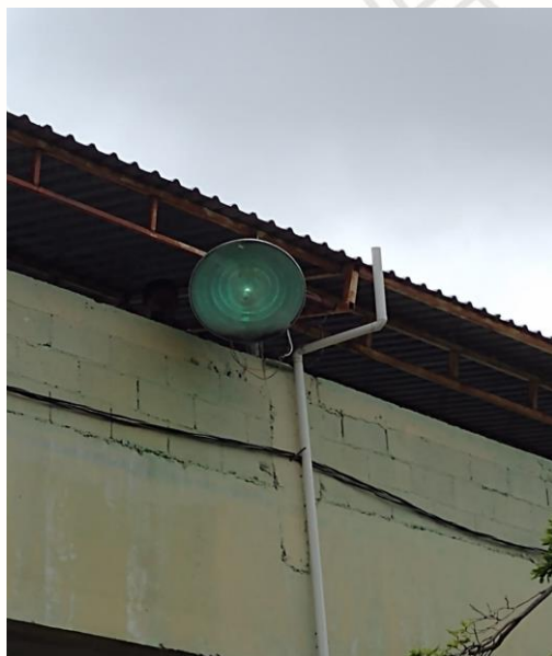
COL. CENTRO (UNIDAD DEPORTIVA-CAMPO DE BEISBOL), REHABILITACIÓN DE REFLECTOR (FOCO AM-1,000W Y BALASTRO AM-1,000)
