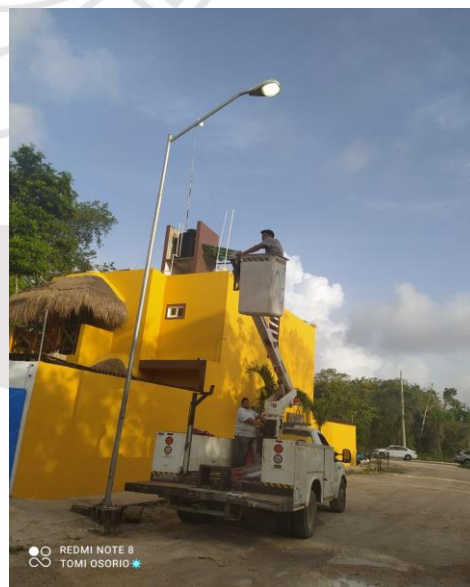
COL. TUMBENKA, AV LA SELVA Y RIO LA CONCORDIA, REHABILITACIÓN DE BASE DE MEDIDOR QUEMADO
