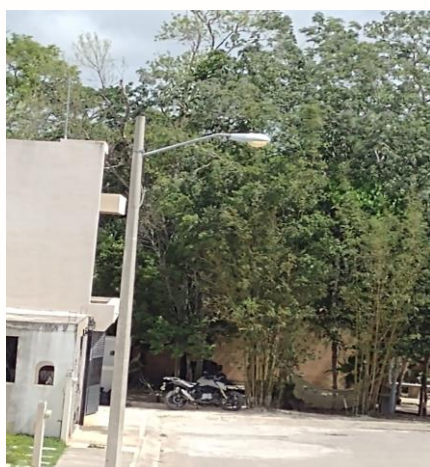
FRACC. PALMAS PRIVADA / PALMA AZUL Y PALMA CANARIO, REHABILITACIÓN DE LAMPARA OV-15 (AM-175 Y BALASTRO AM-175)
