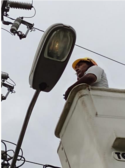
HONDZONOT, REHABILITACIÓN DE LAMPARA OV-15 Y (AM-175W Y BALASTRO AM-175W)
