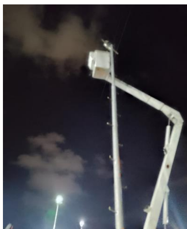
CICLOVIA, AV. SATELITE SUR, PARQUE 2 AGUAS, UNIDAD DEPORTIVA, AV 5 SUR, ETC, REALIZACIÓN DE RECORRIDO DE ENCENDIDO DE SECTORES MANUALES
