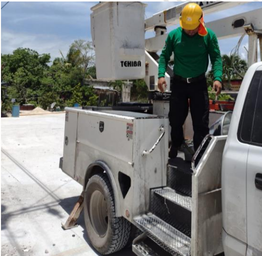
COL. CENTRO, HOLISTICA, CICLOVIA, AV SATELITE, UNIDAD DEPORTIVA, ETC, REALIZACIÓN DE RECORRIDO DE ENCENDIDO DE SECTORES MANUALES
