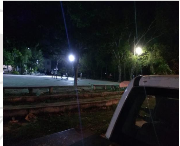
FRACC. LAS PALMAS / CHA, REHABILITACIÓN DE LAMPARA TIPO (AM-175W Y BALASTRO AM-175)
