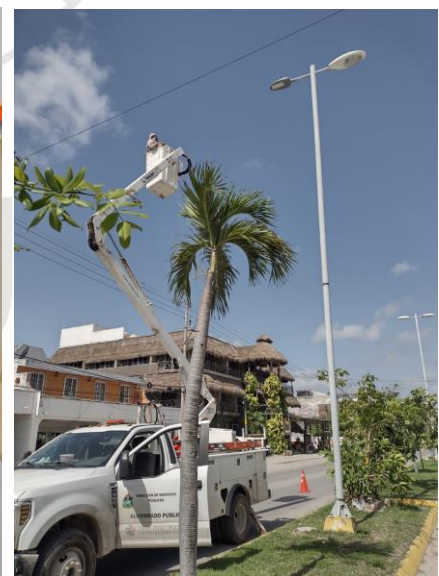
CICLOVIA, AV. SATELITE, PARQUE DOS AGUAS, UNIDAD DEPORTIVA, HOLISTICA, ETC, REALIZACIÓN DE RECORRIDO DE ENCENDIDO DE SECTORES MANUALES
