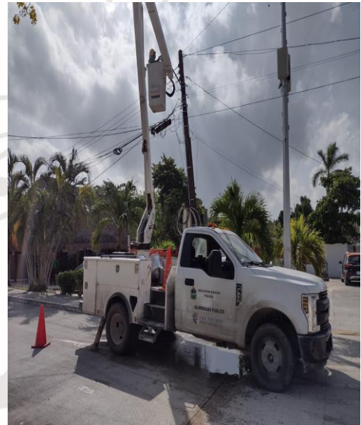
CICLOVIA, AV. SATELITE SUR, PARQUE 2 AGUAS, UNIDAD DEPORTIVA, AV 5 SUR, ETC, REALIZACIÓN DE RECORRIDO DE ENCENDIDO DE SECTORES MANUALES
