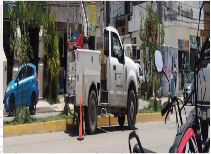
COL. TUMBENKA / CALLE TEPEZCUINTLE, RECONEXIÓN DE LINEAS SUBTERRANEAS
