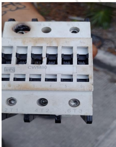
COL. ALDEA ZAMA. REHABILITACIÓN DE INTERRUPTOR QUEMADO
