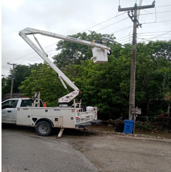
COL. CENTRO, OLISTICA, AV. SATELITE, CICLOVIA, ETC, REALIZACIÓN DE RECORRIDO DE ENCENDIDO DE SECTORES MANUALES
