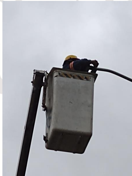
COL. CENTRO, OLISTICA, AV. SATELITE, CICLOVIA, ETC, REALIZACIÓN DE RECORRIDO DE ENCENDIDO DE SECTORES MANUALES
