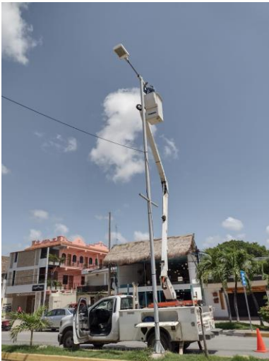
CICLOVIA, AV. SATELITE SUR, PARQUE 2 AGUAS, UNIDAD DEPORTIVA, AV 5 SUR, ETC, REALIZACIÓN DE RECORRIDO DE ENCENDIDO DE SECTORES MANUALES
