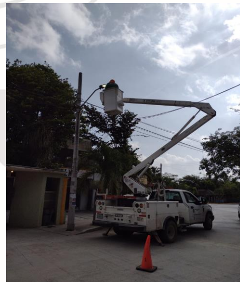
COL. CENTRO, AV TULUM Y LIBRA, SE VERIFICO UN BRAZO DE LAMPARA PARA SABER LOS DIAMETROS DE TUBO
