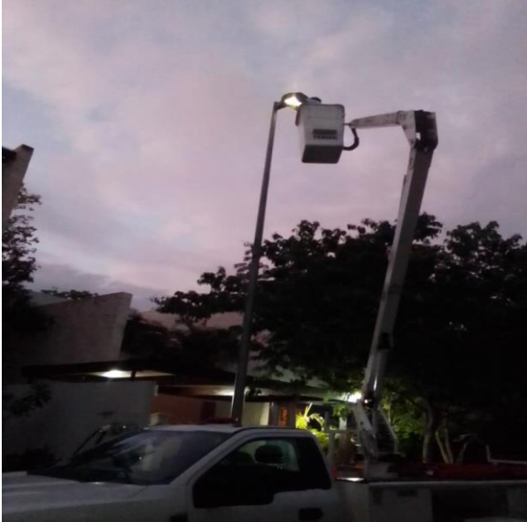
CICLOVIA, AV. SATELITE, PARQUE DOS AGUAS, UNIDAD DEPORTIVA, HOLISTICA, ETC, REALIZACIÓN DE RECORRIDO DE ENCENDIDO DE SECTORES MANUALES
