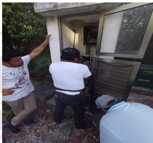
ALDEA ZAMA. REHABILITACIÓN DE CONTACTOR
