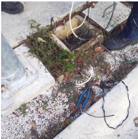
COL. ALDEA ZAMA. RECONEXIÓN DE LINEA SUBTERRANEA QUE SE ENCONTRO SULFATADO
