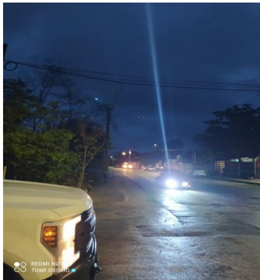
CICLOVIA, AV. SATELITE SUR, PARQUE 2 AGUAS, UNIDAD DEPORTIVA, AV 5 SUR, ETC, REALIZACIÓN DE RECORRIDO DE ENCENDIDO DE SECTORES MANUALES
