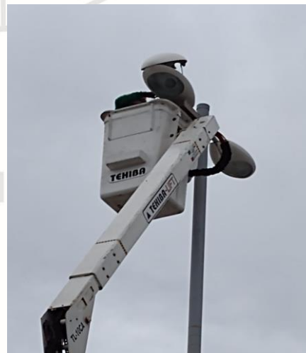
COL. VILLAS TULUM, YAAX TULUM / CICLOVIA Y 5TA AV, ETC, REALIZACIÓN DE RECORRIDO DE ENCENDIDO DE SECTORES MANUALES
