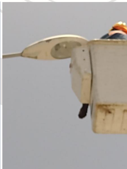
CASA DE LA CULTURA, SE INSTALA LAMPARA TIPO SOL DE 1,000 WTS QUE FUE ENTREGADA POR LA DIRECCIÓN DE LA CASA DE LA CULTURA
