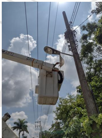
COL. CENTRO, 4 OTE Y CENTAURO. REHABILITACIÓN DE FOTOCELDA.
