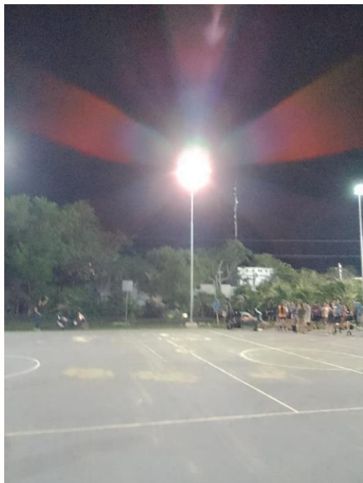
COL. YAAX TULUM, AV SATELITE, UNIDAD DEPORTIVA, ETC. REALIZACIÓN DE RECORRIDO DE ENCENDIDO DE SECTORES MANUALES
