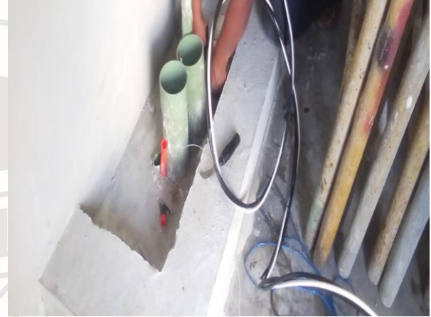
MANUEL ANTONIO AY, RECONEXIÓN DE LINEA SUBTERRANEA QUE SE ENCONTRO SULFATADO
