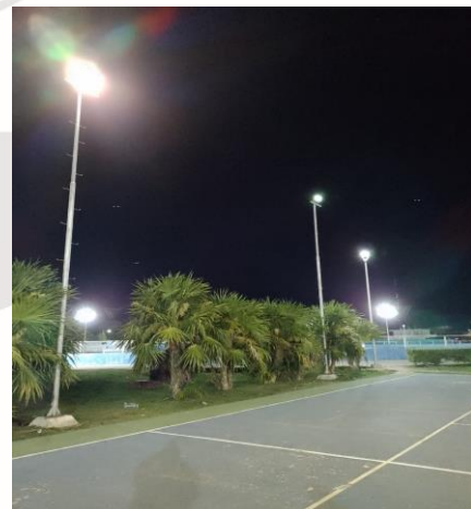
CICLOVIA, AV. SATELITE SUR, PARQUE 2 AGUAS, UNIDAD DEPORTIVA, AV 5 SUR, ETC, REALIZACIÓN DE RECORRIDO DE ENCENDIDO DE SECTORES MANUALES
