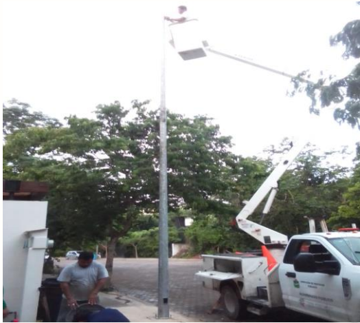
CICLOVIA, AV. SATELITE, PARQUE DOS AGUAS, UNIDAD DEPORTIVA, HOLISTICA, ETC, REALIZACIÓN DE RECORRIDO DE ENCENDIDO DE SECTORES MANUALES
