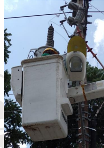
FRANCISCO HU MAY, ETC. REHABILITACIÓN DE LAMPARA Y BALASTRO TIPO (AM-175)
