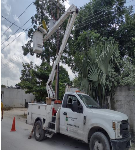
COL. YAAX TULUM, AV SATELITE, UNIDAD DEPORTIVA, ETC, ETC. REALIZACIÓN DE RECORRIDO DE ENCENDIDO DE SECTORES MANUALES
