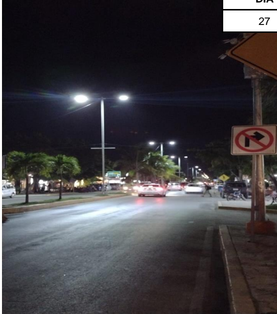
CICLOVIA, AV. SATELITE, PARQUE DOS AGUAS, UNIDAD DEPORTIVA, HOLISTICA, ETC. REALIZACIÓN DE RECORRIDO DE ENCENDIDO DE SECTORES MANUALES.
