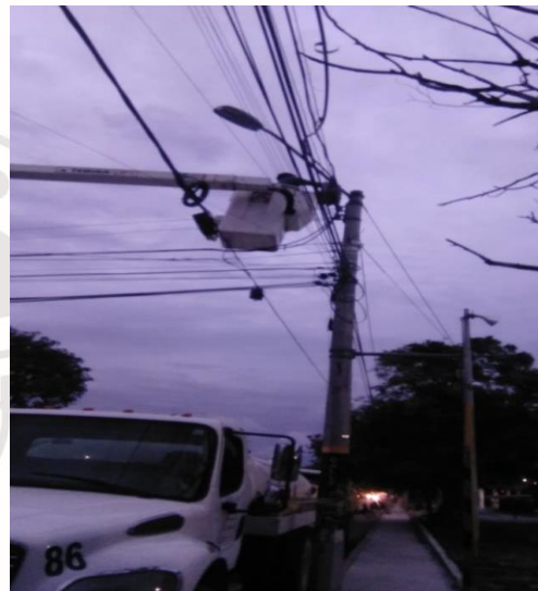
C. SIAN KA'AN / CALLE GOLONDRINAS Y GALLINOLAS, SE REHABILITA FOTOCELDA POR AVERIACIÓN
