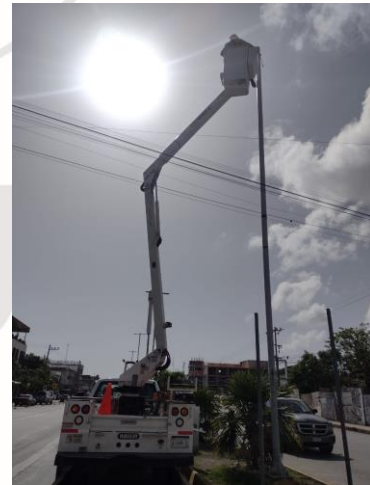
CICLOVIA, AV. SATELITE, PARQUE DOS AGUAS, UNIDAD DEPORTIVA, HOLISTICA, ETC. REALIZACIÓN DE RECORRIDO DE ENCENDIDO DE SECTORES MANUALES
