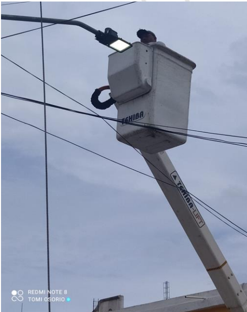
COL. TUMBENKA / AV. 18 Y CALLE FAISAN, SE AJUSTAN LAMPARA TIPO LED QUE SE ENCONTRABAN MAL COLOCADAS.
