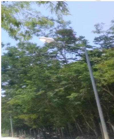
COL CENTRO Y SAGITARIO. REHABILITACIÓN DE LAMPARA TIPO LED
