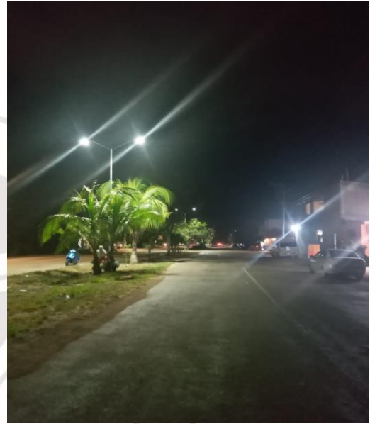
COL. TUBEM KA, AV. LA SELVA / C. 30 Y 18, REHABILITACIÓN DE LAMPARA OV-15 OBSOLETAS, CON LAMPARA LED DE 100 WATTS
