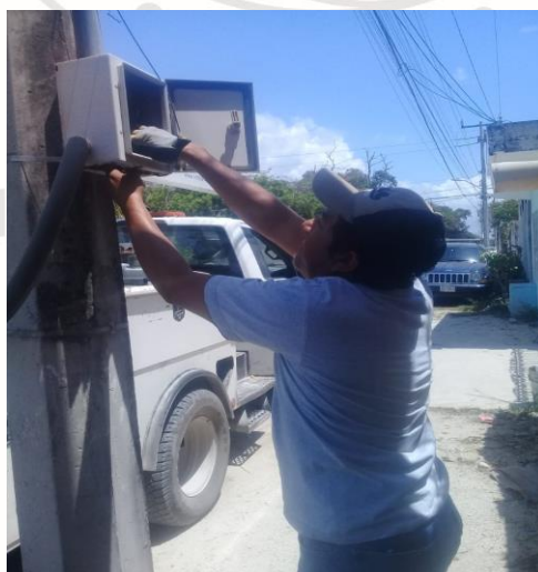
CICLOVIA , AV. SATELITE SUR, PARQUE 2 AGUAS, UNIDAD DEPORTIVA, AV 5 SUR, ETC, REALIZACIÓN DE RECORRIDO DE ENCENDIDO DE SECTORES MANUALES
