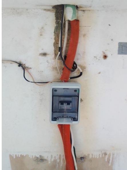
COL. VILLAS, YAAX TULUM / CICLOVIA Y 5TA AV, ETC, REALIZACIÓN DE RECORRIDO DE APAGADO DE SECTORES MANUALES
