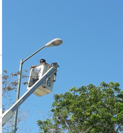
YAAX TULUM, C. MARGARITAS / AV. LA SELVA, REHABILITACIÓN DE LAMPARA OV-15 (TIPO AM-175W Y BALASTRO AM-175W)
