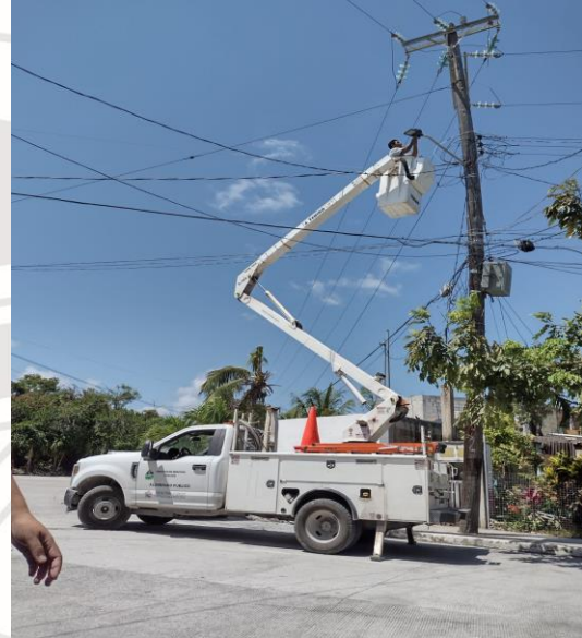
COL. CENTRO, OLISTICA, AV. SATELITE, CICLOVIA, ETC, REALIZACIÓN DE RECORRIDO DE ENCENDIDO DE SECTORES MANUALES
