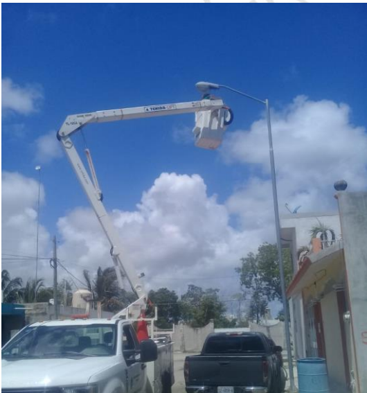
TUBEN KA, AV. 18 / FAISAN Y AV. LA SELVA, SE REHABILITA LAMPARA OV-15 OBSOLETAS, CON LAMPARA LED DE 100 WATTS
