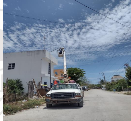
COL. TUMBEN KA / AV. LA SELVA, REHABILITACIÓN DE LAMPARA OV-15 OBSOLETAS, CON LAMPARA LED DE 100 WATTS
