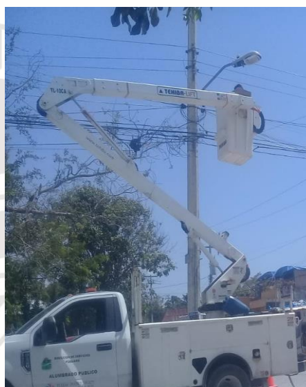
YAXCHE , REHABILITACIÓN DE LAMPARA OV-15 (TIPO AM-175W Y BALASTRO AM-175W)
