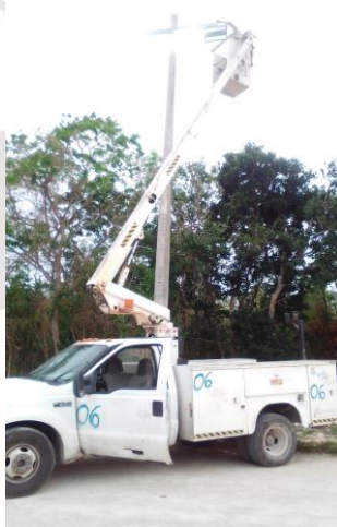
COL. TUMBENKA, SE REHABILITA LAMPARA Y BALASTRO OV-15 (TIPO AM-175W Y BALASTRO AM-175W)
