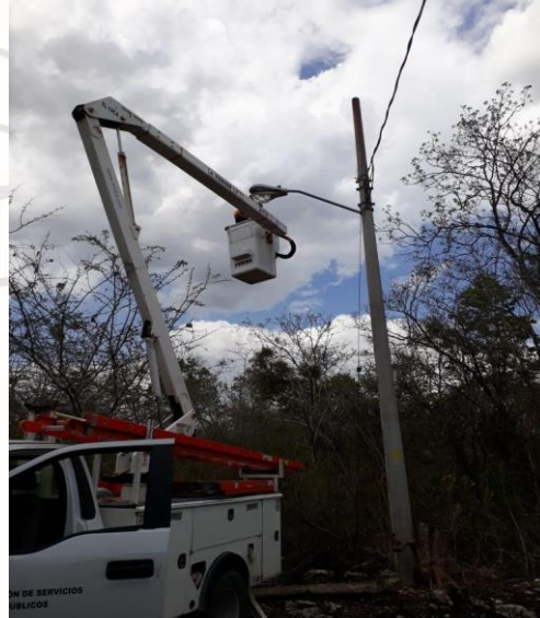
MANUEL ANTONIO AY, REHABILITACIÓN DE LAMPARA OV-15 (TIPO AM-175W Y BALASTRO AM-175W)
