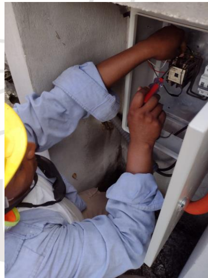
COL. VILLAS, YAX TULUM / CICLOVIA Y 5TA AV, ETC, REALIZACIÓN DE RECORRIDO DE ENCENDIDO DE SECTORES MANUALES
