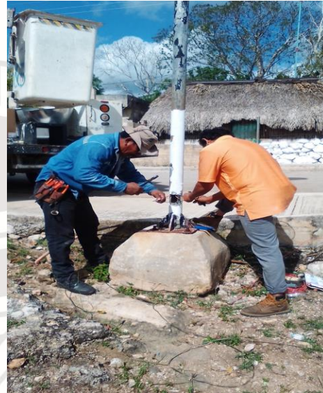
SAN SILVERIO, RECONEXION DE LINEAS SUBTERRANEAS QUE PROVOCAN CORTO CIRCUITO.
