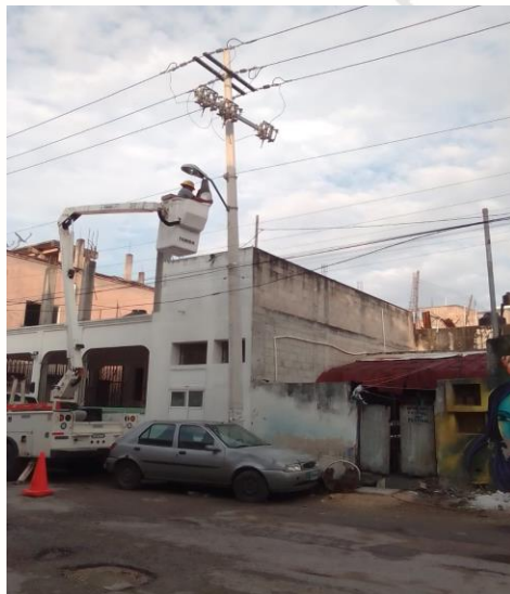
AV. KUKUL CAN / VENADO, CAMBIO DE BRAZO DE LAMPARA DAÑADO.
