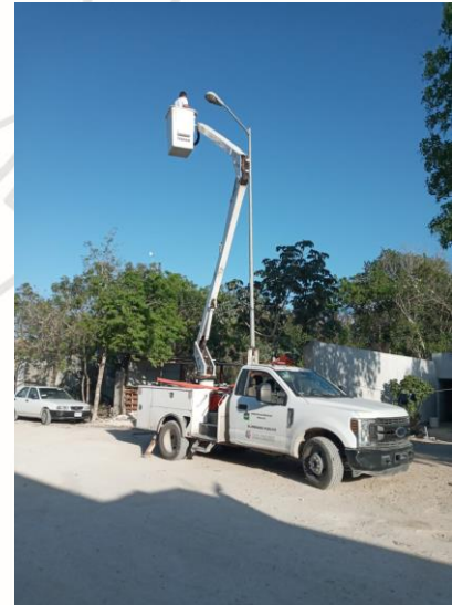
FRACC. LAS PALMA, REHABILITACIÓN DE LAMPARA OV-15 (TIPO AM-175W Y BALASTRO AM-175W)
