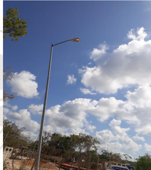
COL. VILLAS, YAAX TULUM / CICLOVIA Y 5TA AV, ETC , REALIZACIÓN DE RECORRIDO DE APAGADO DE SECTORES MANUALES
