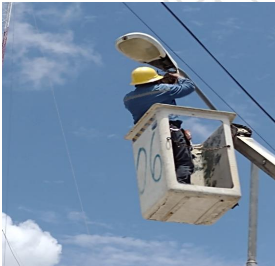
COL. TUMBEN KA / CALLE 20 Y AV. 2, REHABILITACIÓN DE LAMPARA OV-15 OBSOLETAS, CON LAMPARA LED DE 100 WATTS
