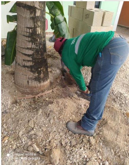
COL. YAAX TULUM, CALLE CLAVEL / AZUCENA Y MARGARITA, RECONEXIÓN DE 40 MTS DE CABLE 2+1 QUE SE ENCONTRABAN FISURADOS CIRCUITO.
