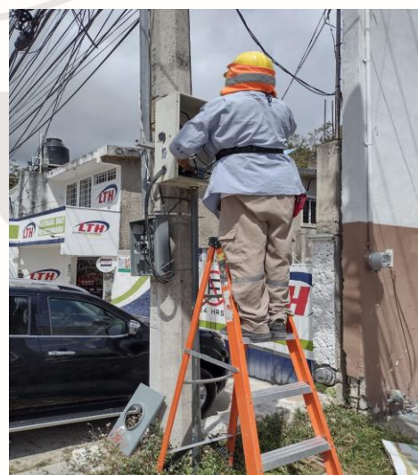
COL. CENTRO, AV TULUM (COMEX), SE INSTALO CONTACTOR QUE SE ENCONTRABA QUEMADO (CONTACTOR NUEVO)
