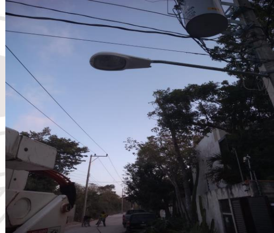
COL. VELETA, HAVEN, AV SATELITE, UNIDAD DEPORTIVA, ETC, REALIZACIÓN DE RECORRIDO DE ENCENDIDO DE SECTORES MANUALES
