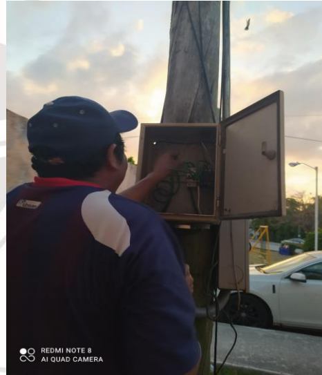
CICLOVIA, AV. SATELITE, PARQUE DOS AGUAS, UNIDAD DEPORTIVA, HOLISTICA, ETC, REALIZACIÓN DE RECORRIDO DE APAGADO DE SECTORES MANUALES
