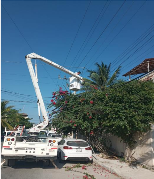
COL. CENTRO, C. SAGITARIO / OSIRIS, RECONEXION DE LINEAS AEREAS DAÑADAS
