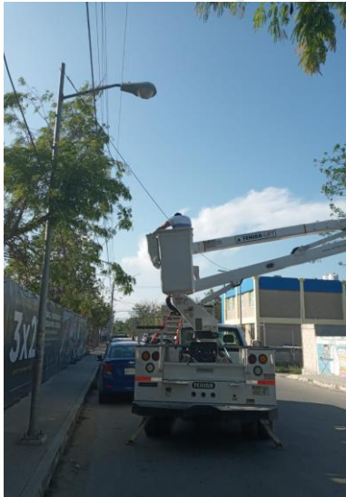
COL. CENTRO, OLISTICA, AV. SATELITE, CICLOVIA, ETC, REALIZACIÓN DE RECORRIDO DE ENCENDIDO DE SECTORES MANUALES
