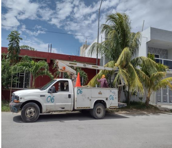
COL. TUMBEN KA, REHABILITACIÓN DE LAMPARA OV-15 OBSOLETAS, CON LAMPARA LED DE 100 WATTS
