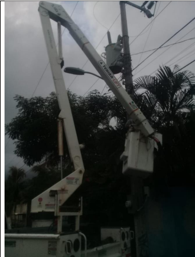
Cambio de lampara completa col. Tumbe Ka, Faisán.
