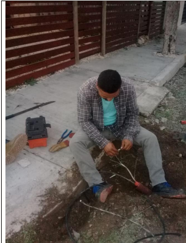
Sondeo de cableado colonia Tumben Ka calle Tumen -Ha con Av. 18.
