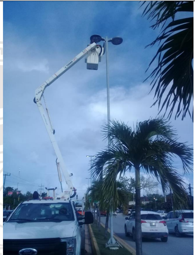
Rehabilitación de luminarias en la Av. Tulum de la calle Acuario hasta la calle Osiris.
