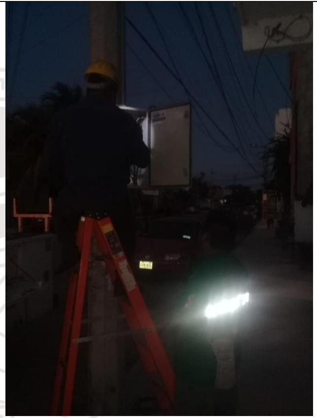
Se enciende luminarias de manera manual.
