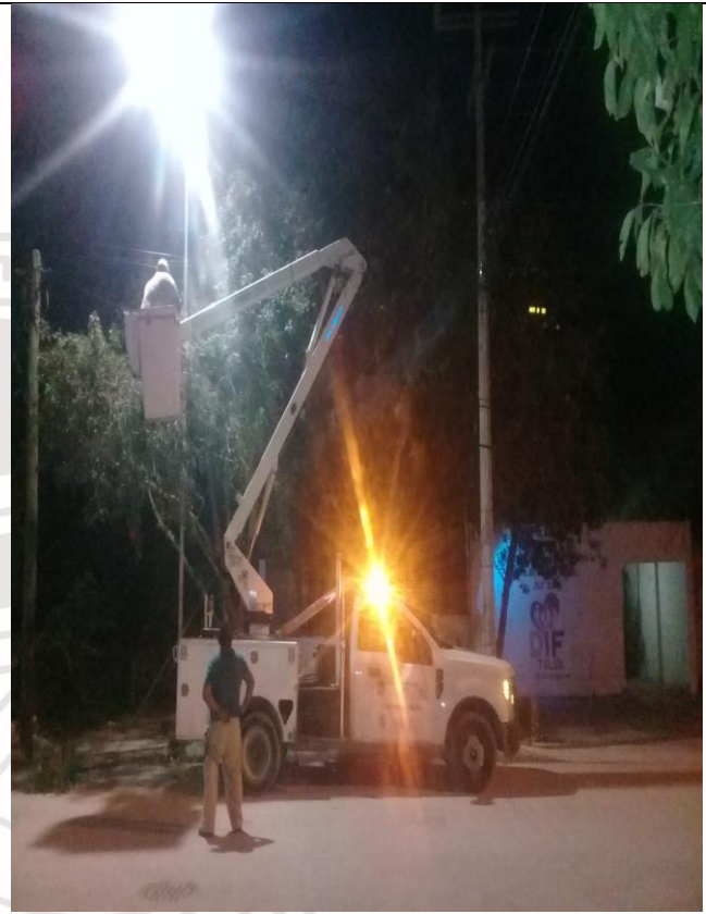
Cambio de luminaria tipo led dañada a Ov15 colonia Tumben Ka calle Tumen -Ha con Av. 18.
