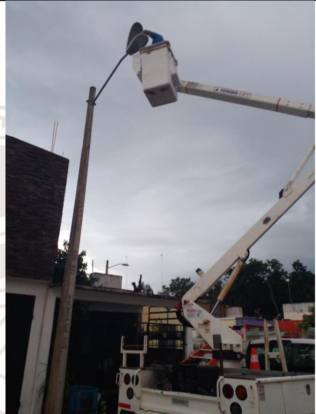
Se rehabilita luminaria apagada de noche, se cambia foco y balastro, en Palmas con calle y agua.
