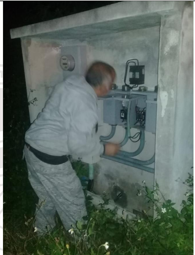
Se detecto sector en corto circuito en líneas, Ejido C.7 / Selva y Sun Yax Che.
