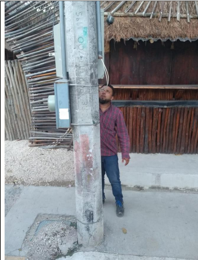
Se apagan luminarias de manera manual.
