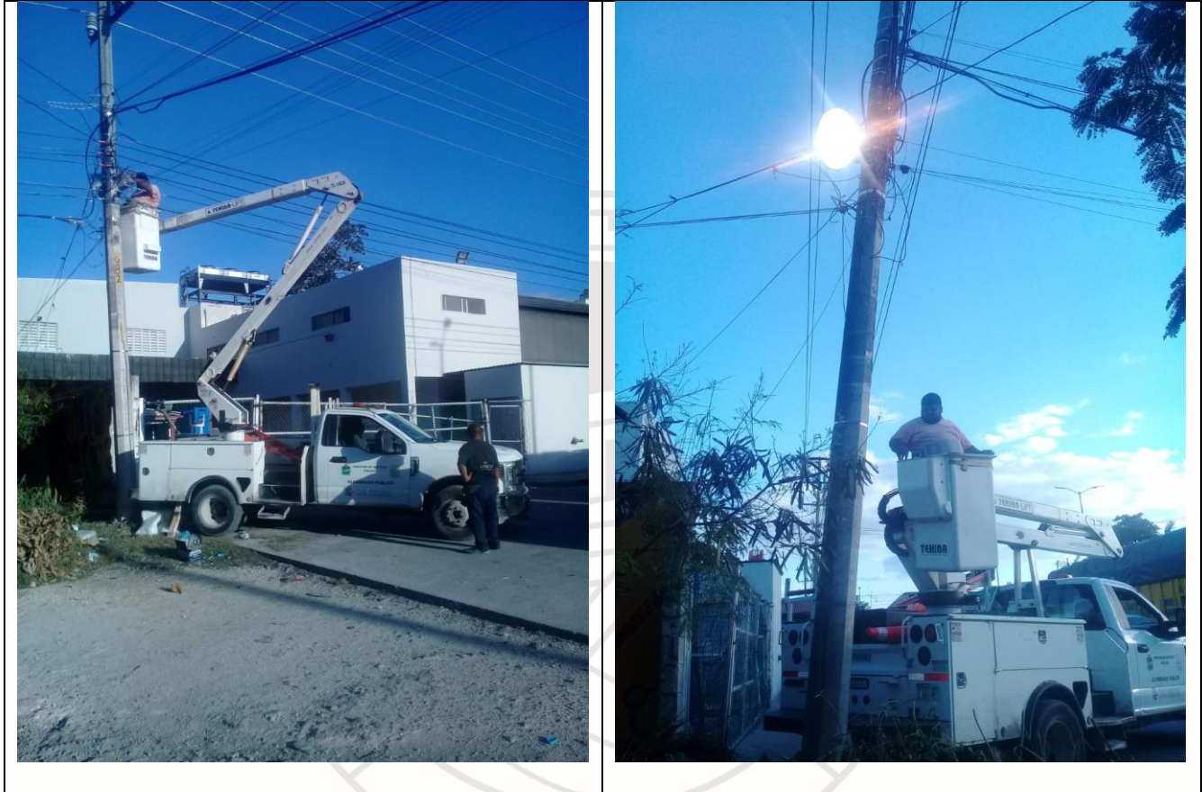
Rehabilitación de luminaria tipo sol de 1000w en colonia Villas Tulum, Av. Coba y Av. Tulum.
