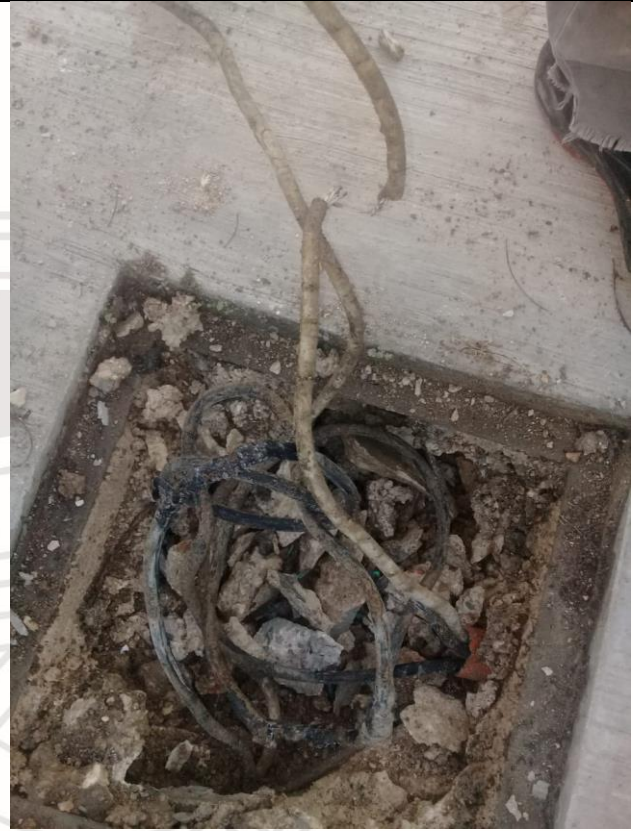
Trabajos realizados en las calles del DIF colonia Tumben Ka calle Tumen -Ha con Av. 18 y calle Chem.
