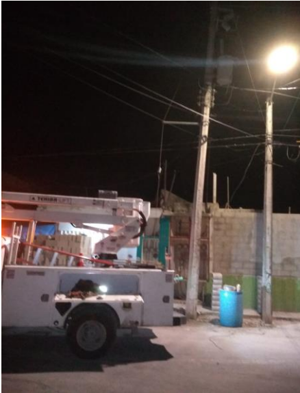
COL. HURACANES, PARQUE Y CANCHA MULTIPLES, REALIZACIÓN DE RECORRIDO DE ENCENDIDO DE SECTORES MANUALES
