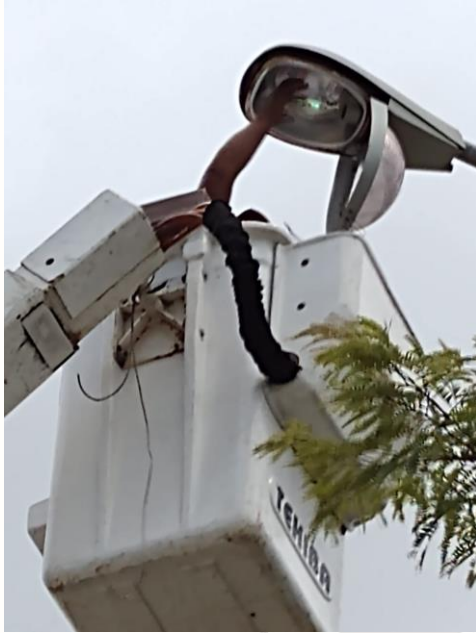
COL. YAAX TULUM, REHABILITACIÓN DE LAMPARA Y SE REUTILIZO CARCAZA TIPO OV-15 (SE CAMBIO FOCOS TIPO AM-175W, Y BALASTROS AM-175W)
