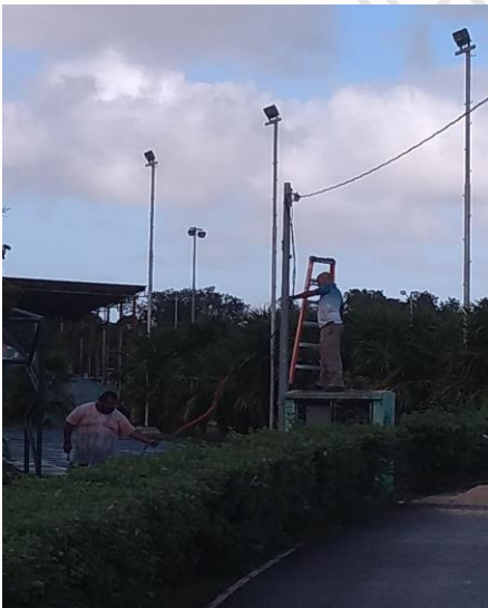
COL. CENTRO, C. INTERIOR (UNIDAD DEPORTIVA), REUBICACIÓN DE LINEAS DE PARQUE VEHICULAR
