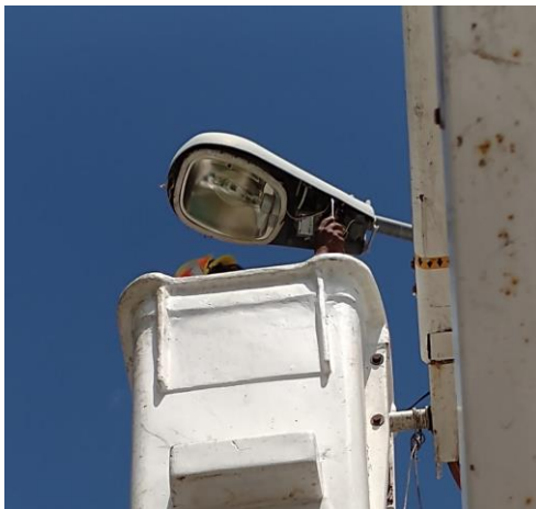
COL. TUMBENKA, CALLE 17 / 12 Y 16, REHABILITACIÓN DE LAMPARAS TIPO OV-15 (SE CAMBIARON FOCOS TIPO AM-175, Y BALASTROS AM-175)
