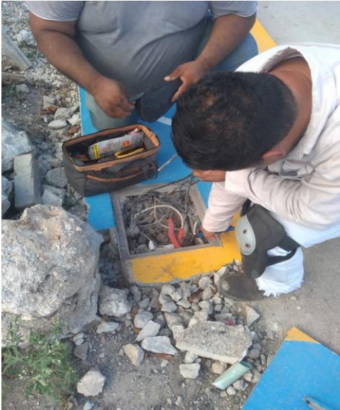
CICLOVIA, PARQUE DOS AGUAS, HOLISTICA, TUMBENKA, REALIZACIÓN DE RECORRIDO DE ENCENDIDO DE SECTORES MANUALES
