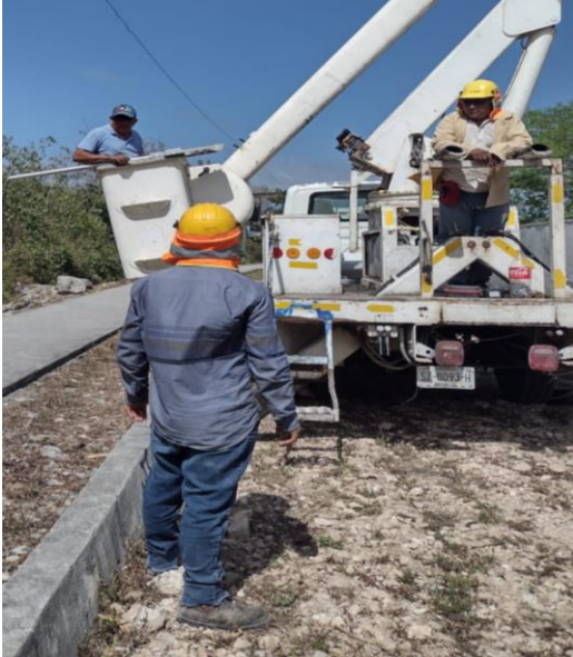
COL. YAAX TULUM, VILLAS TULUM, CICLOVIA, AV 5, REALIZACIÓN DE RECORRIDO DE ENCENDIDO DE SECTORES MANUALES
