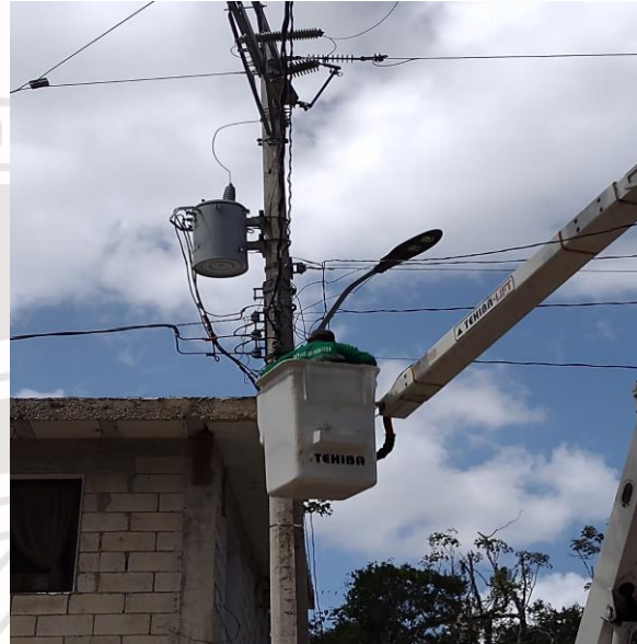
CICLOVIA, SATELITE SUR, PARQUE 2 AGUAS, UNIDAD DEPORTIVA Y 5 AV SUR, REALIZACIÓN DE RECORRIDO DE ENCENDIDO DE SECTORES MANUALES
