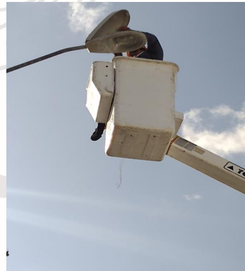
MANUEL ANTONIO AY , REHABILITACIÓN DE LAMPARAS (SE CAMBIARON FOCOS TIPO AM-175W Y BALASTROS AM-175W)
