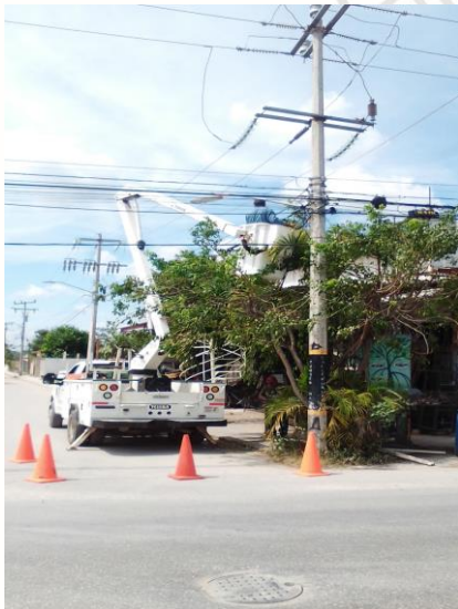
COL. CENTRO, CALLE SOL PONIENTE / ALFA SUR, REHABILITACIÓN DE LAMPARAS TIPO LED CON CAMBIO DE FOTOCELSDAS DE 220V
