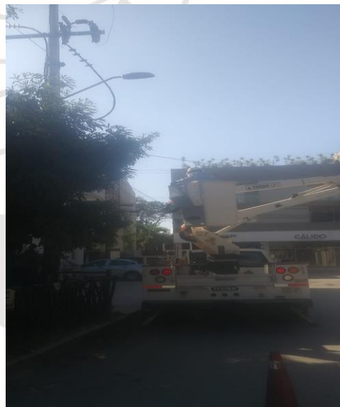
COL. TUMBENKA, CALLE FAISAN / BEEK, REHABILITACIÓN DE LAMPARA OV-15, (TIPO AM-175W Y BALASTRO TIPO AM-175W)
