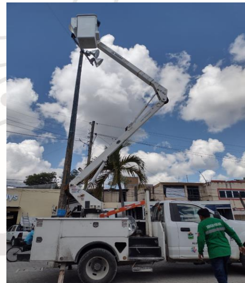
COL. CENTRO, CALLE SOL / CENTAURO Y ORIÓN, REALIZACIÓN DE RECORRIDO DE ENCENDIDO DE SECTORES MANUALES
