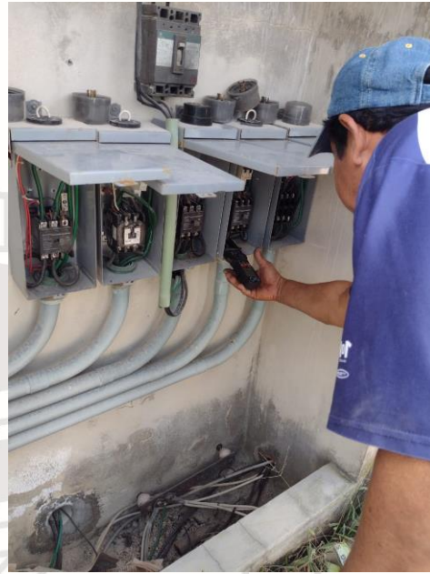
COL. VILLAS TULUM, YAAX TULUM, CICLOVIA, AV 5, ETC. REALIZACIÓN DE RECORRIDO DE ENCENDIDO DE SECTORES MANUALES
