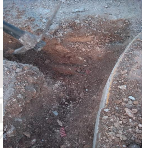
COL. KUKULKAN, CALLE O'KOOT, RECONEXIÓN DE LINEAS SUBTERRANEAS Y SE DETECTO CABLE CORTADO EN EL CENTRO DE CARGA
