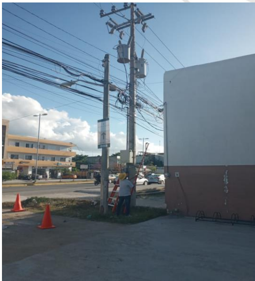
COL. CENTRO, AV TULUM / SATELITE Y COBA, SE REALIZA LA REHABILITACIÓN DE LA CUCHILLA DE TRANSFORMADOR Y DEJÁNDOLO EN MODO MANUAL (SE REUTILIZA UN FUSIBLE DE 3KVA)
