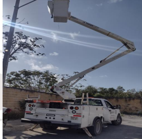
FRACCIONAMIENTO LAS PALMAS , REHABILITACIÓN DE LAMPARAS TIPO OV-15 (SE CAMBIARON FOCOS TIPO AM-175W, Y BALASTROS AM-175W)
