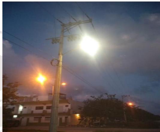
COL. CENTRO, AV 5 SUR, REALIZACIÓN DE RECORRIDO DE ENCENDIDO DE SECTORES MANUALES
