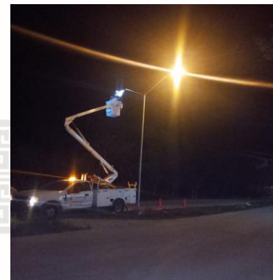
COL. YAXTULUM, VILLAS TULUM, COCLOVIA, AV 5, REALIZACIÓN DE RECORRIDO DE ENCENDIDO DE SECTORES MANUALES
