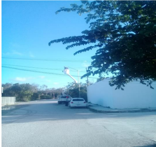
CICLOVIA, AV SATELITE, PARQUE DOS AGUAS, UNIDAD DEPORTIVA, AV 5 SUR, ETC. REALIZACIÓN DE RECORRIDO DE ENCENDIDO DE SECTORES MANUALES
