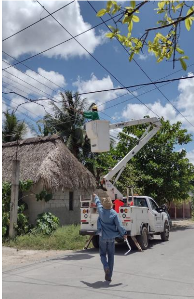
COBA, AV PRINCIPAL, RECONECCIÓN DE LINEAS, SE ENCENTRO UN CORTO
