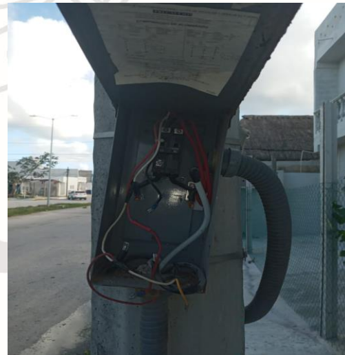
COL. TUMBENKA, CALLE 18 / AV 2 Y 19, SE REHABILITAN LAMPARAS (TIPO AM-175W, BALASTROS AM-175W)
