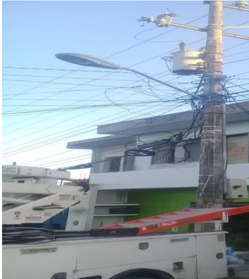
MACARIO GOMEZ , REHABILITACIÓN DE LAMPARAS OV-15 (FOCOS TIPO AM-175W, BALASTROS TIPO AM-175W)
