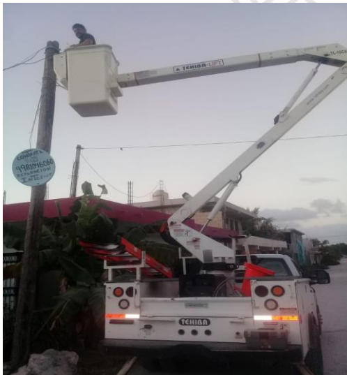
AKUMAL , SE REHABILITA LAMPARA TIPO AM-1,000W TIPO SOL Y SE TENSIONAN 60 MTS DE CABLE CALIBRE 6 (CAPACITADOR 1,000 NATS REUTILIZADO)
