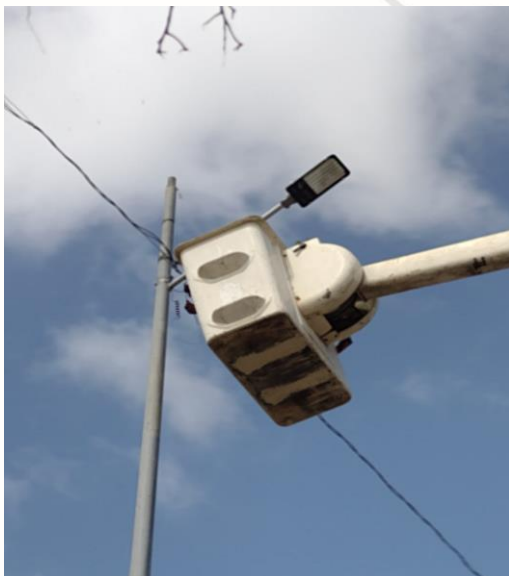
CICLOVIA, SATELITE SUR, UNIDAD DEPORTIVA, PARQUE DOS AGUAS, AV 5, REALIZACIÓN DE RECORRIDO DE ENCENDIDO DE SECTORES MANUALES
