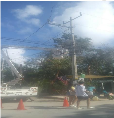
COL. EJIDO, CALLE SIAN KAAN / 11, REALIZACIÓN DE RECORRIDO DE ENCENDIDO DE SECTORES MANUALES. SE REINSTALO CONTACTOR QUE SE ENCONTRABA QUEMADO
