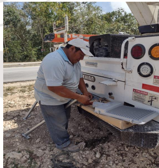
COL. YAAX TULUM, VILLAS TULUM, CICLOVIA, AV 5, REALIZACIÓN DE RECORRIDO DE ENCENDIDO DE SECTORES MANUALES)
