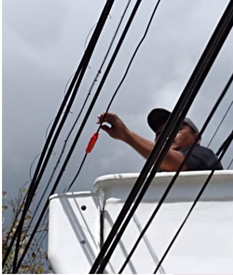
COL. MAYA PAX, CALLE JUPITER / 2 OTE Y LEXIU, SE INSTALA SEPARADOR EN LINEAS
