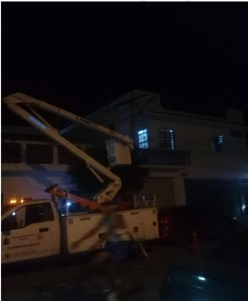
COL. VILLAS TULUM, YAX TULUM, CICLOVIA Y AV 5, REALIZACIÓN DE RECORRIDO DE ENCENDIDO DE SECTORES MANUALES
