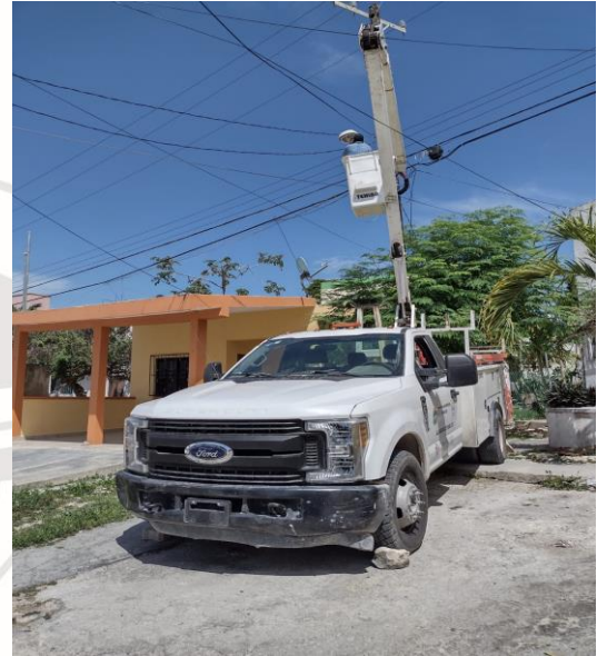
CHEMUYIL , SE RETIRA POSTE APUNTO DE CAER.
