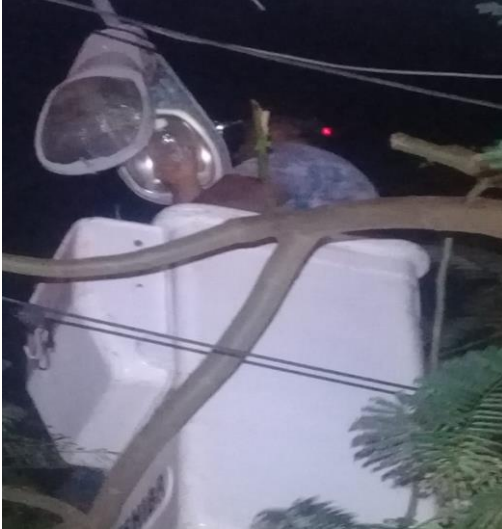
COL. TUMBENKA, CALLE 27 / 14 Y 25, SE REHABILITA LAMPARAS (TIPO AM-175W, BALASTROS AM-175W)
