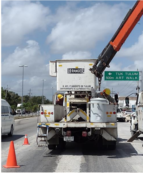
COL. CENTRO, CACETA PÚBLICA (SALIDA A PLAYA DEL CARMEN), SE INSTALO TRANSFORMADOR CON APOYO DE CFE
