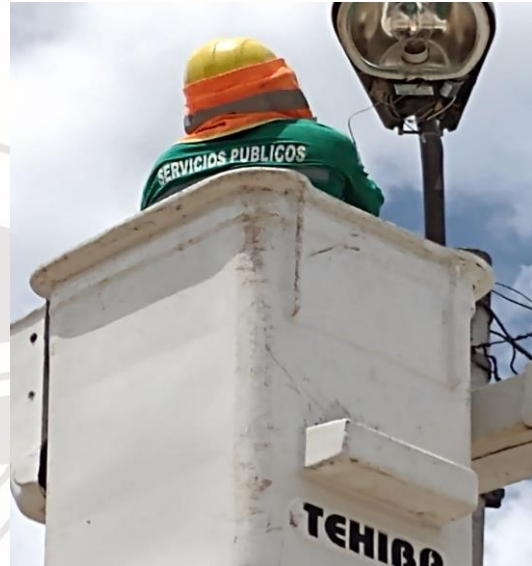
COL. EJIDO, AV 1, SE REHABILITO LAMPARAS TIPO OV-15 (TIPO VS-100W Y BALASTROS TIPO VS-100W)
