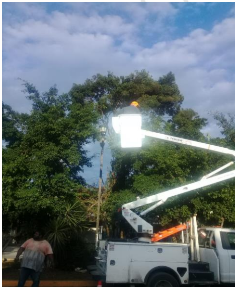
COL. TUMBENKA, CALLE CHEN / NAL, REHABILITACIÓN DE LAMPARA (TIPO OV-15 INTEGRANDO DE FOCO AM-175W Y BALASTRO AM-175W)
