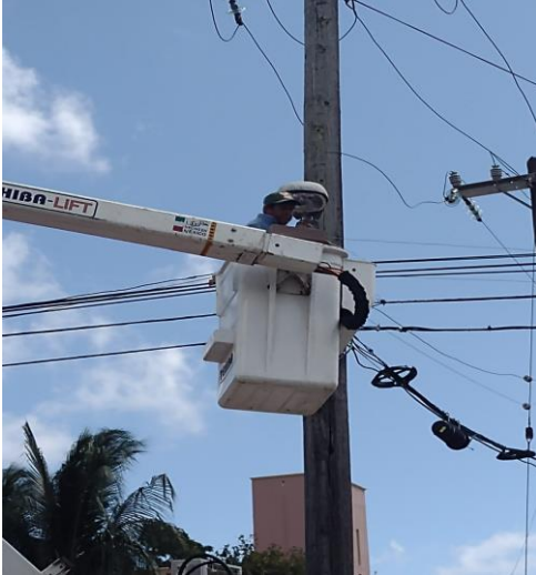
CHEMUYIL, REHABILITACIÓN DE LAMPARAS TIPO OV-15 (AM-175W, BALASTROS TIPO AM-175W) (BASE DE FOTOCELDA Y FOTOCELDA 220V)
