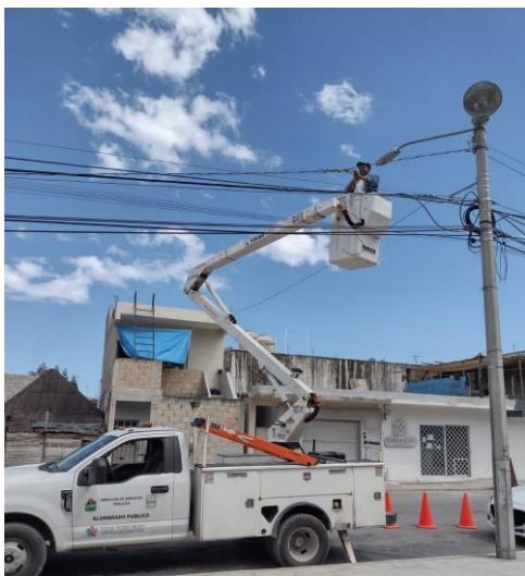
COL. YAX TULUM, CALLE AZUCENA / TULIPAN Y ALCARRAZ, (LAMPARA) SE CAMBIO UN FOCO AM-175W QUEMADO Y BALASTRO AM-175W.
