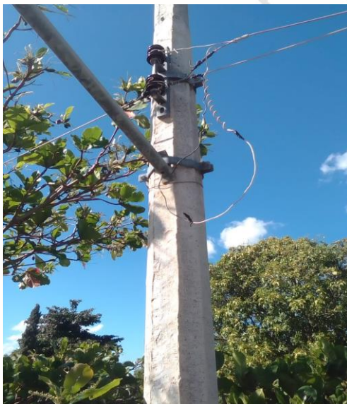
COL. CENTRO, CALLE MERCURIO / AURORA SUR, RECONEXIÓN DE LINEA PRINCIPAL, SE ENCONTRÓ LA LINEA SULFATADA.
