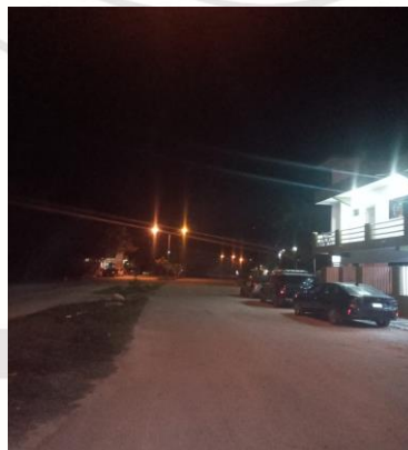
COL. TUMBENKA, CALLE YODZONOT / TEPESCUINTLE, REHABILITACIÓN LAMPARAS (2 VS-100W, AM-175W Y BALASTRO AM-175W) (SE REUTILIZAN FOCOS DE 100 NATS)
