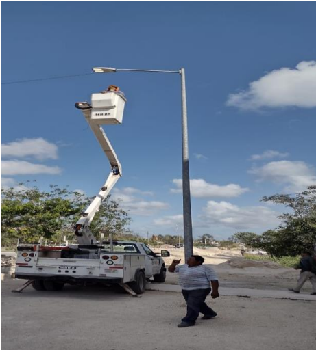
XUL-KA, AV LA SELVA / AV 10 NTE, REHABILITACIÓN DE FOTOCELDA 220, YA QUE SE ENCONTRO UNA LAMPARA ENCENDIDA.
