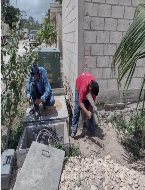
COL. TUMBENKA, AV YODZONOT / 29 Y 27, SE REALIZA LA REHABILITACIÓN DE LA LINEAS SUBTERRANEAS
