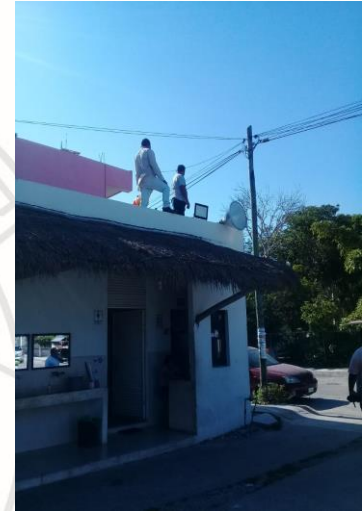
COL. CENTRO, CALLE VENUS OTE / ALFA SUR, SE REALIZA RECONEXIÓN DE LINEAS PARA ACTIVAR REFLECTORES EN EL ESTACIONAMIENTO DEL MERCADO
