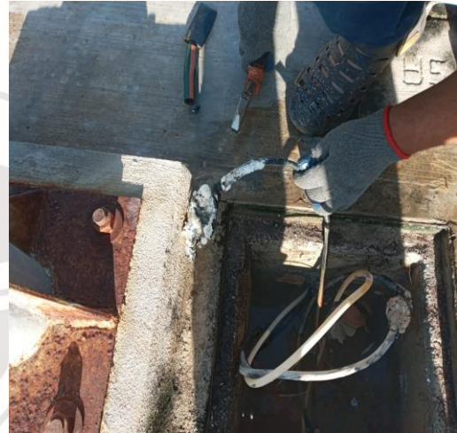
COL. TUMBENKA, AV 31 / AV 33, SE DETECTAN REGISTROS ELECTRICOS INUNDADOS POR FUGA DE AGUA, SE PROCEDE A DESAGUAR
