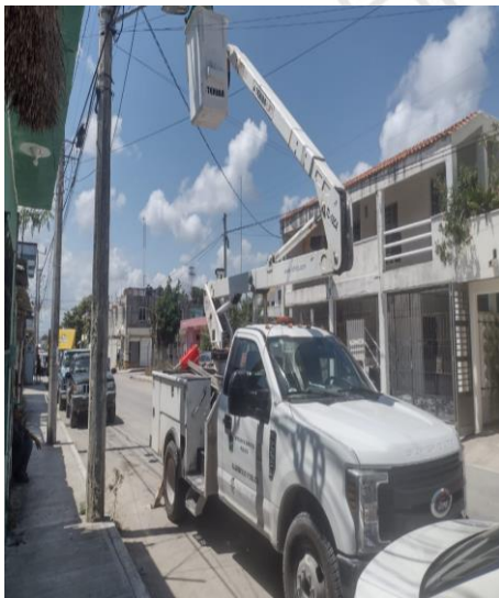
COL. TUMBENKA, CALLE 23 / 20 Y 12, REHABILITACIÓN DE LAMPARAS TIPO AM-175W, Y BALASTROS AM-175W, UNA FOTOCELDA 220V
