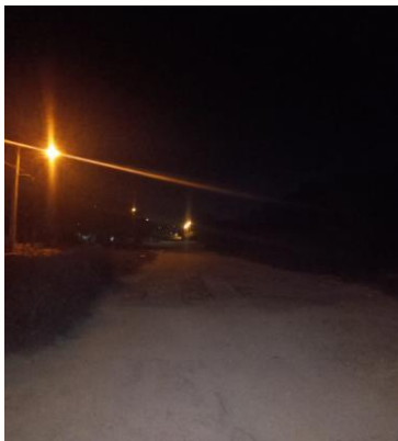
COL. TUMBENKA, AV 31 / AV 33, SE EMPALMAN LINEAS SULFATADAS
