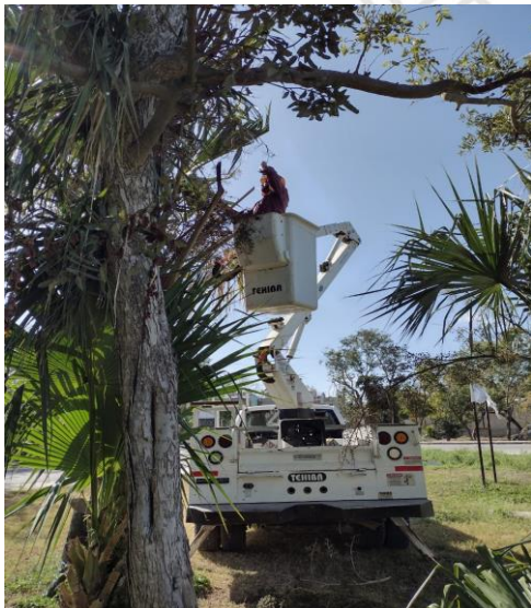
COL. CENTRO, CALLE POLAR / PONIENTE Y CANCER , REHABILITACIÓN DE REFLECTOR TIPO AM-1,000W
