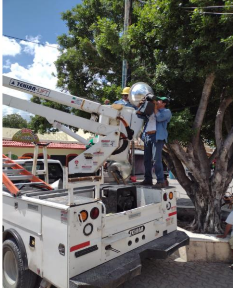
MANUEL ANTONIO AV. SE CAMBIO FOCOS DE REFLECTOR AM-175W, UNA FOTOCELDA
