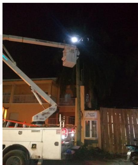
COL. YAX TULUM, VILLAS, CICLOVIA, REALIZACIÓN DE RECORRIDO DE ENCENDIDO DE SECTORES MANUALES
