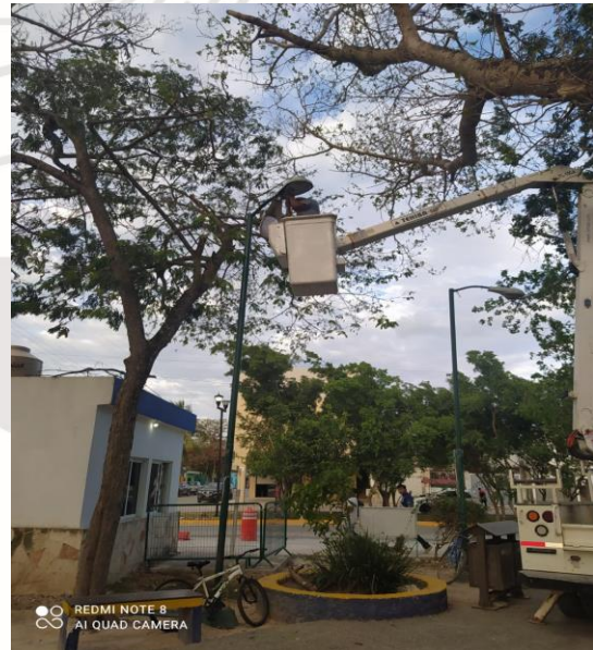
(CROC) AV. SATELITE / VENUS, REHABILITACIÓN DE LAMPARAS OV-15 (SE CAMBIO FOCOS TIPO AM-175W, Y BALASTROS AM-175W) (CARCASAS REUTILIZADAS)
