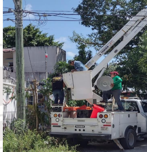
COL. CENTRO, CALLE OSIRIS / 2 OTE Y 4, REHABILITACIÓN DE LAMPARA TIPO OV-15 (AM-175W Y BALASTRO AM-175W)
