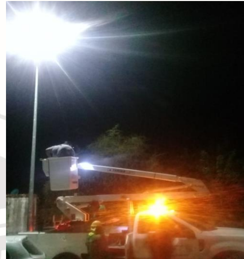
COL. YAX TULUM, CALLE TULIPAN / MARGARITA Y CLAVEL, REHABILITACIÓN DE LAMPARAS TIPO OV-15 (AM-250W, BALASTROS TIPO AM-250W)
