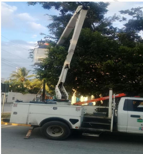
COL. CENTRO, CALLE SATELITE NTE / POLAR Y SAGITARIO, REALIZACIÓN DE RECORRIDO DE ENCENDIDO DE SECTORES MANUALES CON INTEGRACIÓN DE FOTOCELDA NUEVA 220V
