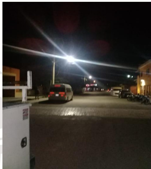
COL. EJIDO, CALLE TAURO / XCARET Y AV. KUKULKAN, REALIZACIÓN DE RECORRIDO DE ENCENDIDO DE SECTORES MANUALES CON RECONEXIÓN DE LINEAS EN LAMPARAS
