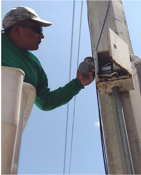
COL. EJIDO, AV KUKULKAN / TEJON Y VENADO, MANTENIMIENTO DE FOTOCELDA NUEVA 220V
