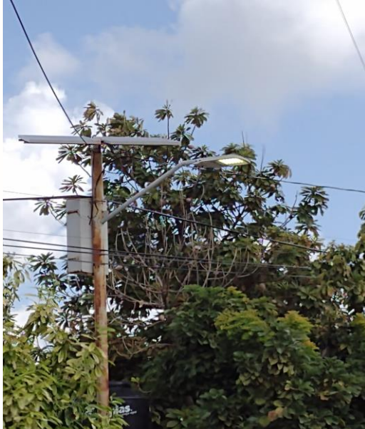
COL. YAX TULUM, VILLAS, CICLOVIA, REALIZACIÓN DE RECORRIDO DE ENCENDIDO DE SECTORES MANUALES
