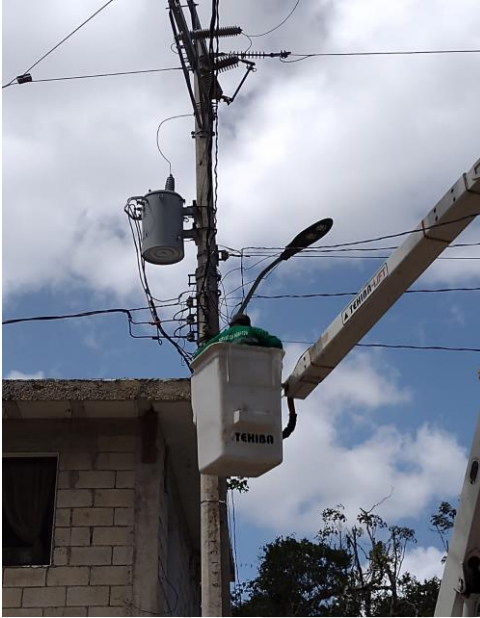
AKUMAL , REHABILITACIÓN DE LAMPARA (FOCO TIPO AM-1,000W, BALASTROS TIPO AM-1,000W Y UNA FOCOCELDA 220) (20 MTS DE CABLE CALIBRE 6)
