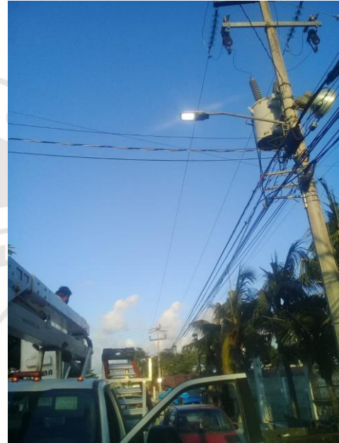
COL. YAX TULUM, CALLE MARGARITA / ORQUIDEA, REHABILITACIÓN DE LUMINARIAS OV-15 (FOCOS AM-175W Y BALASTRO AM-175W)
