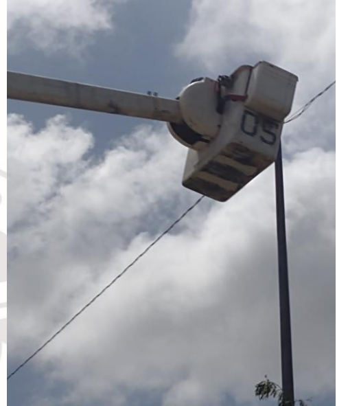
COL. FRACCIONAMIENTO LAS PALMAS, AV. LA SELVA / 10 NTE Y 10 BIS, SE REHABILITO LAMPARAS TIPO OWNY (TIPO AM-250W Y BALASTROS TIPO AM-250W)
