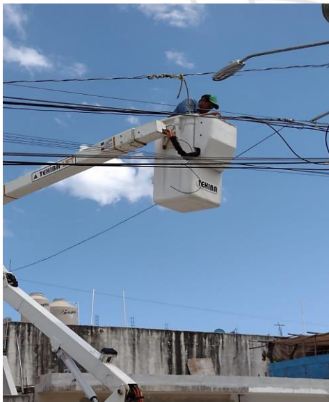
CALLE MERCURIO / CALLE GEMINIS Y LIBRA SUR, RECONECCIÓN DE LINEAS SULFATADAS EN LAMPARA TIPO LED DE 73WAERAS POR CORTO CIRCUITO.
